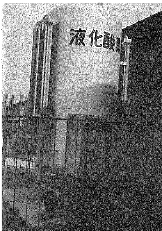
(写真-12-1) 貯槽の不同沈下
