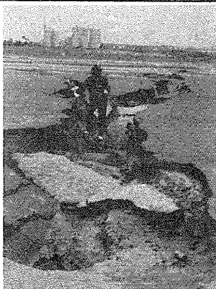
▲ 秋田港飯島地先5万トン岸壁付近道路 （秋田市）
