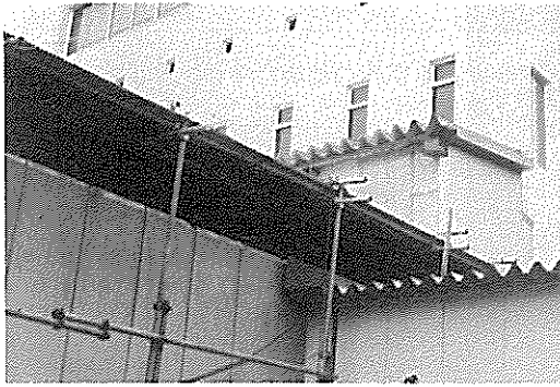
▲ 広告塔の落下により屋根がくずれ、 トタン屋根が仮設してある。 (秋田市大町2丁目 本金デパート4階、 S造平屋催事場)
