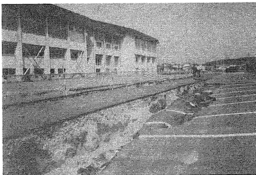
液状化によりグラウンドに亀裂及び沈下が生じている。 舗装の下層路盤の下は砂質地盤である。（県立男鹿工業高校）
