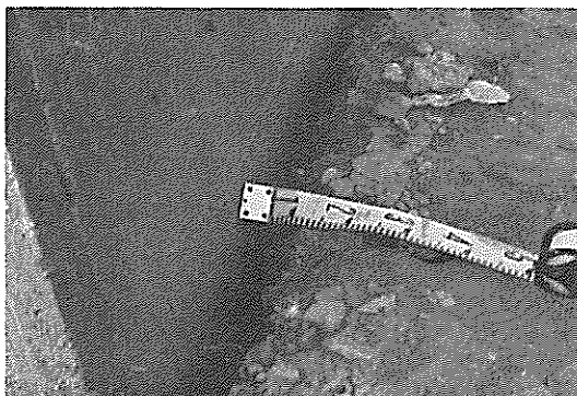
(木間塚橋) 橋脚根入部分 (全周に揺れによる空隙あり)
