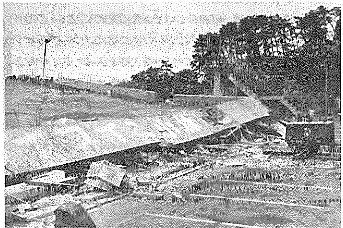
東伊豆町稲取 倒壊したドライブイン小林
