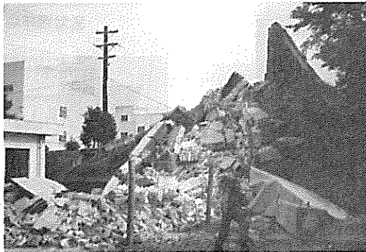
宮城刑務所(古城) レンガ塀崩壊
