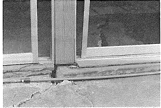
東伊豆町稲取 民家の中を通った断層
