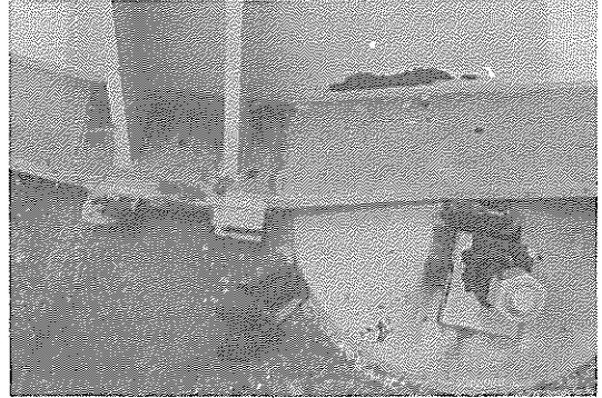
Pg (F) 下流側 (錦桜橋) 移動量約45cm (沓移動制限装置) 破壊脱落
