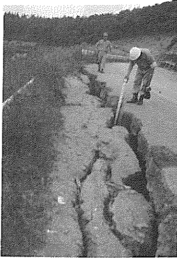
県道大郷利府線 路肩部クラック
