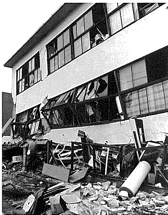
倒壊した三階建ての鉄筋コンクリートビル (仙台市卸商団地)
