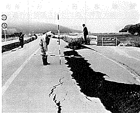
大きな亀裂被害を受けた県道北上河北線。その他の多くの道路で、同様の被害を受けた。
