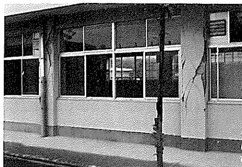
鉄筋コンクリートの柱にせん断亀裂が生じ、大きな被害を受けた県立泉高校（泉市）
