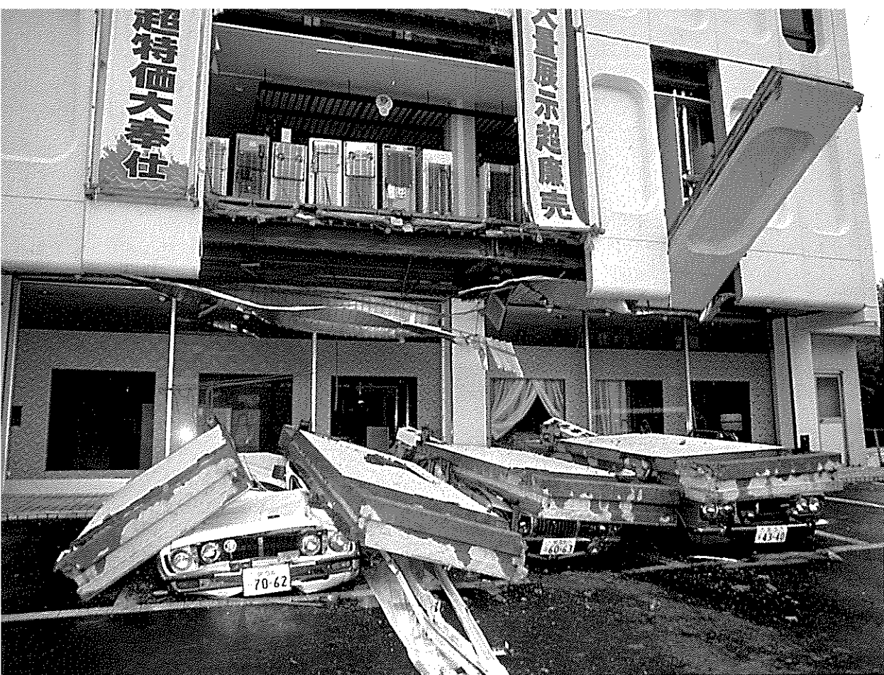
コンクリートパネルの壁がぬけ落ち、3台の車が押しつぶされた（泉市） 写真 河北新報社提供
