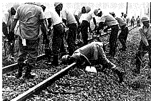
鉄道もレールなどに大きな被害を受け、復旧作業は全力をあげておこなわれた。
