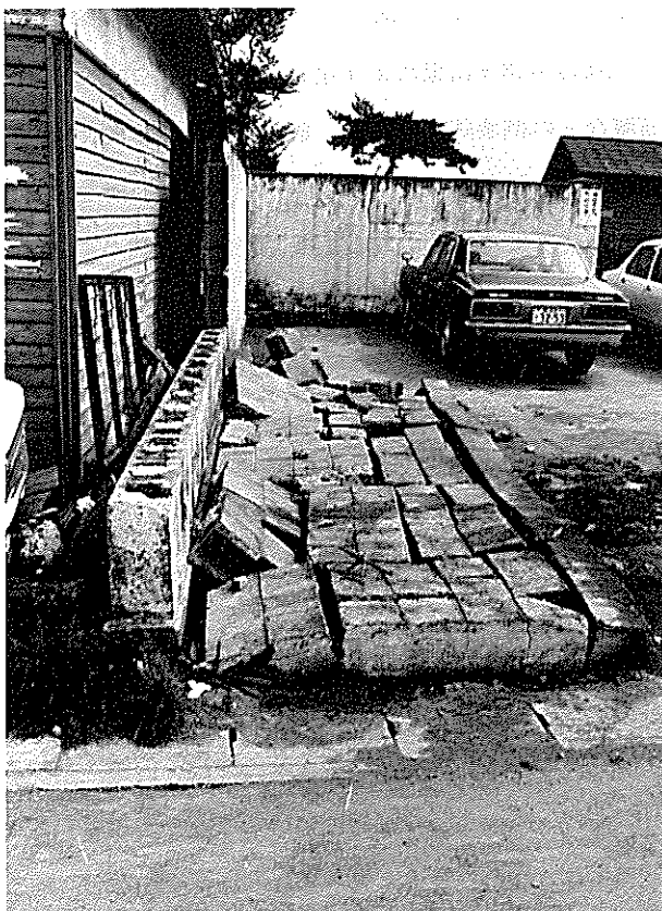
倒壊したブロック塀(仙台市)10人のいたましい犠牲者を出し、死亡原因の第1位を占めた。
