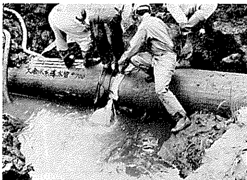
亀裂損壊した大倉ダムからの導水管
