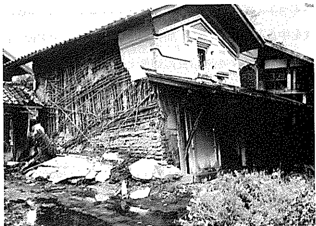
旧有壁宿本陣も土蔵の壁などが崩れ、修復不能の大きな被害を受けた。（金成町）
