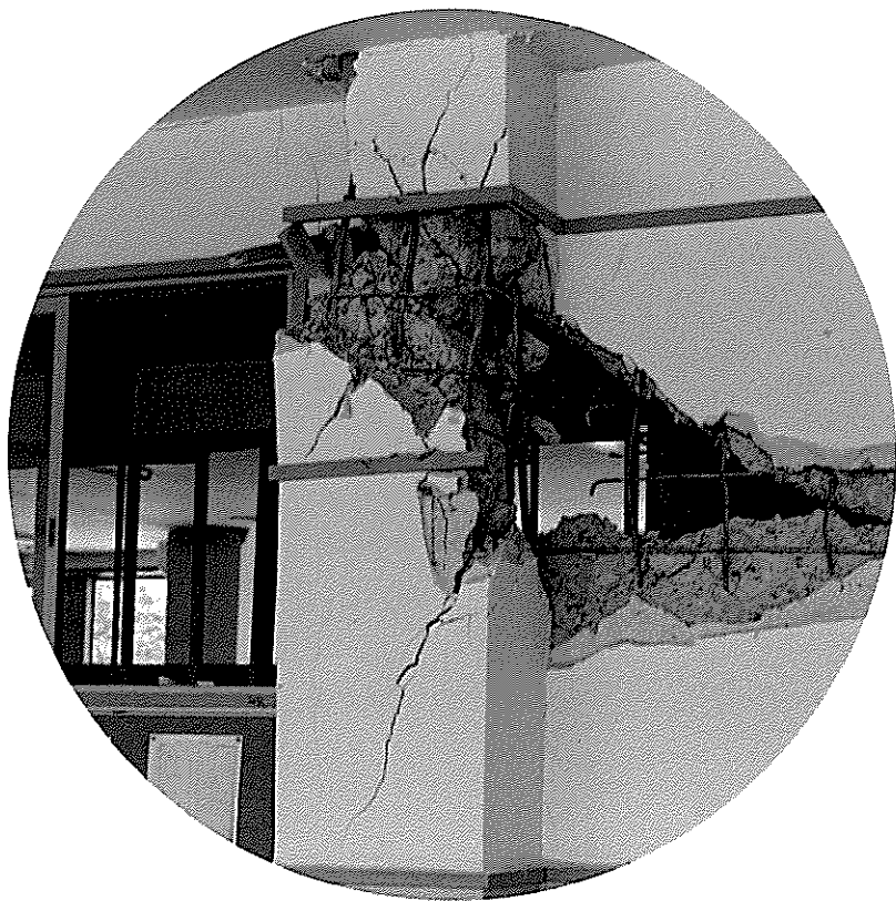
鉄筋コンクリートの柱がせん断亀裂 建物が使用不能になった県立総合衛 生学院 (仙台市)
