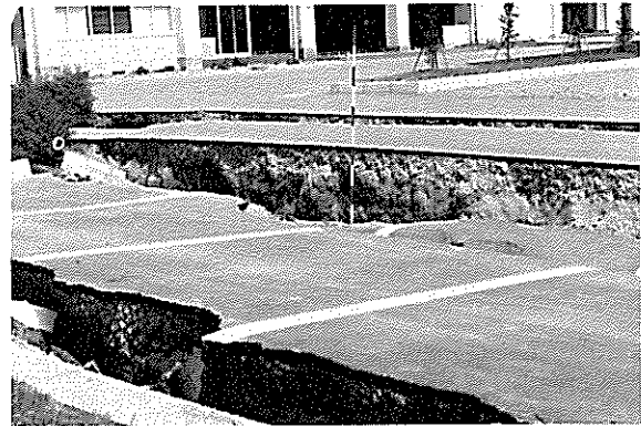
県立男鹿工業高校の校庭の亀裂
