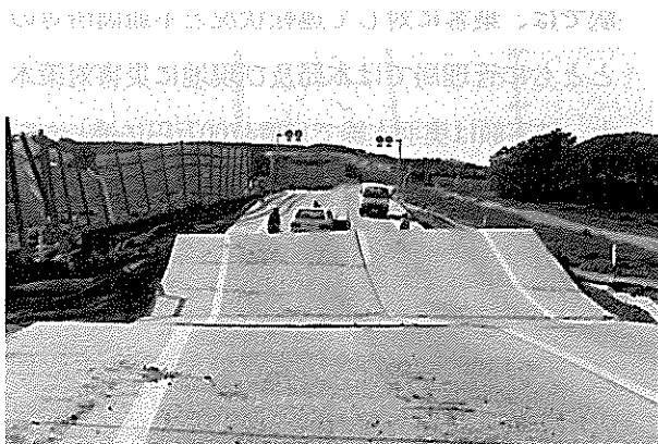
国道7号線 能代南BP、バックリング現象
