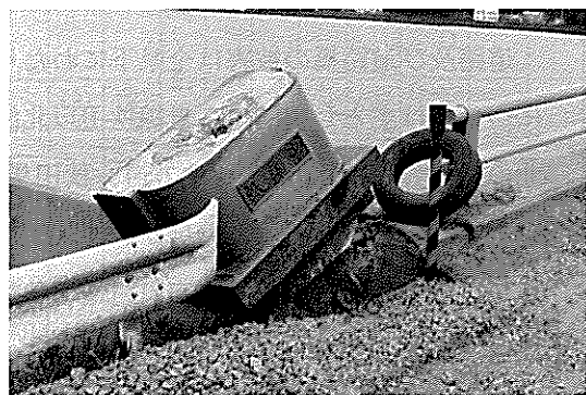
橋梁取付部の道路陥没（0.5m）により 親柱の倒壊（男鹿大橋）
