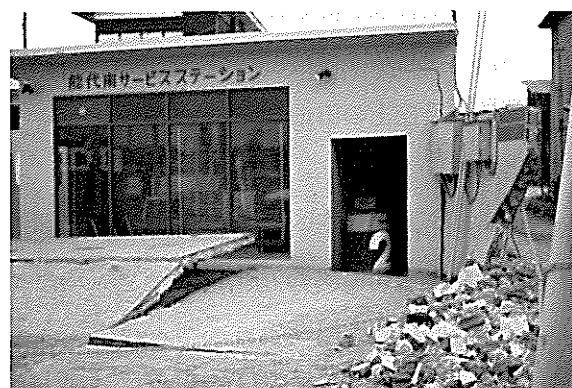
ガソリンスタンドの地下タンクの浮上により 構内コンクリート版の破損
