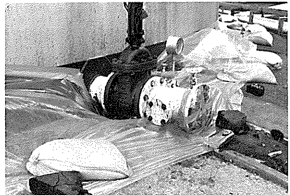
タンク沈下による受入口が基底部に接触 (沈下量250mm) (南部コンビナート地区)
