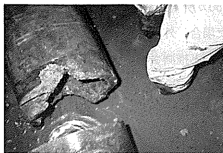
水道管（ACP）の切損
