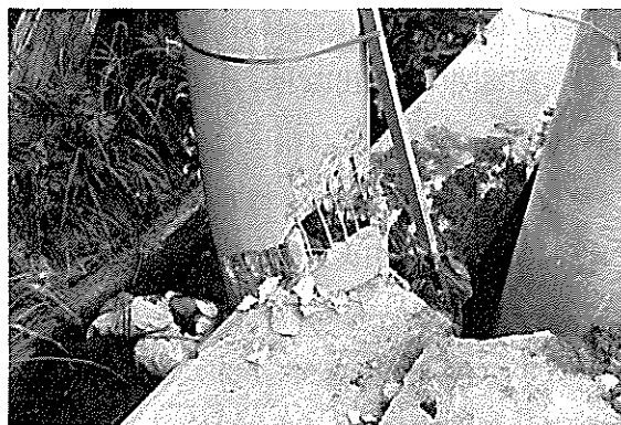
コンクリート製電柱の破損
