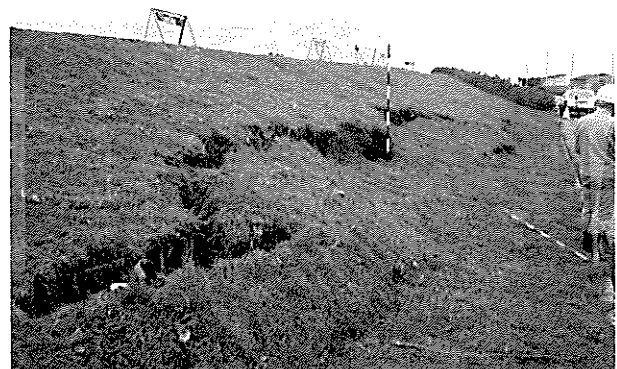
雄物川右岸堤防クラックずり落ち
