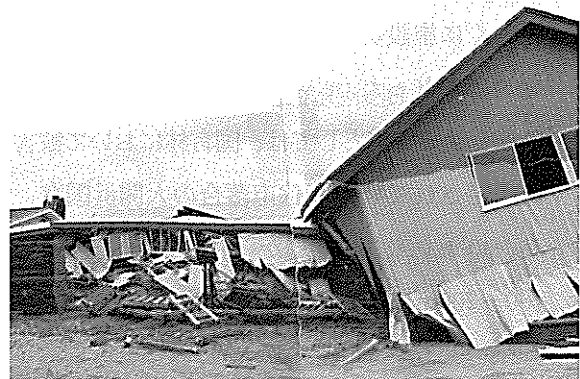
製材所、製材工場の倒壊、製品の散乱
