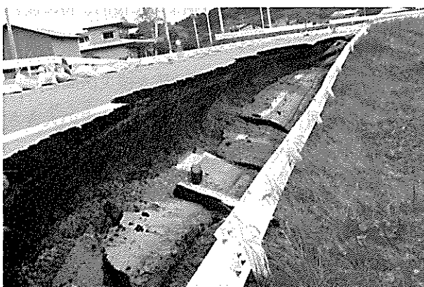
路肩部の亀裂欠壊（能代市内）
