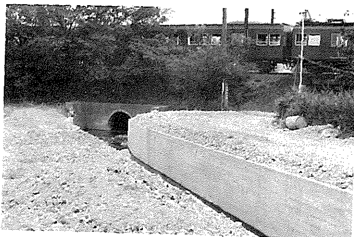
昭和42年7月の内水洪水の直接 の原因となった池田市八王寺川の 暗渠（池田市城南町付近）
