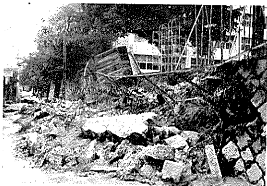
7月豪雨による石垣の崩壊 (箕面市箕面)
