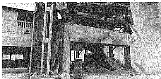
鉄骨（ラチス梁）の変形
