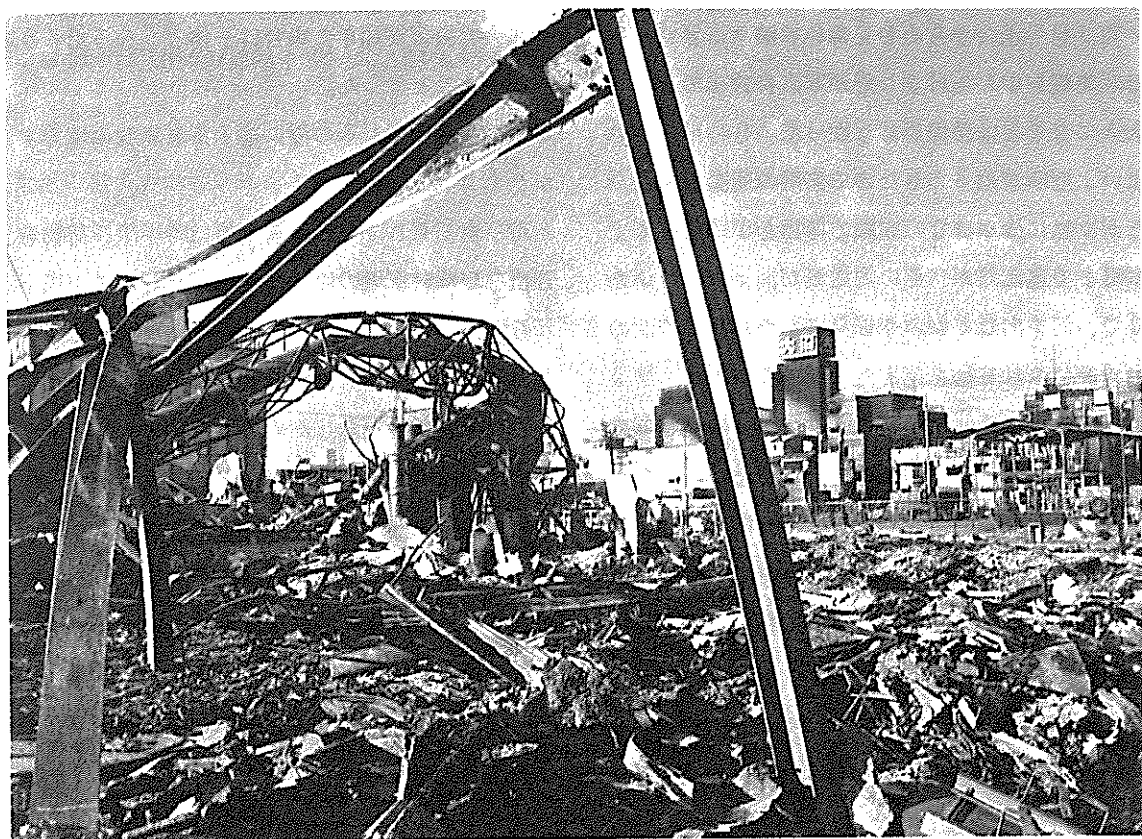
折れ曲った公衆浴場の煙突
