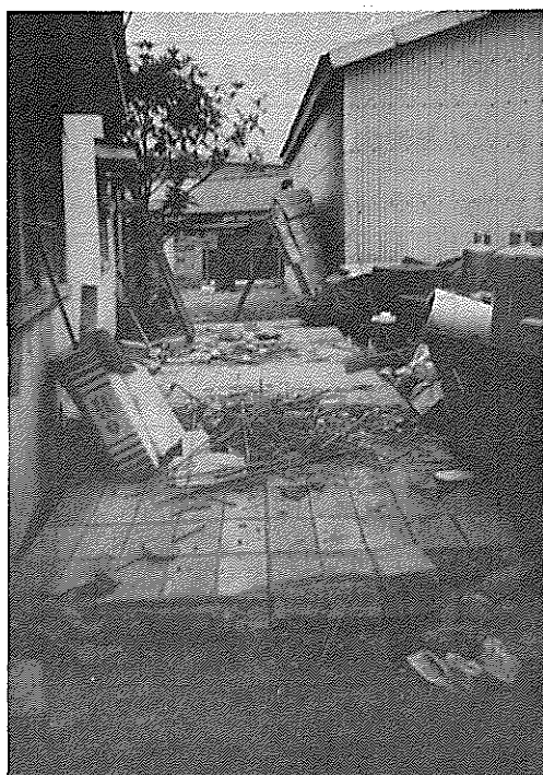
倒壊した障壁
