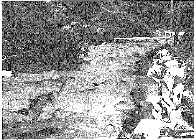
出水により洗掘された道路（角田市）
