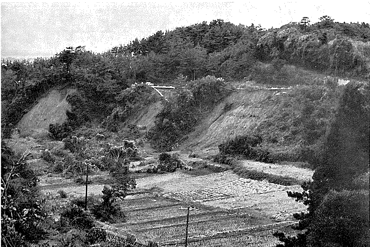
豊里多古線の路肩決壊（東庄町小南）、写真向って左へ東庄町八重穂、左へ東庄町小南方向
