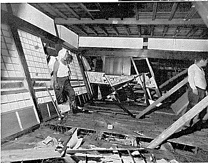
光町富下の倒壊寸前の家屋内部
