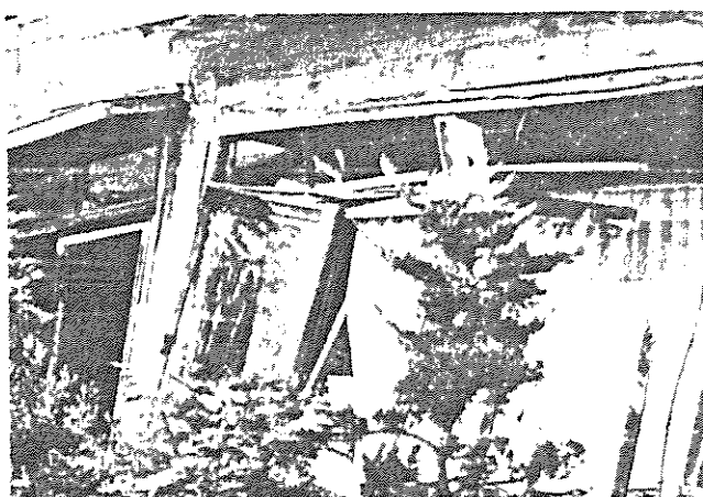
地すべりが伴った住宅全壊状況（道村）
