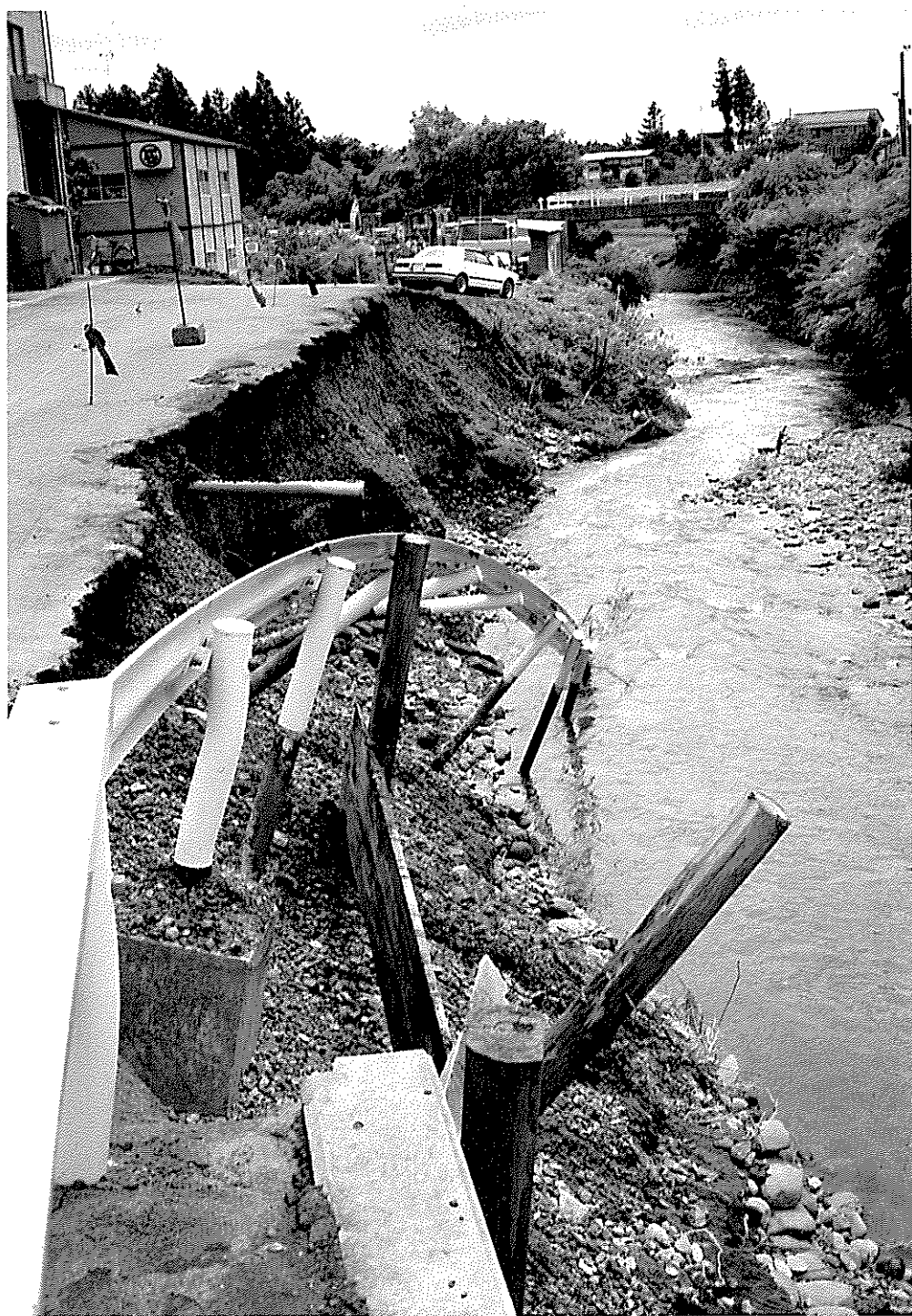
▲ 荒川の法面崩落と河岸浸食（西多賀五丁目）
