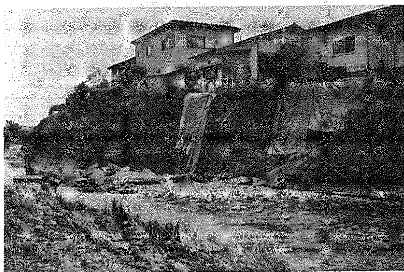
二級河川梅田川の護岸欠壊状況 (清水沼三丁目)
