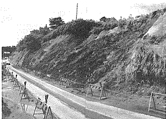
県道仙台山寺線法面崩壊状況（北赤石）
