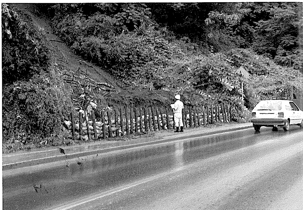
▲ 国道48号の土砂流出による仮復旧（荒巻文珠石山）
