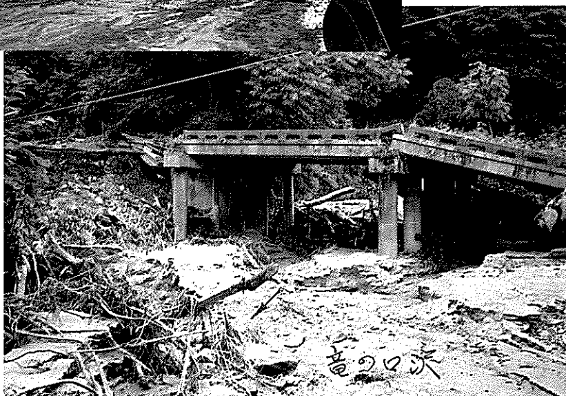
コンクリート橋の 橋げたが落ち通行 不能となる ▶ (竜の口沢)
