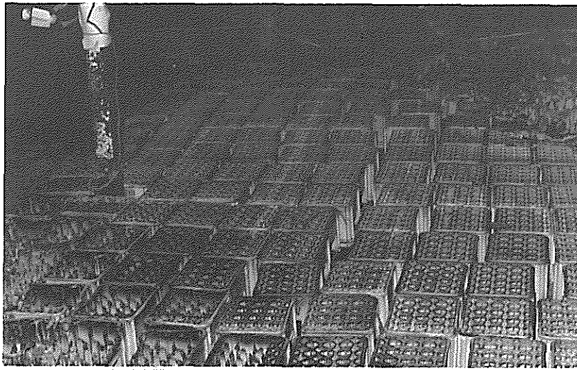
座敷の下に床構造材として並べられたビールケース
