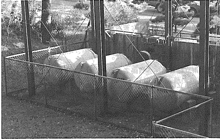
500 Kgボンベ4本のガスプラントから プロパンガスが供給されていた。
