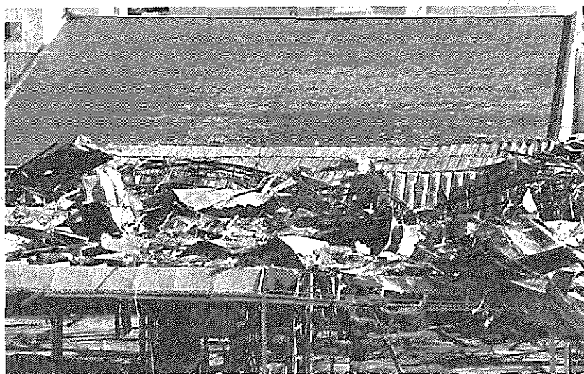
屋根上の状況——東側建物の屋根には雪状にガラスの破片が積っている。
