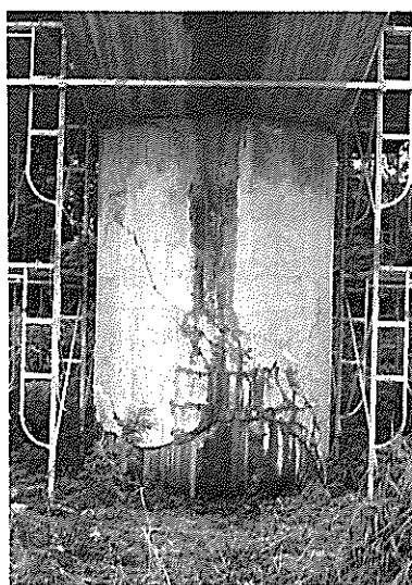
写真V-3-10 橋脚のひび割れ
