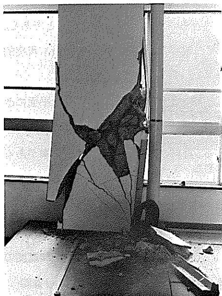
写真IV-2-5 鉄筋コンクリート柱のせん断破壊 (仙台市立図南高校1階)
