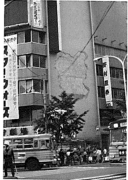
写真Ⅳ－３－４ 外装タイルの剝落
