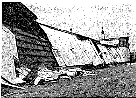
写真IV-2-9 鉄骨造ボーリング場の崩壊
