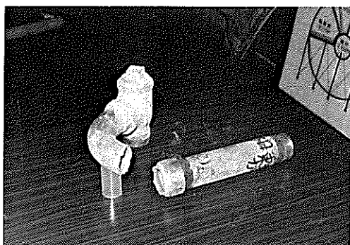
写真V-4-1 ガス導管の被害例 (φ50ねじ接合鋼管)
