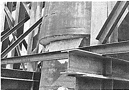
写真V-3-11 コンクリート打継目の被害
