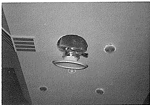
写真IV-4-9 泉市庁舎，吹出口の脱落 (鹿島建設提供)
