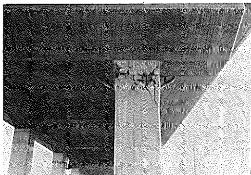
写真V-3-6 柱上端のせん断ひび割れ
