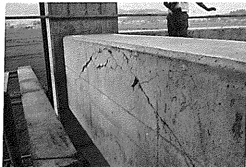
写真V-3-7 中層ばり（横ばり）のひび割れ
