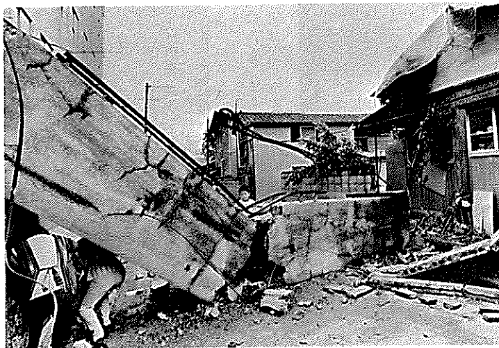
写真Ⅳ－２－７ 鉄筋コンクリート付属煙突の倒壊
