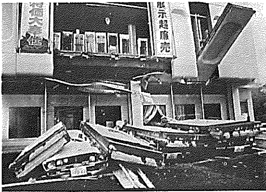
写真Ⅳ－３－３ P.C.カーテンウォールの 落下 (河北新報提供)
