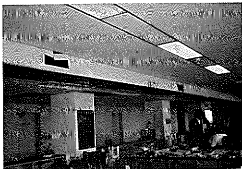
写真IV-4-14 泉市庁舎、レースウェイと 吹出口の落下 (高砂熱学工業提供)
