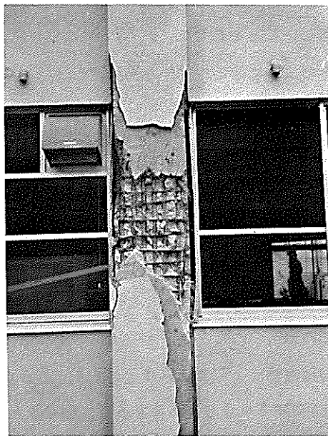
写真IV-2-6 鉄筋コンクリート柱のせん断破壊(宮城県立泉高校1階)
