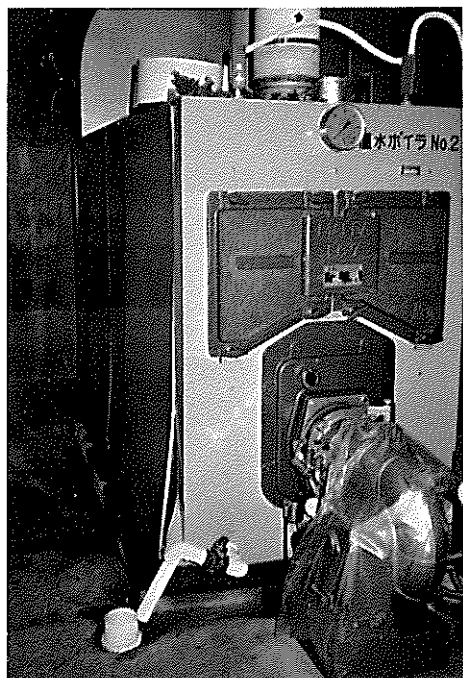
写真IV-4-3 泉市庁舎，地下1階温水セクショナルボイラー取り出し部の破損と水抜き用パイプの切断（高砂熱学工業提供）
