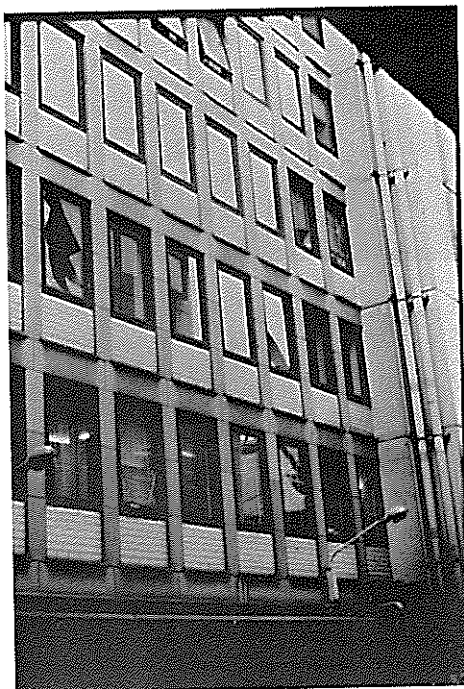
写真Ⅳ－3－2 窓ガラスの破損
