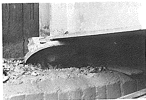
写真V-3-16 アンカーボルトの引きぬけ
