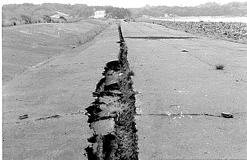
干拓地の堤防延長約 500 m 全域に亘り亀裂や不等沈下が 発生している。（松島町牛楯）
