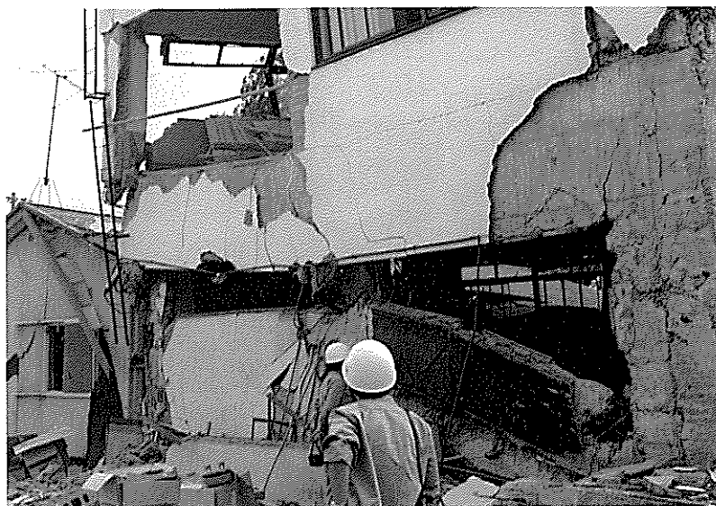
1・2階の破壊により鉄筋コンクリート造のビル全体が崩壊した。隣接の木造建築物と対照的（仙台市苦竹）
