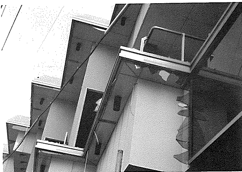
接続されている鉄筋コンクリート建築物が傾き、その圧力により鉄骨部分のカーテンウォールのガラスが大破した。 (仙台市御町)
