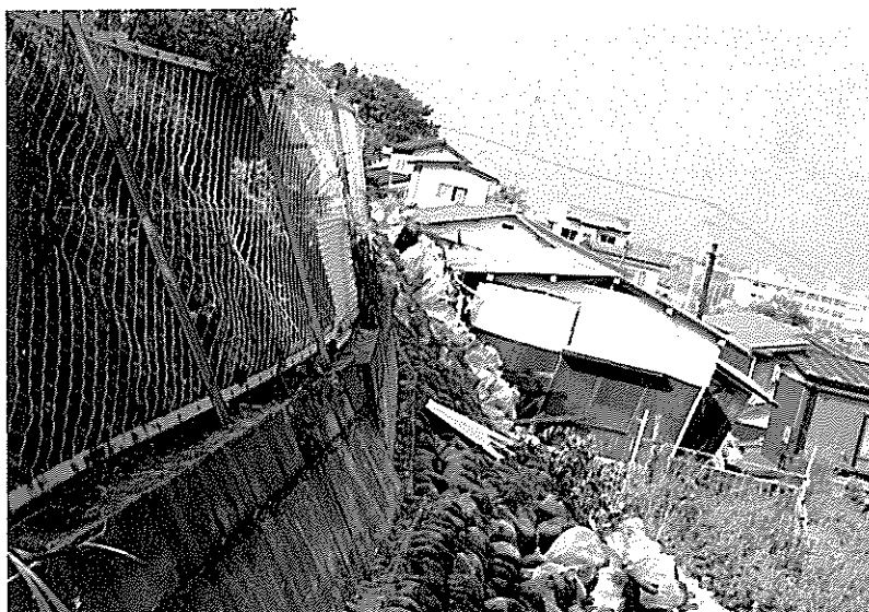
擁壁の崩壊により土砂が押し出され、建築物が傾いた。家屋の強制撤去が行われた。（仙台市緑ヶ丘）
