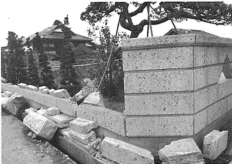
大谷石塀の崩壊 (仙台市郊外)
