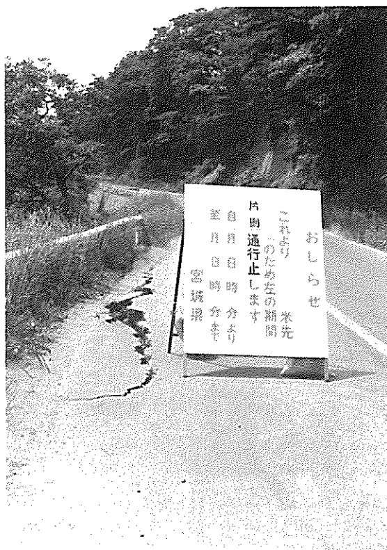
河川沿い道路の被害 (泉市野村、県道根 白石塩釜線)
