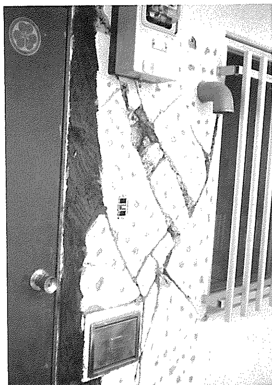
最近しゅん工した分譲マンションの外壁に亀裂が生じ、入居者と施工者の紛争に発展しそう。 (仙台市高砂)
