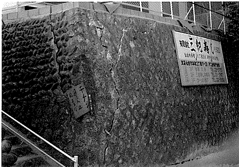
玉石で作られた擁壁に大きな亀裂が生じている。 (仙台市緑ヶ丘)
