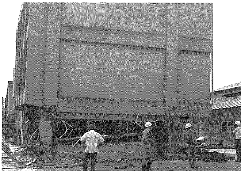
1 階と上階との壁量のアンバランスにより 1 階柱がせん 断破壊したビル。（仙台市卸町）
