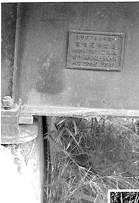
橋座巾の不足橋梁の破 損状況（2 経間連続橋 梁のため落橋は免ぬが れた。） （泉市、野村、泉市道 長者橋）
