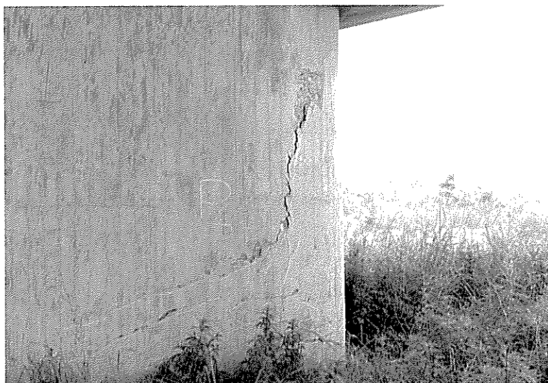
橋脚が座屈（閑上大橋）
