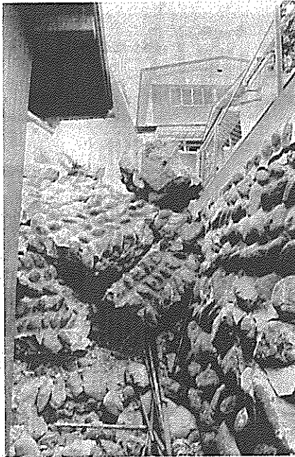
擁壁は崩壊し、右上方の窓にはキ裂が走る(仙台市緑ヶ丘一丁目で)
