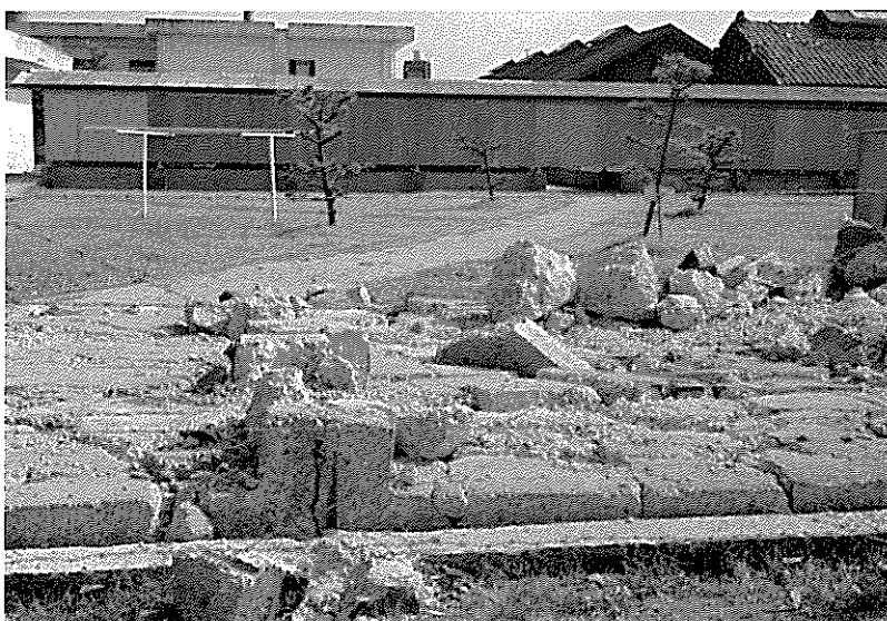
無筋のため震度5の横力に耐えきれず完全に倒壊した宮 城刑務所のコンクリート塀。(仙台市古城)
