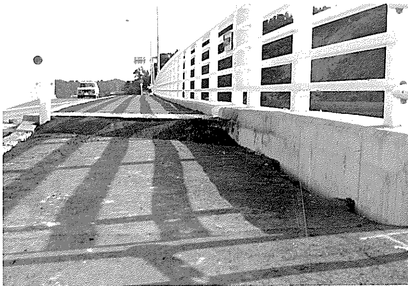
橋梁前後の取付の沈下（30 cm～50 cm） （松島町、国道45号）
