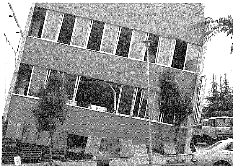
1 階柱頭部にせん断力を受け、柱が破壊され、上階が落 階したビル。（仙台市卸町）
