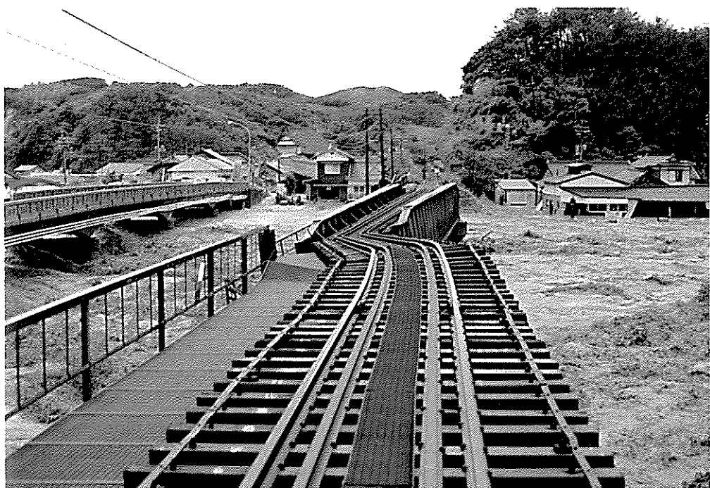
橋桁上までの増水により折れ曲がった国鉄三隅川橋梁 (古市場)
