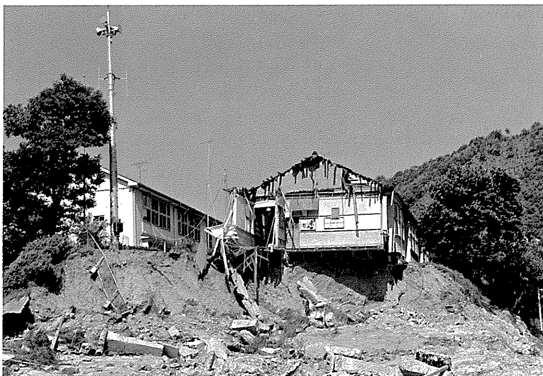
校舎の基礎をえぐり建物は見るかげもない
