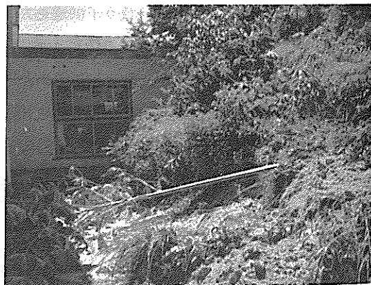
炊事場をのみ込んだ裏山の崩土
