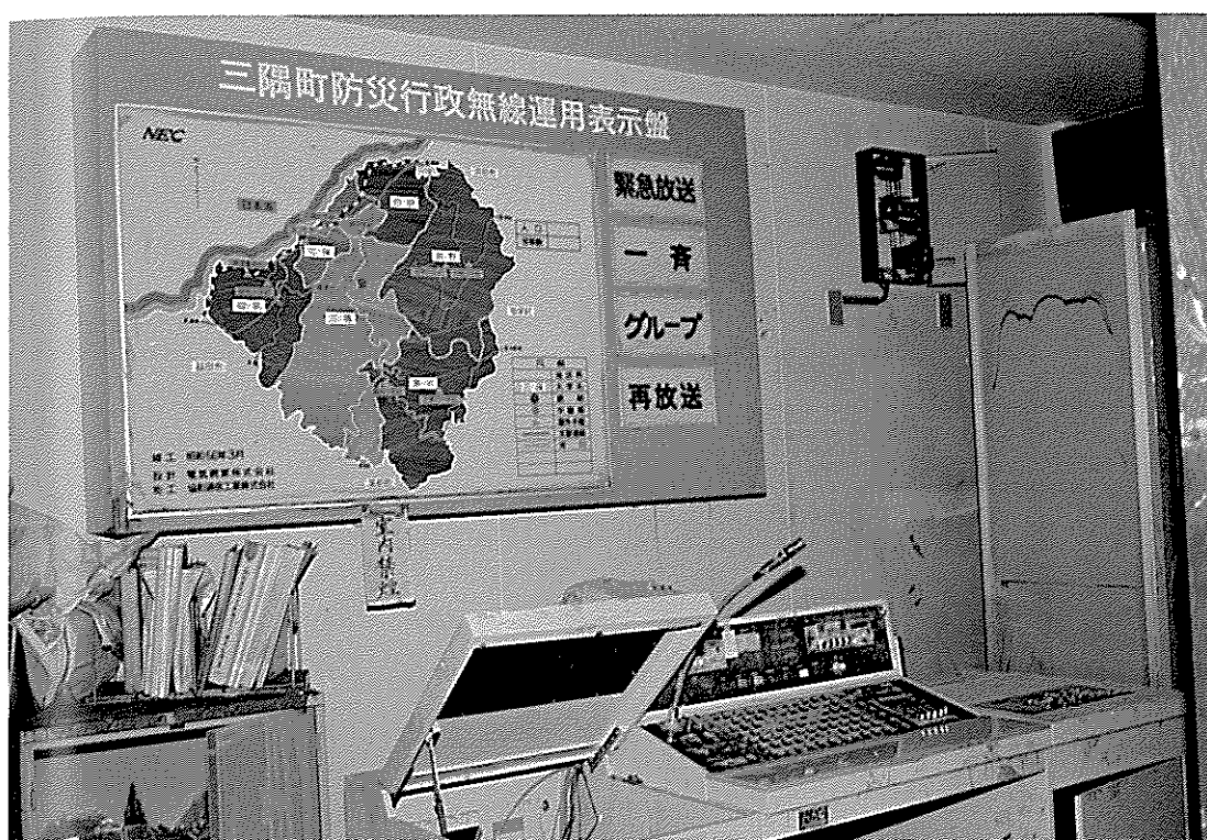
気象警報、ダムの放水量、避難誘導など各種情報連絡に活躍した防災行政無線 (三隅町役場)
