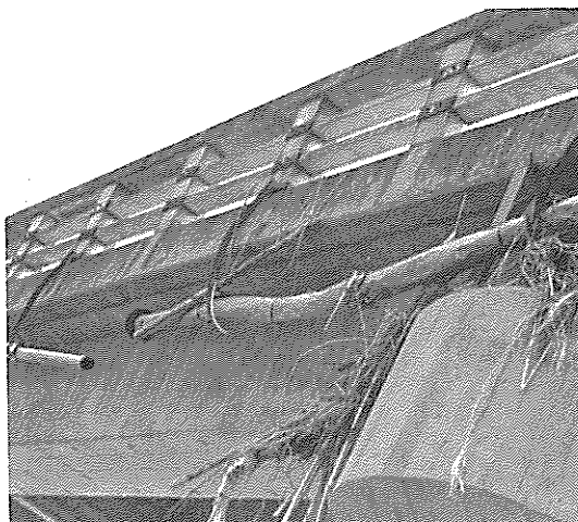
上古市配水管の破損状況
