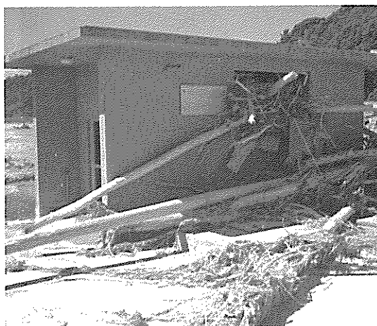
三保第2水源地の被害
