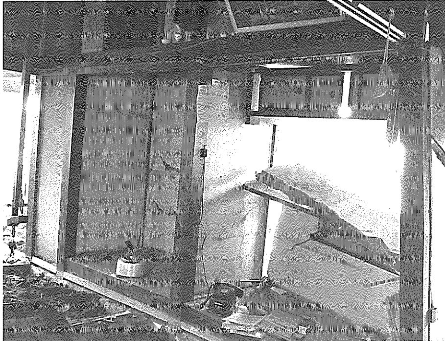
△家の形は残っても、内部は壊滅状態—芦崎—
