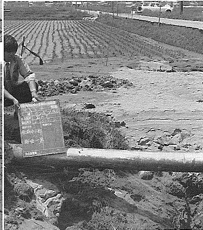
▽陥没によって送水管が露出した
