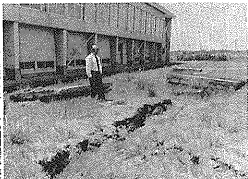
亀裂が走り、浮き上がった八竜中の浄化槽
