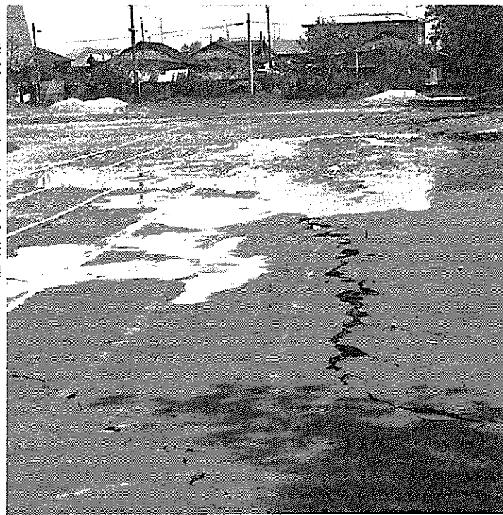
▷ 浜小グラウンドでも液状化現象が起こった ◁ 激しい揺れで浄化槽も押し上げられた。
