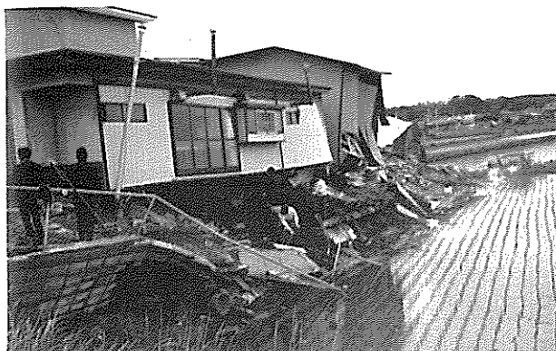
擁壁崩壊で土砂流失のため全壊した住宅(野石)
