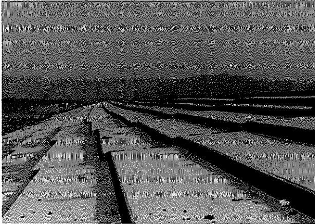
写 6 - 20 能代港落合地区階段護岸の被害
