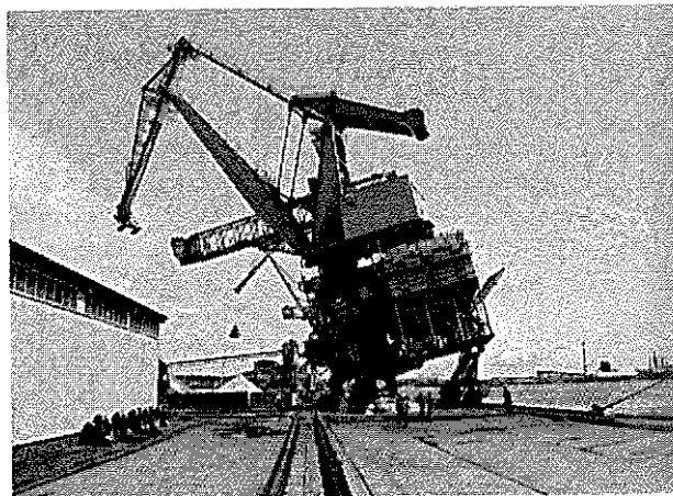
写 6 - 2 秋田港中島 2 号岸壁の被害状況
