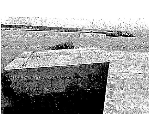
写8-5 能代港火力用地造成工事におけるケーソンの被害
