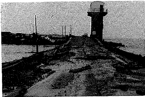
写 6-18 能代港中島地区臨港道路の被害
