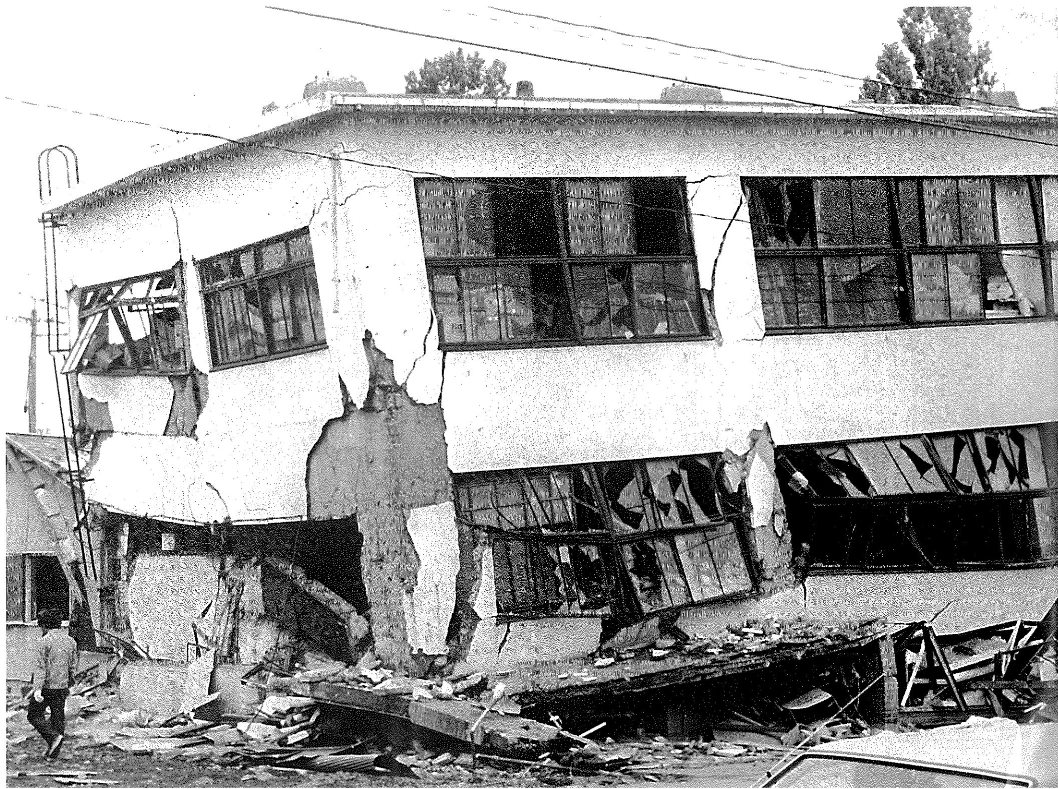
一階が完全に壊滅したビル（市東部・苦竹）
