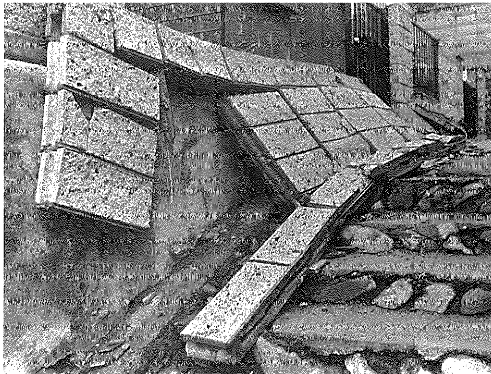
倒れたブロックべい (市南西部・緑ヶ丘)
