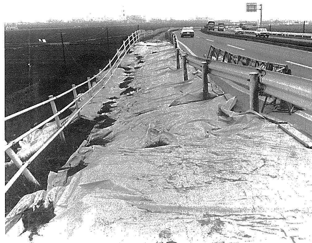
落差のできた国道4号線（市北東部・仙台バイパス）
