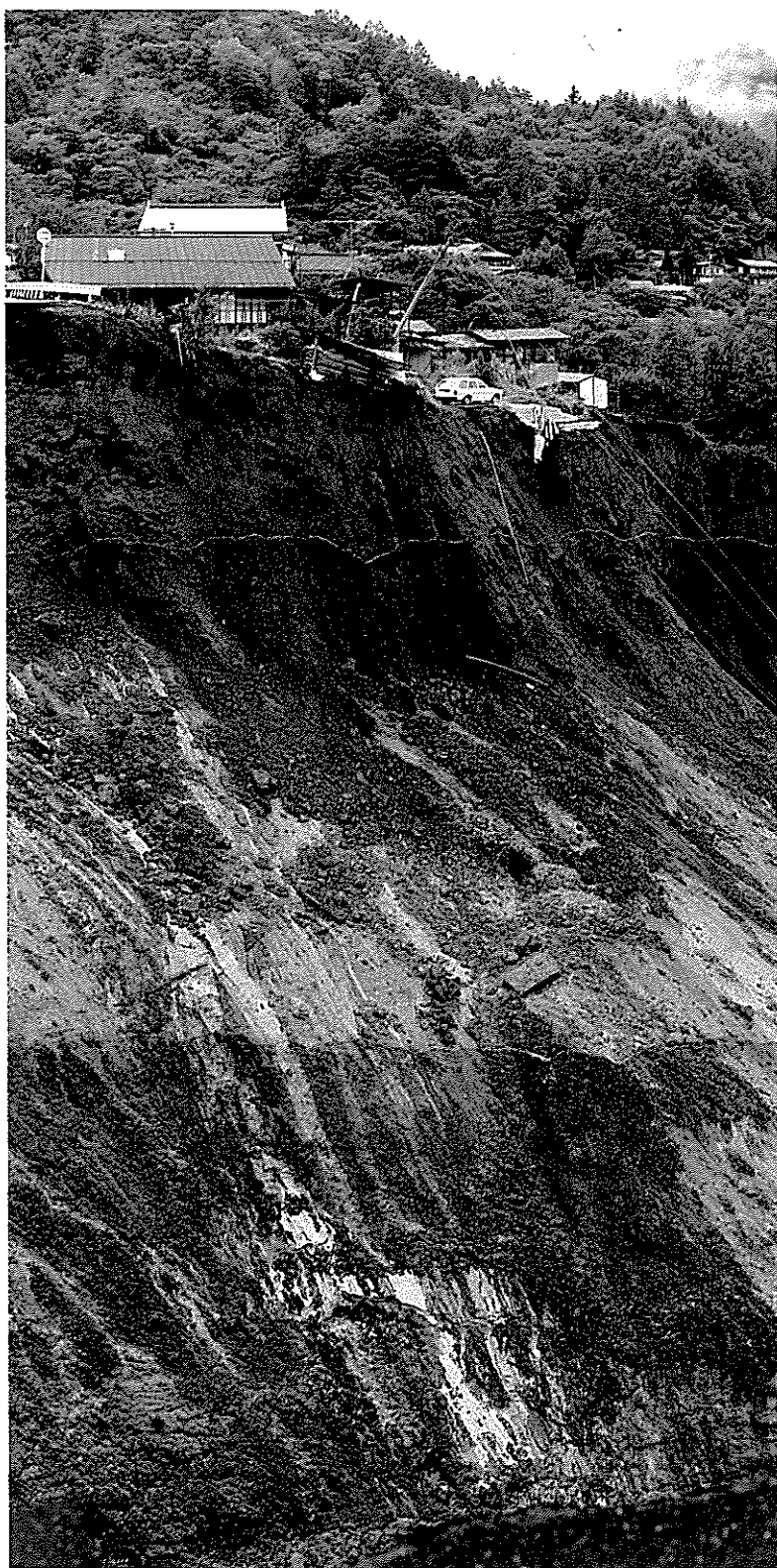
松越地区の大崩落
