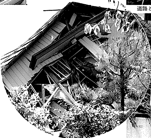
倒壊した家屋
