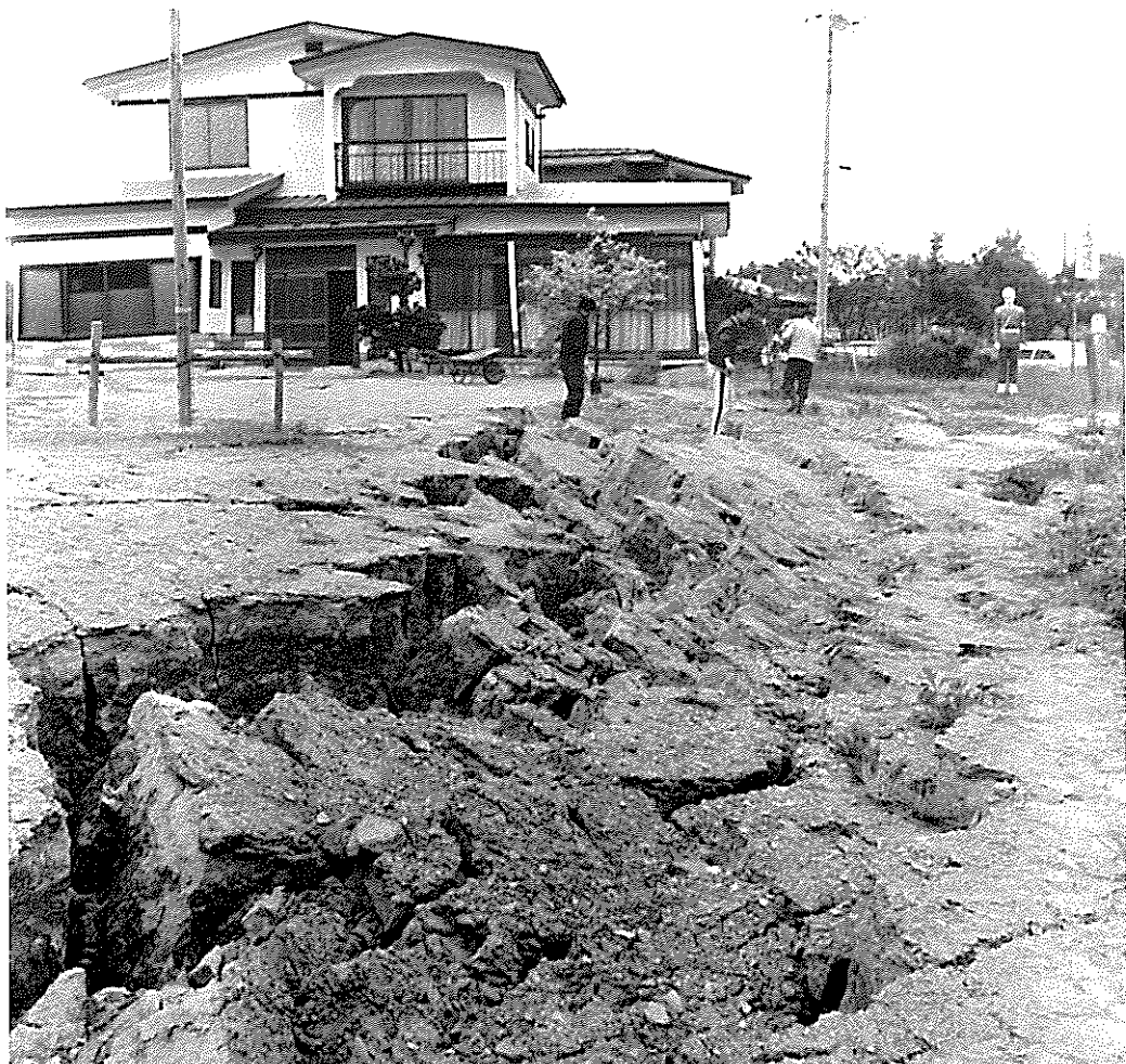
地 割 れ (男 鹿 市 脇 本)
