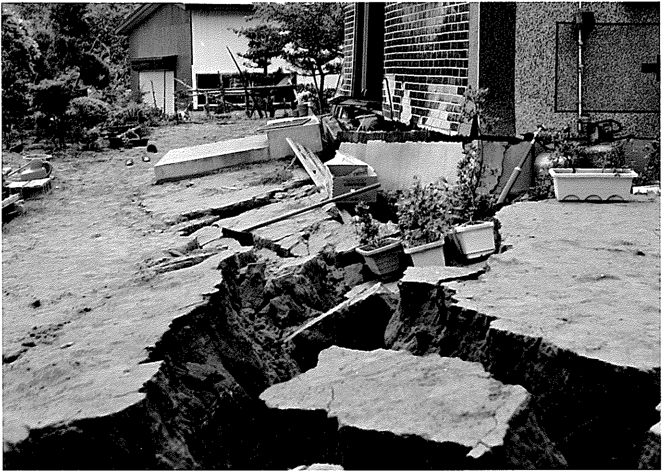
地 割 れ (青 森 県 車 力 村)
