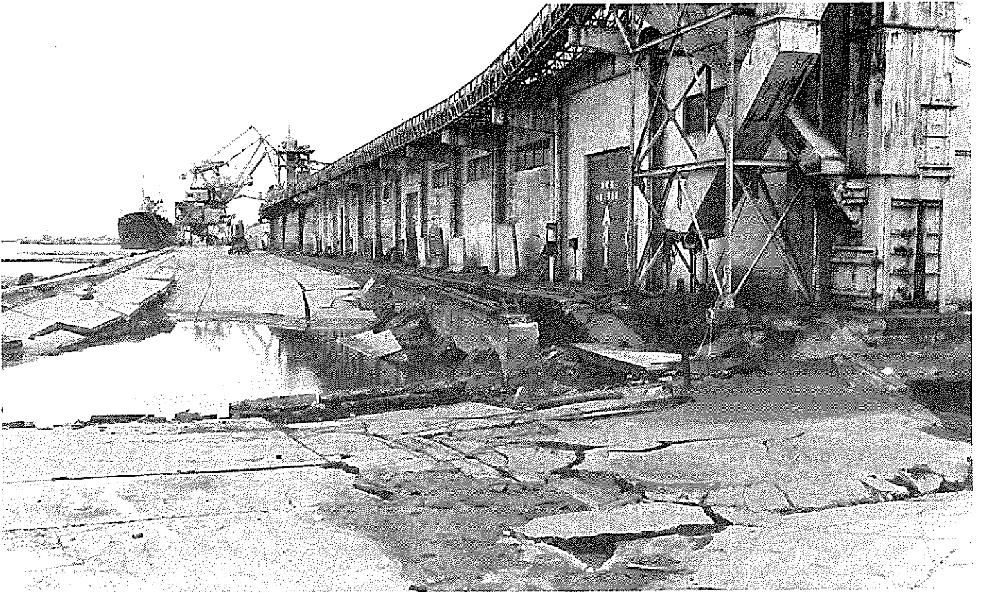
岸 壁 破 壊 (秋 田 港)
