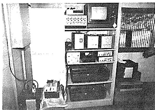
写-10.1.1 泥流観測機器の設置状況 (西山川地域)
