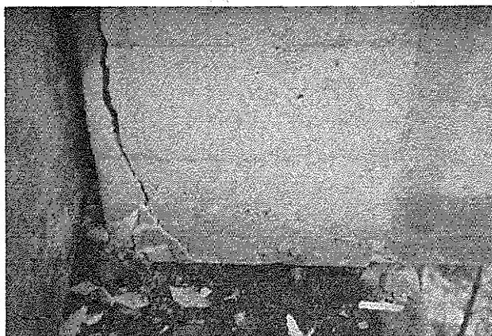
写真 3.30 黒瀬橋の R C 桁端の破損
