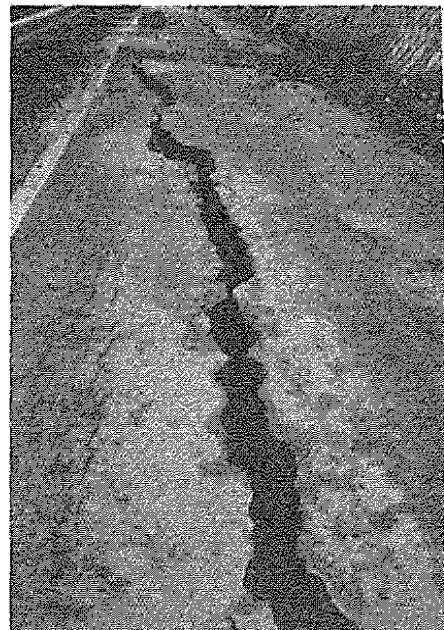
写真 3.4 路面の亀裂（県道越木曾福島線）
