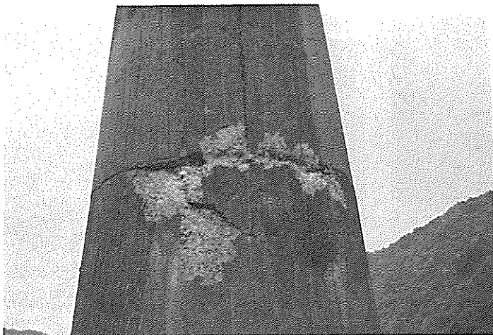
写真 3.20 松原橋 R C 橋脚の破損 (上流側)
