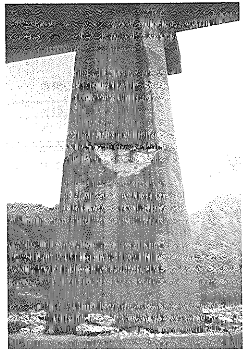
写真 3.18 松原橋 R C 橋脚の破損 (下流側)
