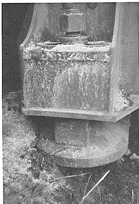
写真 3.34 大岩橋の支承部の破損（右岸側橋台上，下流側）
