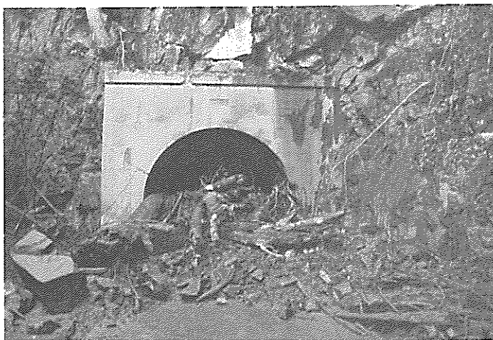
写真 3.48 氷ヶ瀬トンネルの埋塞状況（松越側入口から）
