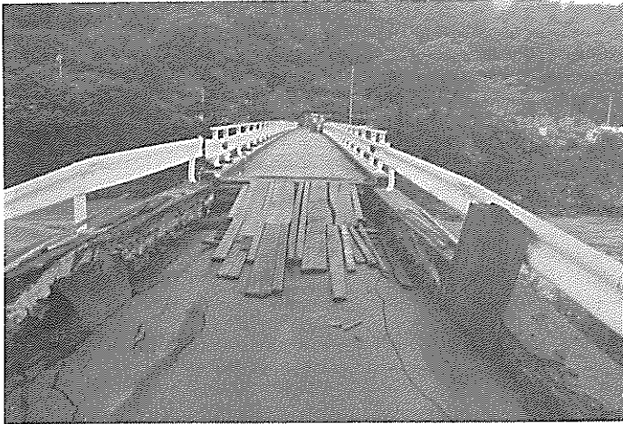
写真 3.47 橋台取付盛土の沈下（池の越橋，段差量50cm）
