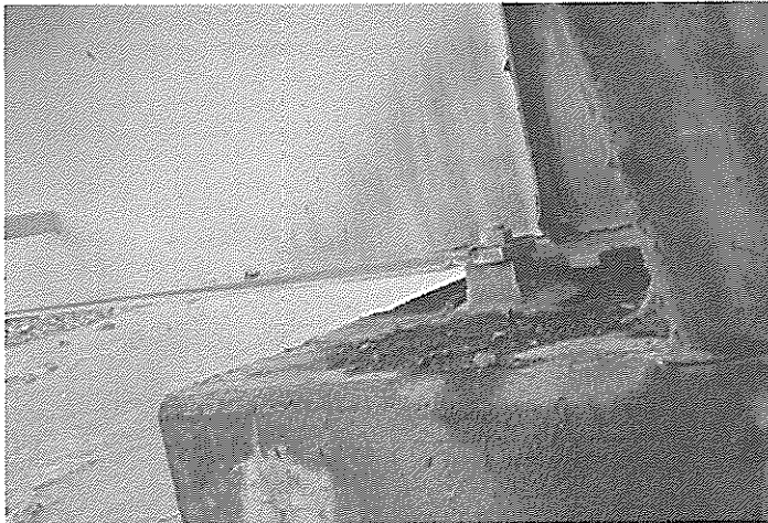
写真 3.26 松原橋の支承ソールプレート 突起の破断（右岸側橋台上上 流側）
