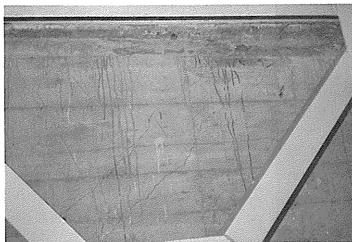
写真 3.22 松原橋の左岸側橋台パラペッ トの破損 (斜めひびわれ)
