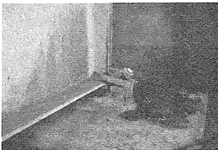
写真 3.24 松原橋の支承アンカーボルトの抜上り（左岸側橋台上下流側）
