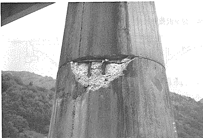
写真 3.19 松原橋 R C 橋脚の破損 (下流側)
