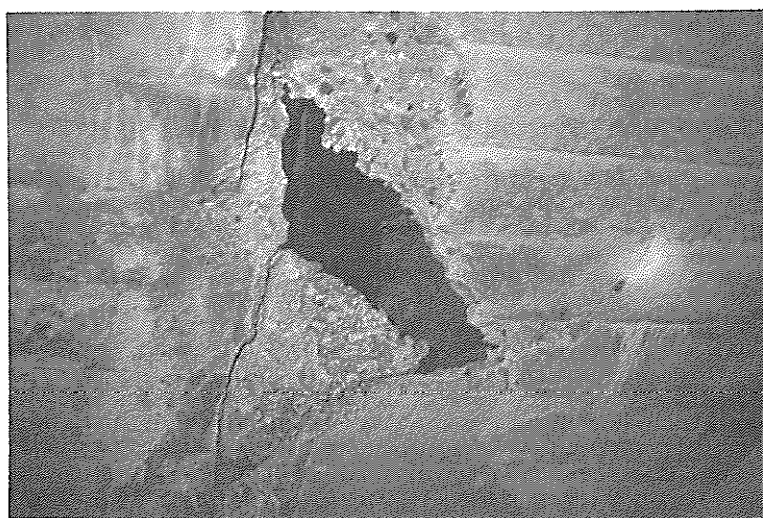
写真 3.50 覆工コンクリートの欠落 (30cm×30cm)
