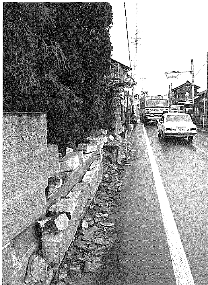
石を唯積みだだけの塀は、ほとんどなんらかの被害を受けた。
