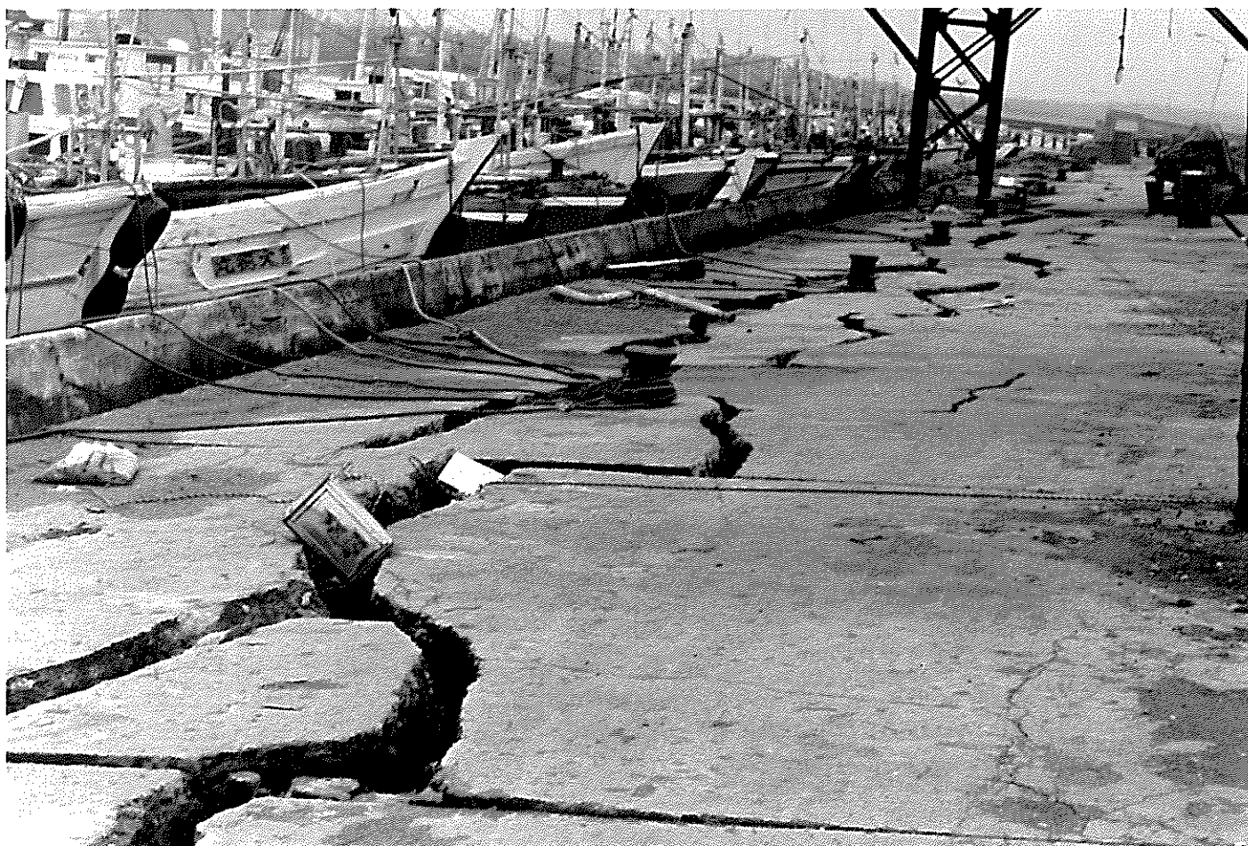
物揚場（ -2.5\text{ m} ）の提体が前傾し、エプロン約200 m にわたって沈下及び亀裂を生じた。
