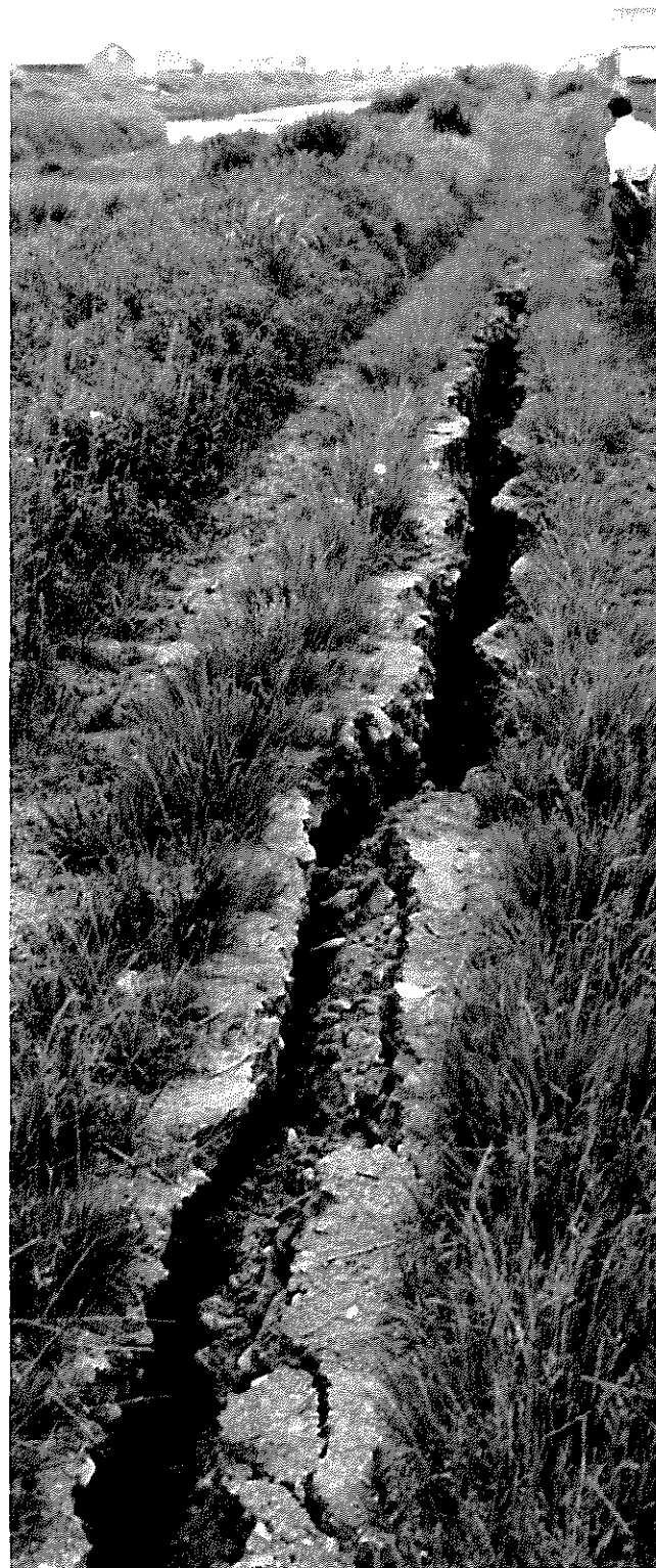
堤体中央に300 m にもわたり亀裂が走り、30～50cm の沈下も生じている。(梅田川左岸・仙台市苦竹)
