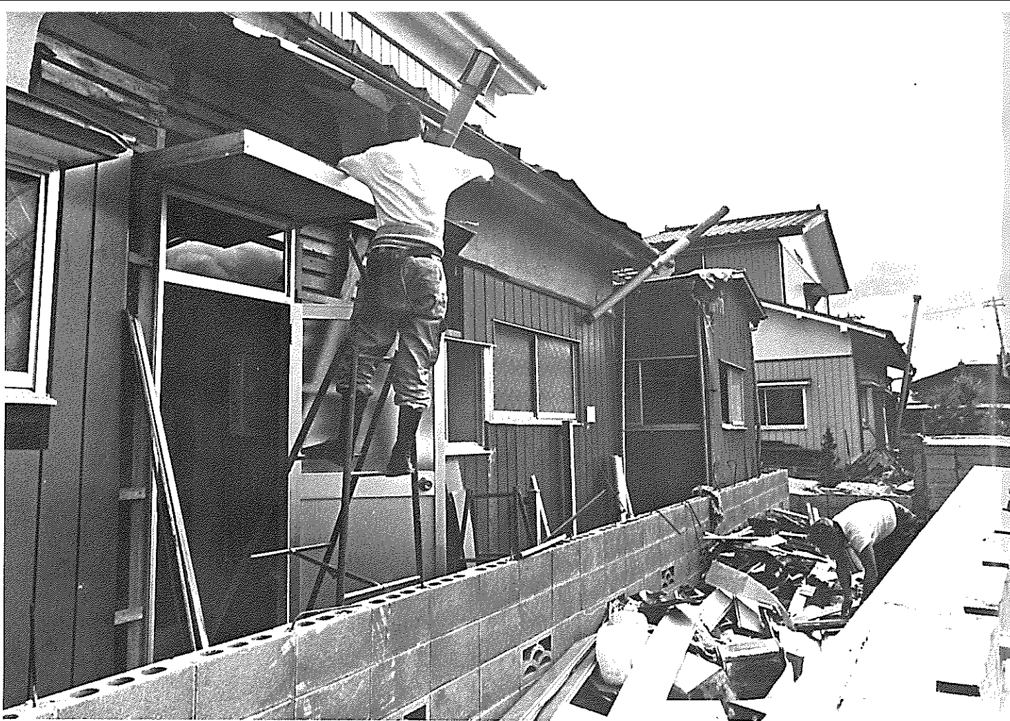
崩れた壁もとりあえず応急修理で
