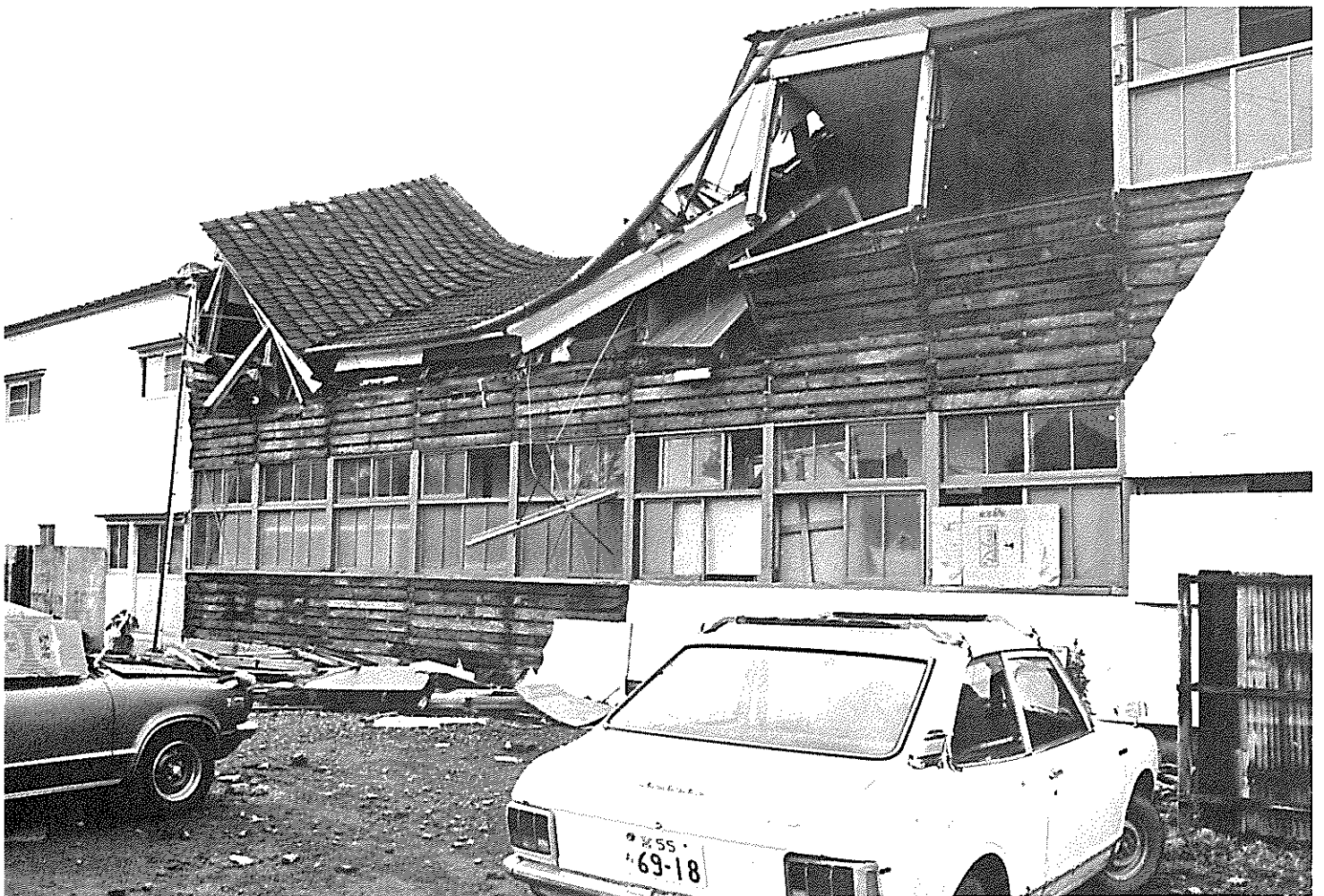
二階の屋根がつぶれた小学校（泉市野村小学校）
