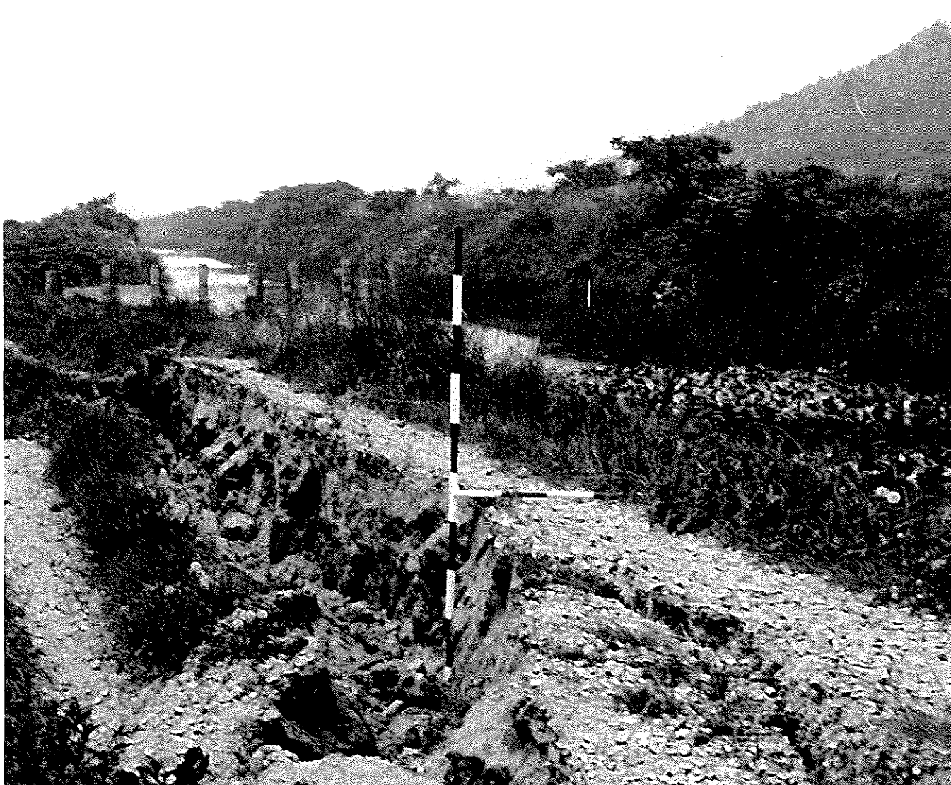
陥没・沈下も1m以上に及んだ(中島川右岸・河北町牧野巣)
