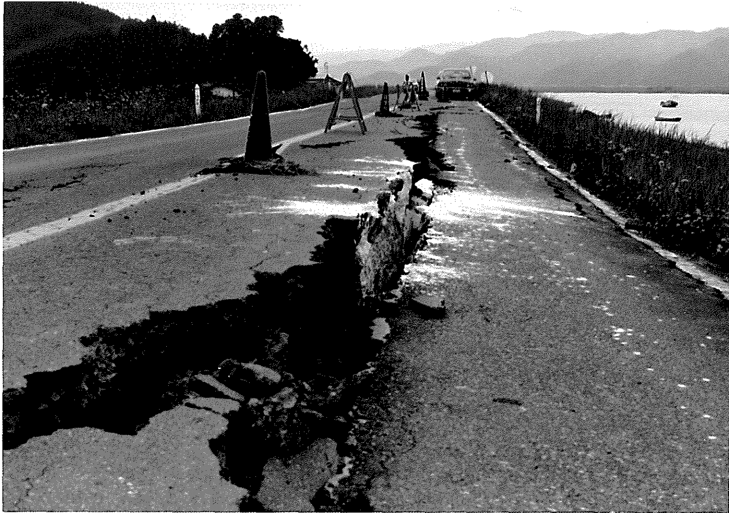
亀裂の段差が生じた北上川堤防（北上川右岸・釜谷第四堤防）
