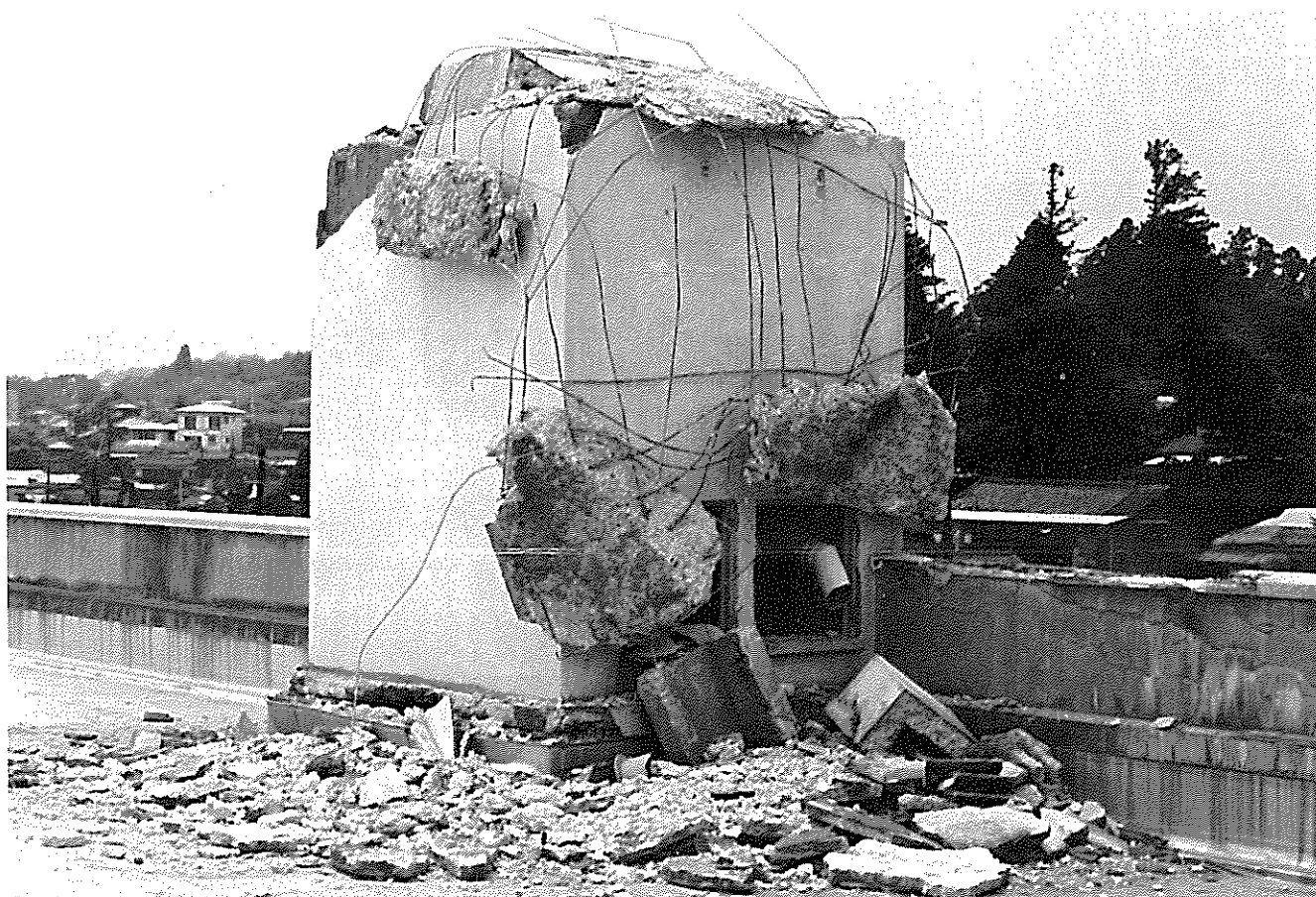
東北学院大学の煙突が中程からポツキリと折れた。（仙台市土樋）
