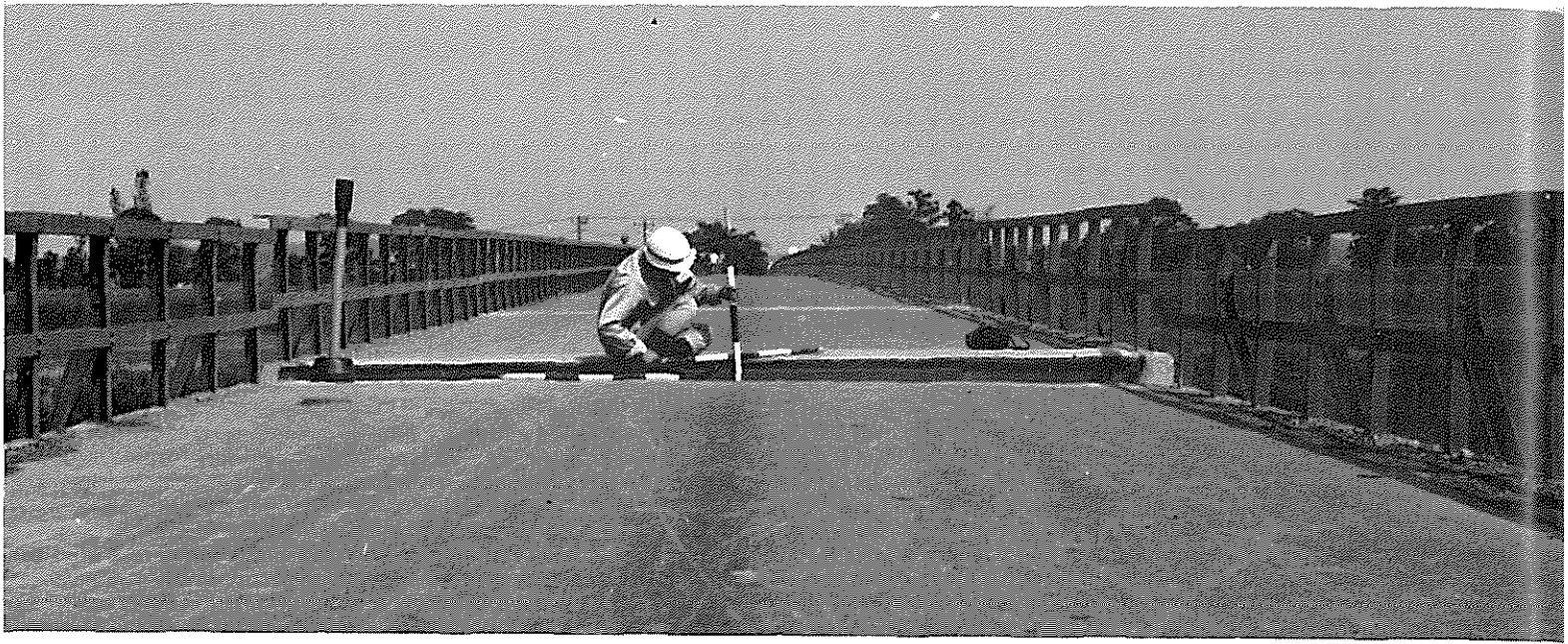
木間塚橋。橋脚破損のため上部工が沈下し段差が生じた。主要地方道・石巻鹿島台大衡線（南郷町・鹿島台町）
