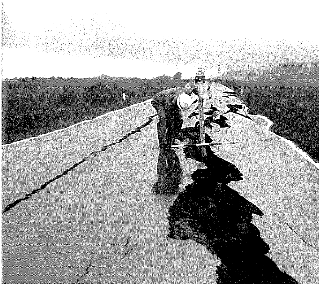
天端の大きな亀裂。橋浦堤防は、北上川第一期改修工事によりほとんど水田を埋めて施工されたものであり、基礎地盤も弱いようである。（北上川左岸・橋浦堤防）
