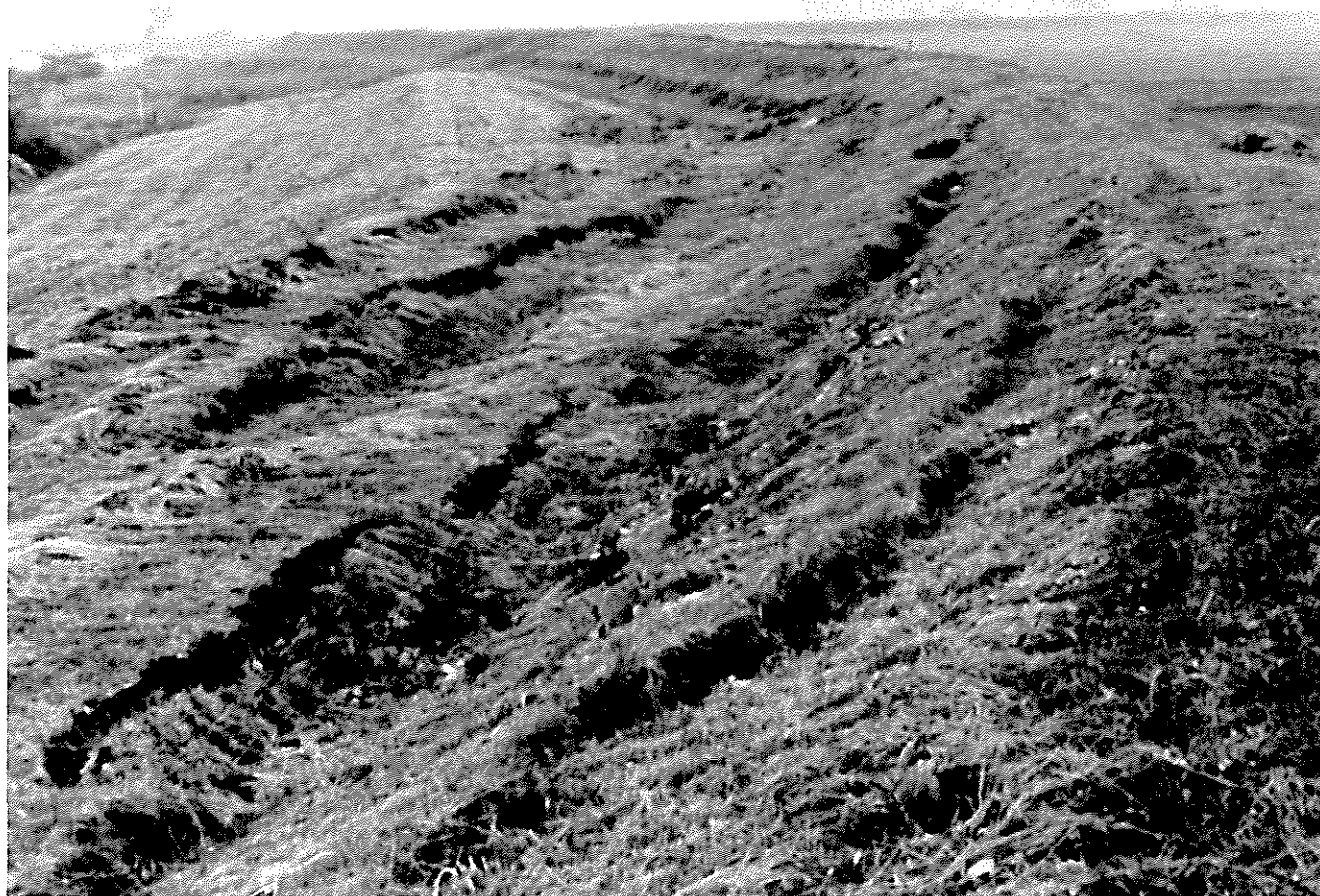
すべりによって生じたと思われる表法面の数条の亀裂 (吉田川右岸・山崎堤防)
