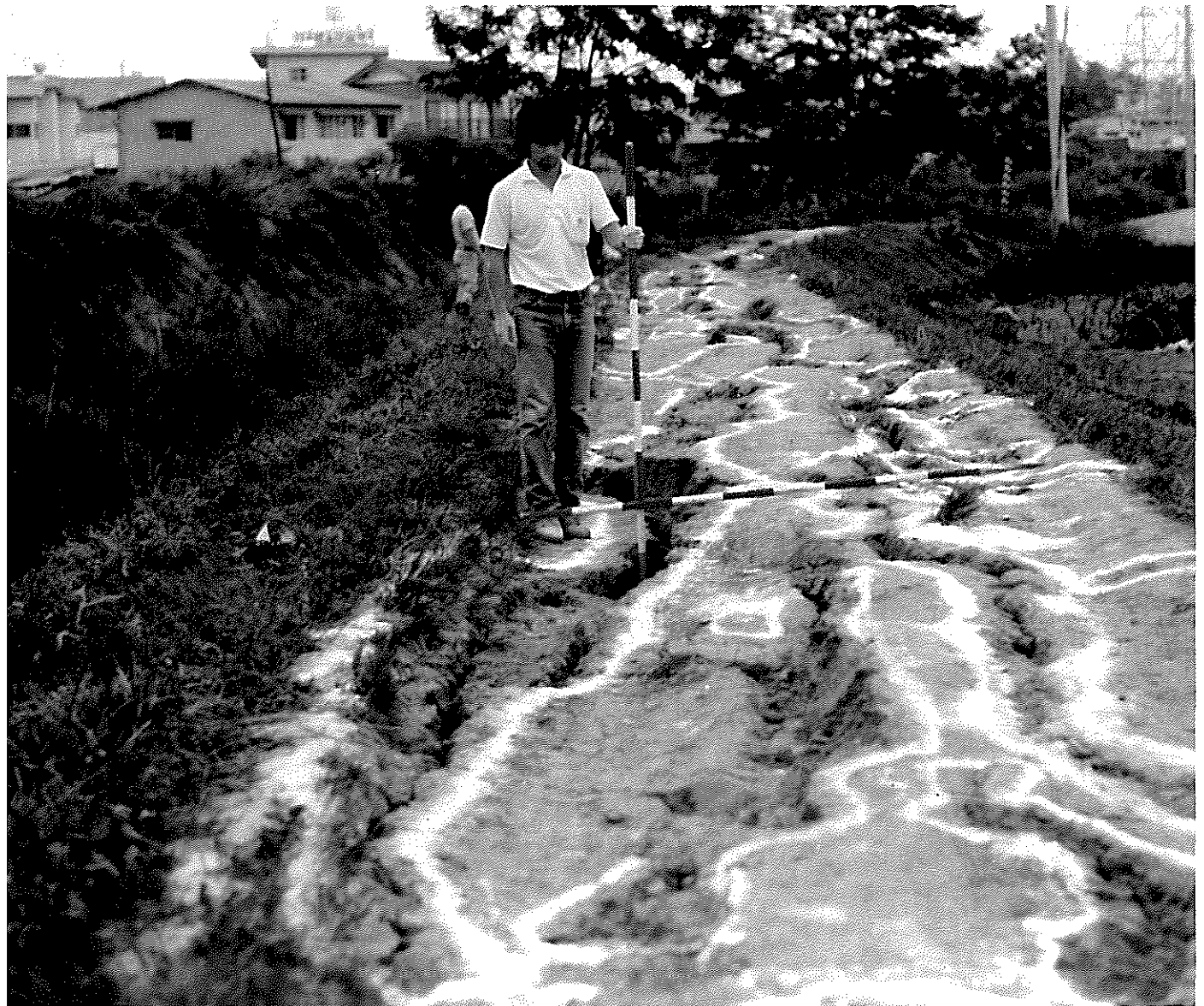
亀甲状の亀裂の入った堤防(仙台市右岸・泉市川原)
