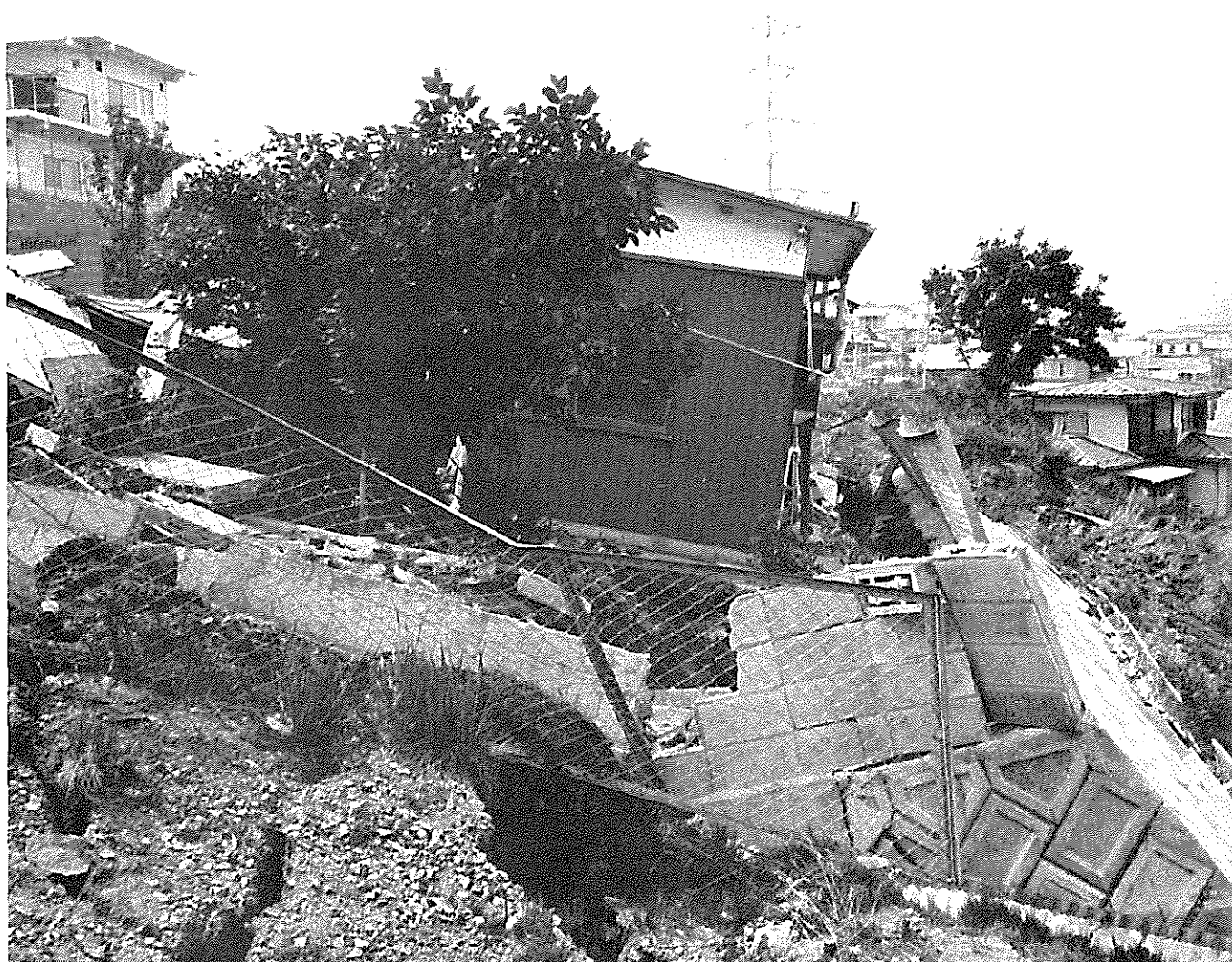
宅地造成の盛土部に築造されたブロック積が崩壊し、建築間もない住家が全壊した。(仙台市緑ヶ丘三丁目)
