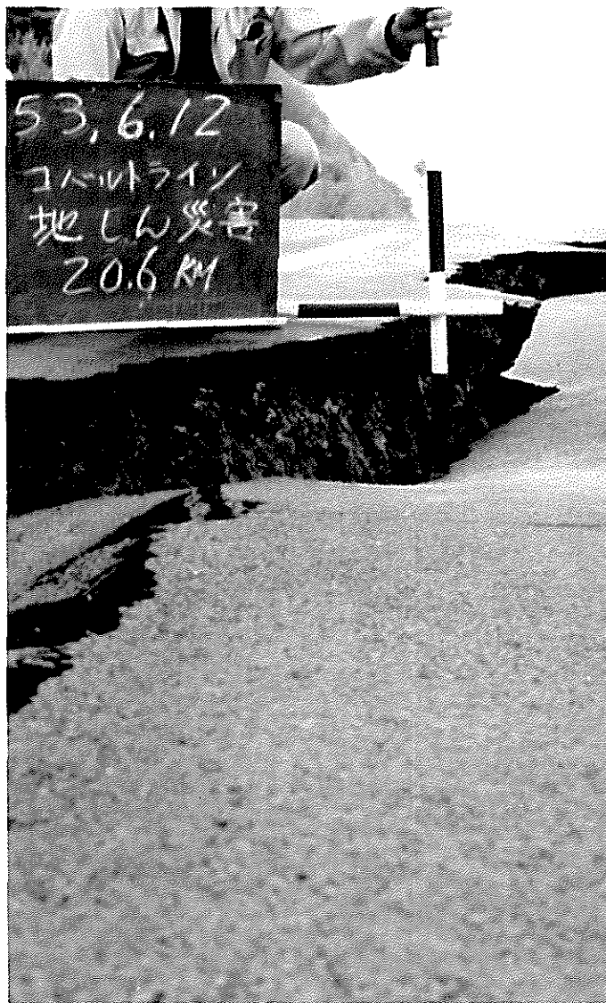
道路の崩壊。一般県道・牡鹿半島公園線（牡鹿町新山浜）
