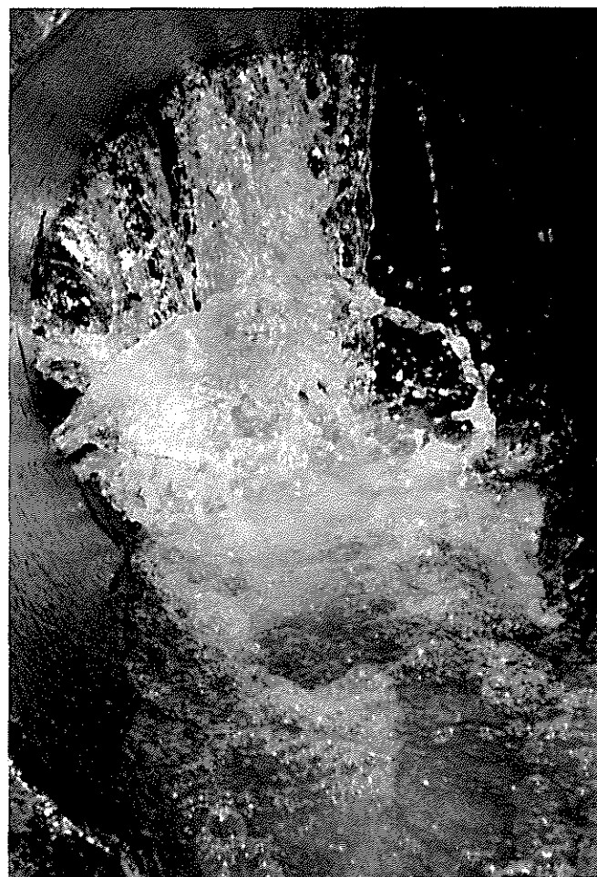
苦竹地区伏越管(ヒューム管φ500㎜)の継手部破損による地下水の流入(仙台市公共下水道苦竹地区伏越管)
