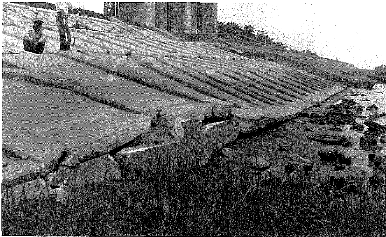
法枠護岸工の破壊状況（阿武隈川左岸・名取市新浜）
