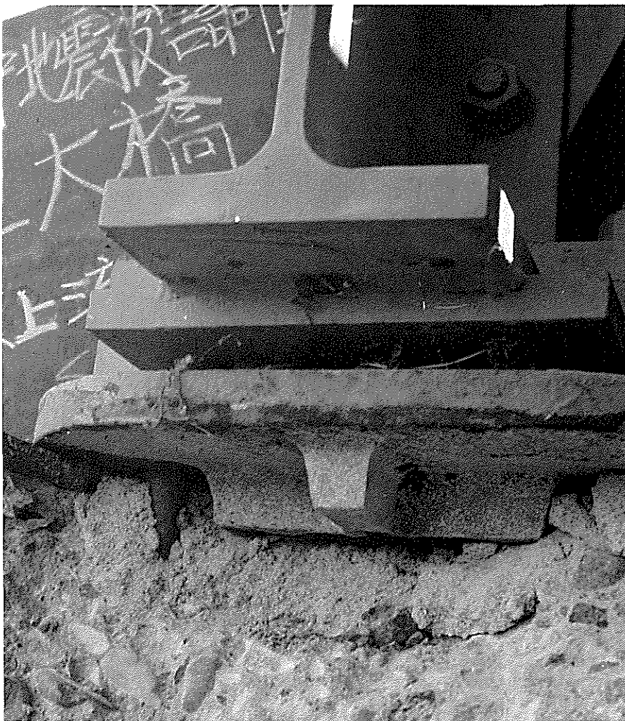
豊里大橋。第3橋脚、上流沓座コンクリートの破壊状況。 主要地方道・河南米山線（豊里町赤生津）
