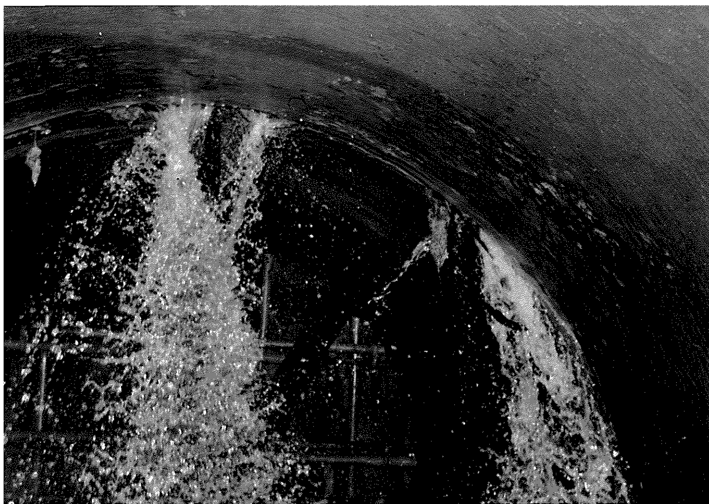
ヒューム管(φ2,200㎜)の継手部破損による地下水流入(仙台市公共下水道七北田川右岸幹線)
