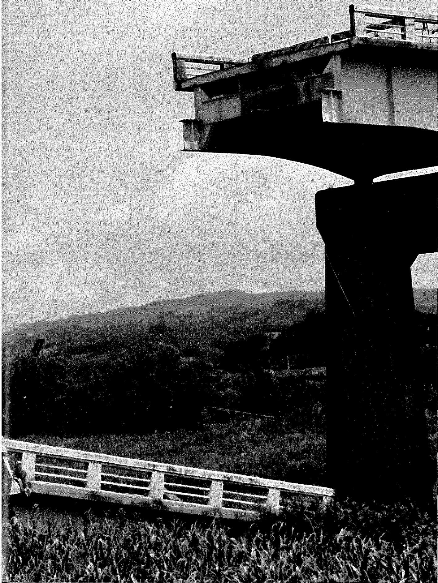
錦桜橋。右岸から第八径間のゲルバー吊桁一連が落橋。 これより右岸寄りの七径間が右岸側に変位したため。国道三四六号（中田町・東和町）
