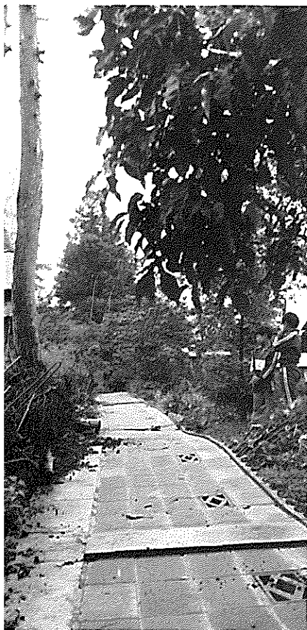
基礎もろとも倒壊した ブロック塀
