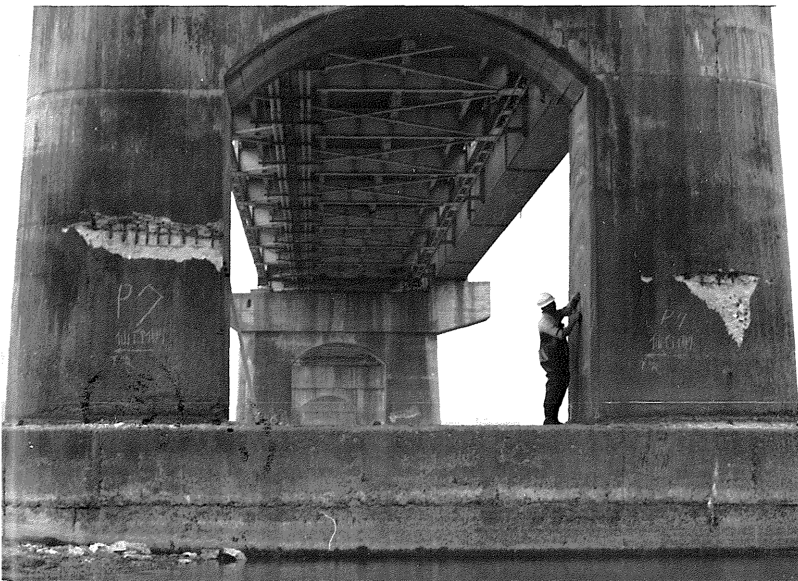
阿武隈橋。橋脚のコンクリート剝離と鉄筋座屈。国道6号線（岩沼市・亘理町）
