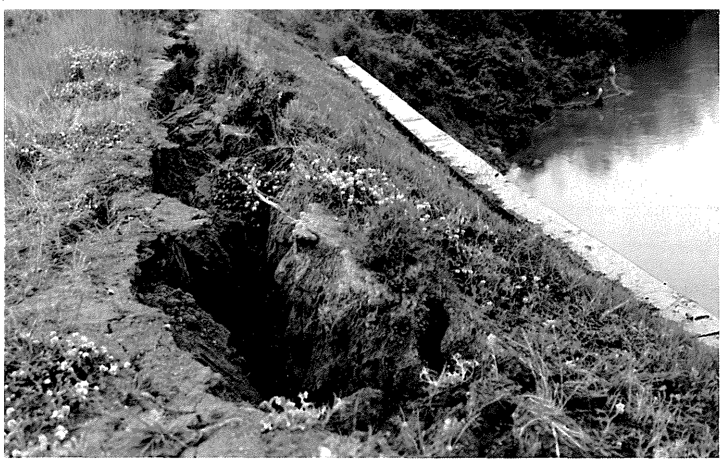
亀裂の幅が1m近くにも達した。(七北田川右岸・泉市川原)
