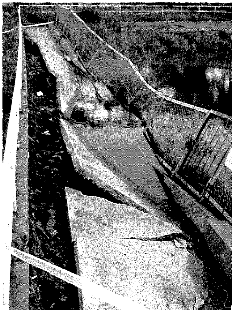
池沿の園路の崩壊（小牛田町・志賀公園）
