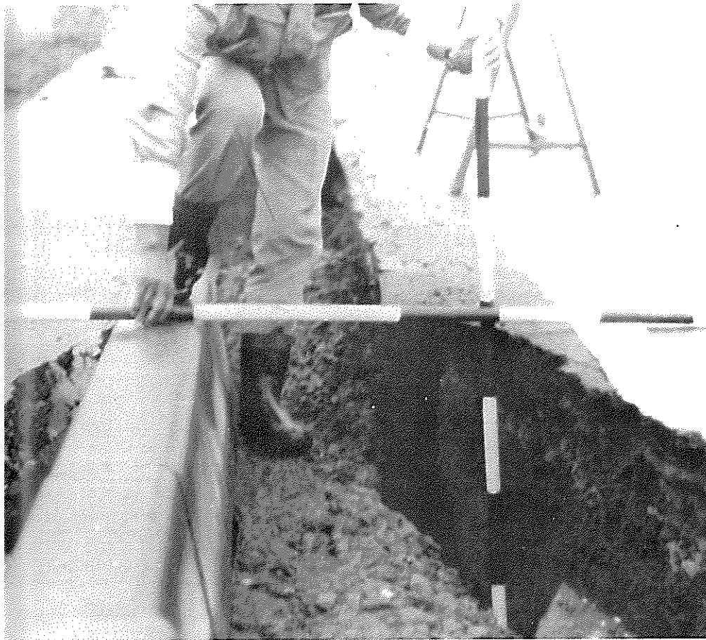
道路の亀裂と歩道部の沈下。主要地方道・奥松島松島公園線（松島町北の窪）
