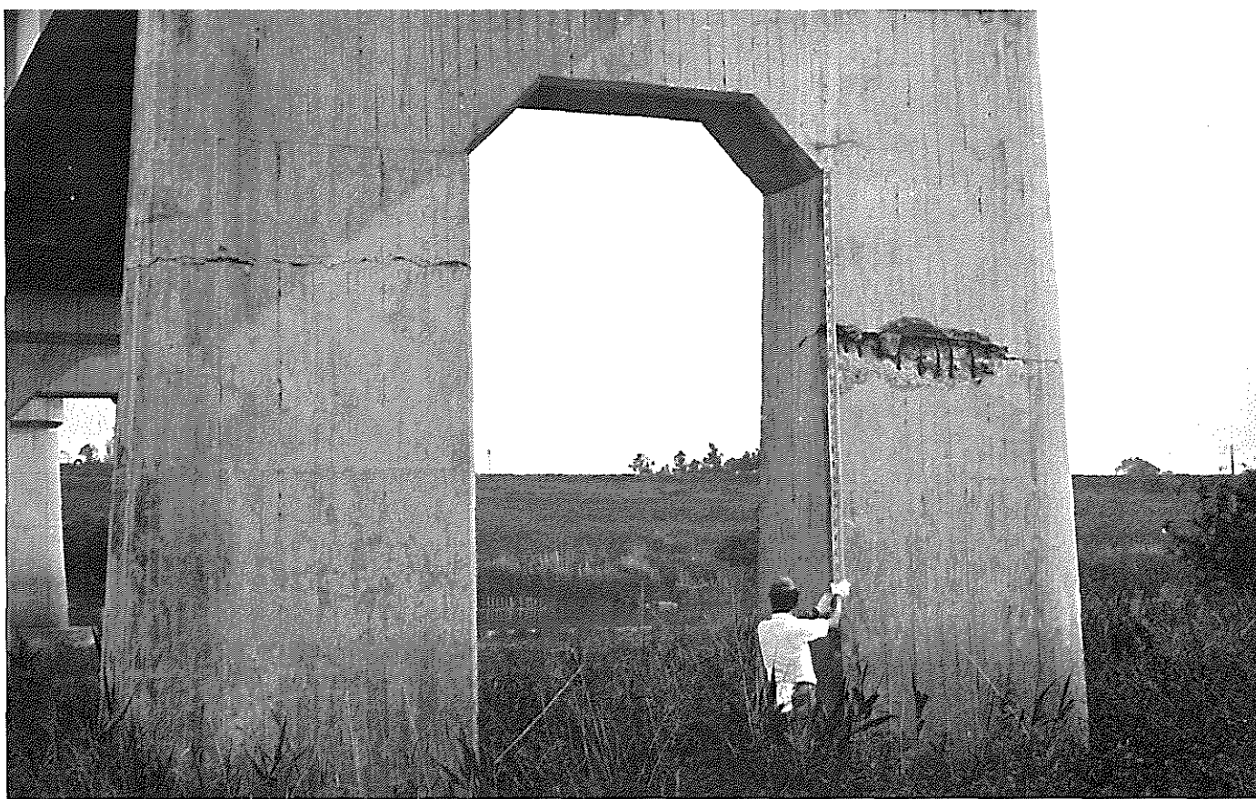
志田橋。橋脚頭部の破壊状況。一般県道・古川松山線（古川市・松山町）
