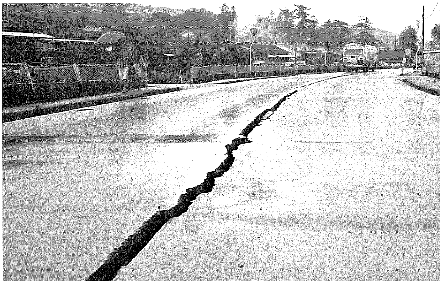
舗装道路中央にも亀裂が走る。国道286号（仙台市砂押）
