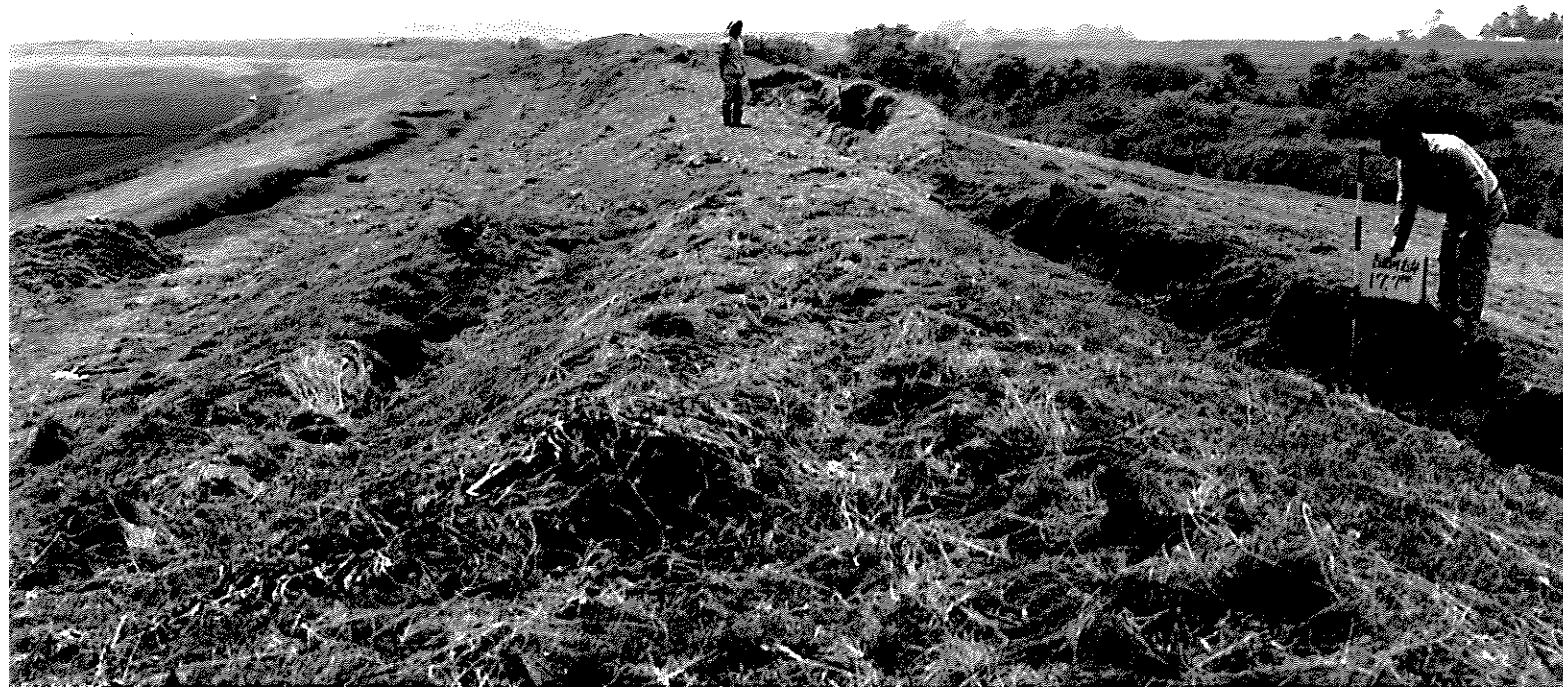
大きなすべりにより天端は1 m程度沈下している。(吉田川右岸・山崎堤防)
