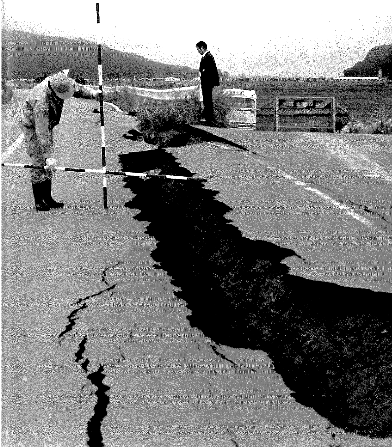
道路に生じた大きい亀裂と路面の沈下。一般県道・北上河北線（北上川護岸兼用堤）
