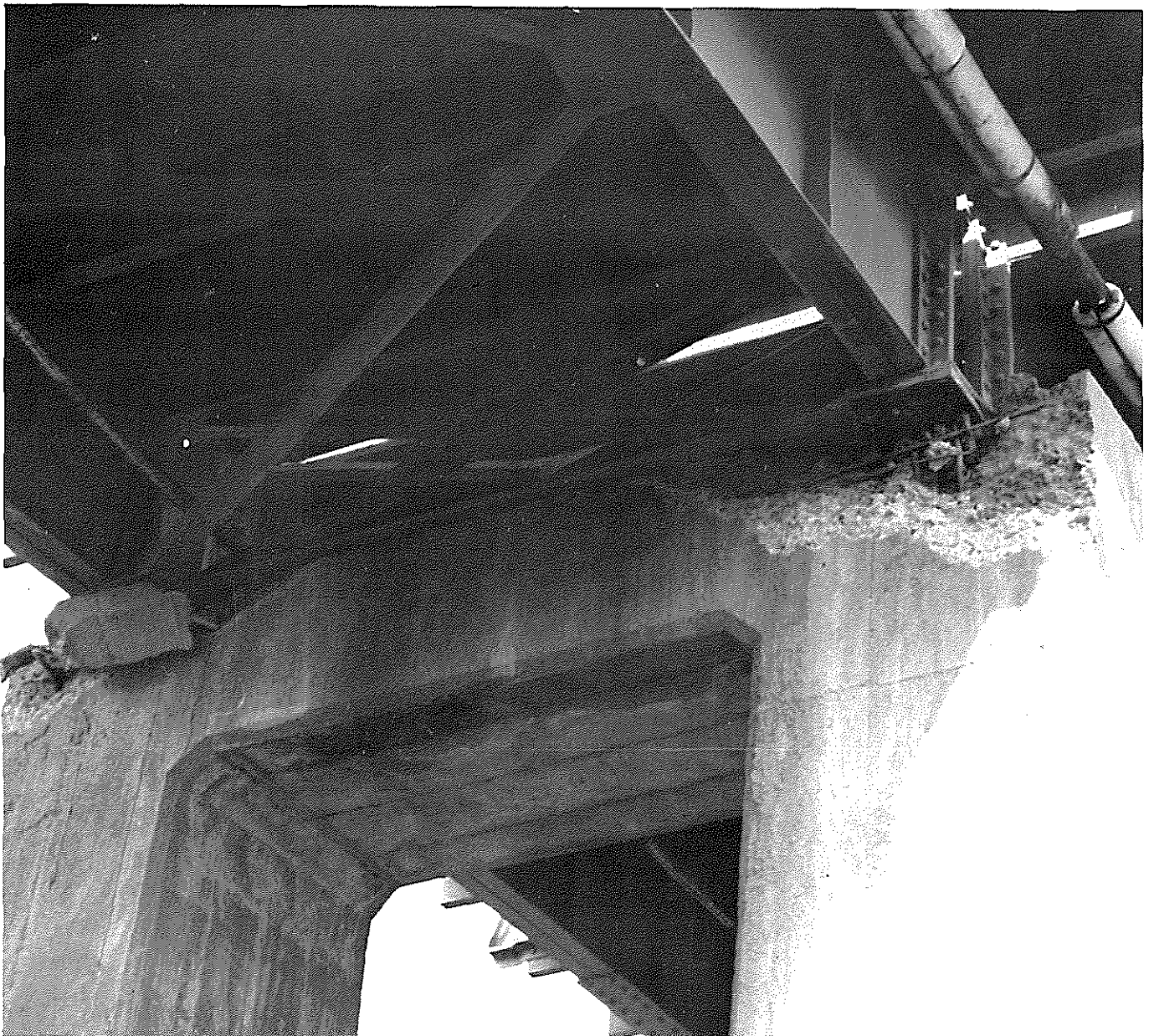
木間塚橋。橋脚の沓座コンクリートの破壊状況。
