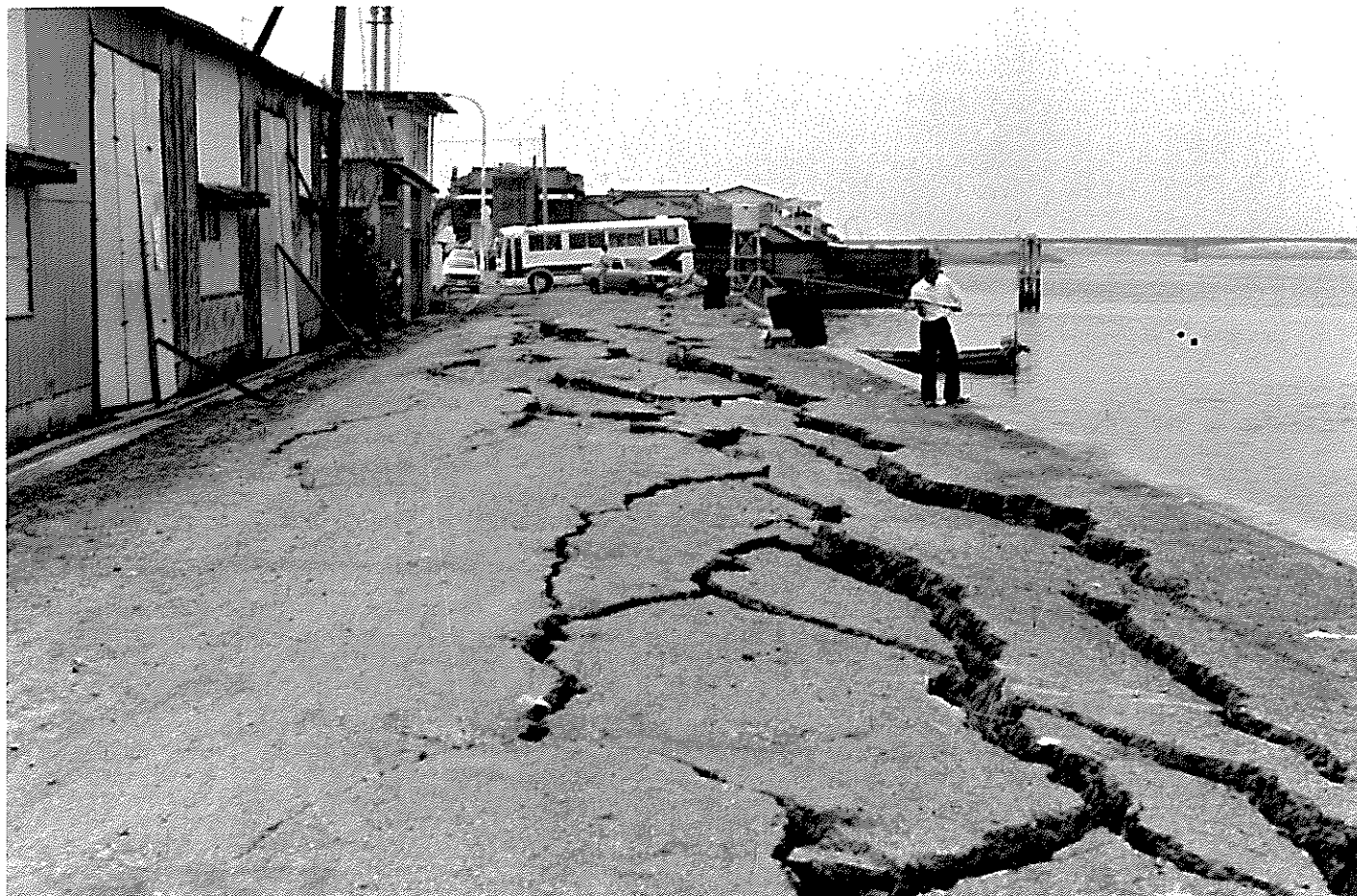
背面道路の亀甲状の亀裂（関上漁港）
