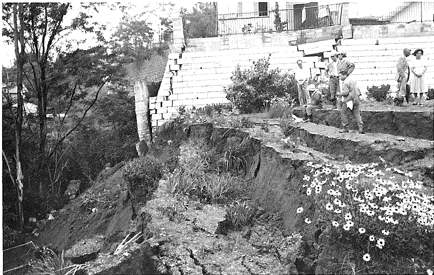
手前側の盛土部に築造されたブロック積が崩壊し、奥のブロック積も盛土と共に移動し危険な状態となり住宅は全壊した。(仙台市緑ヶ丘一丁目)
