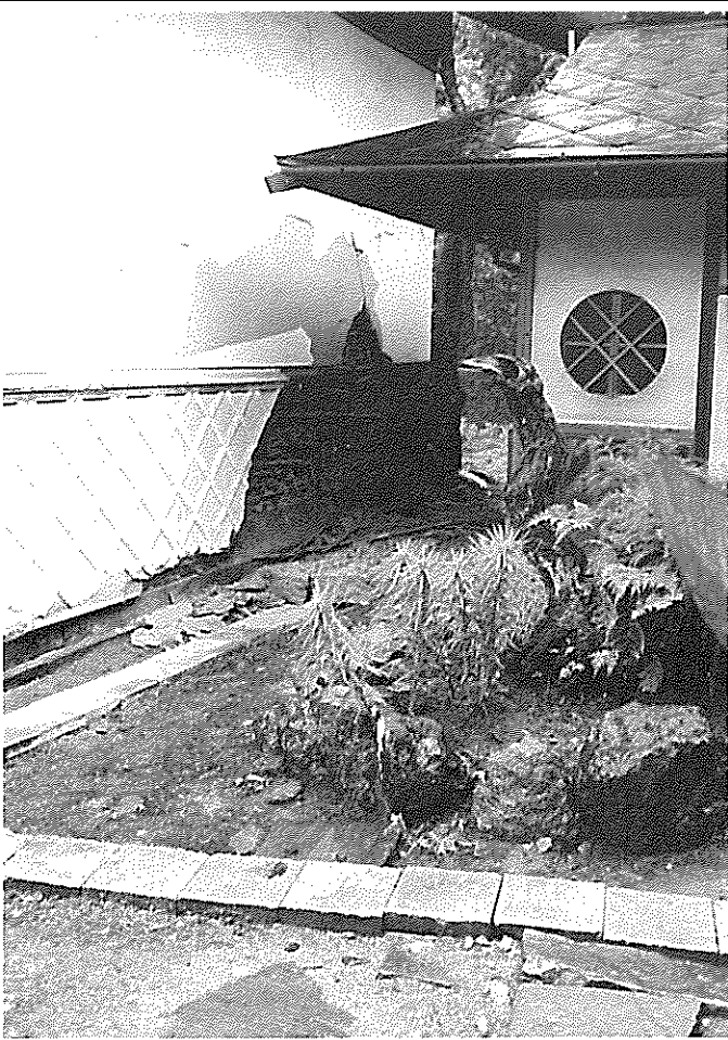
壁が崩れ落ちた旧有壁宿本陣の土蔵（金成町有壁）
