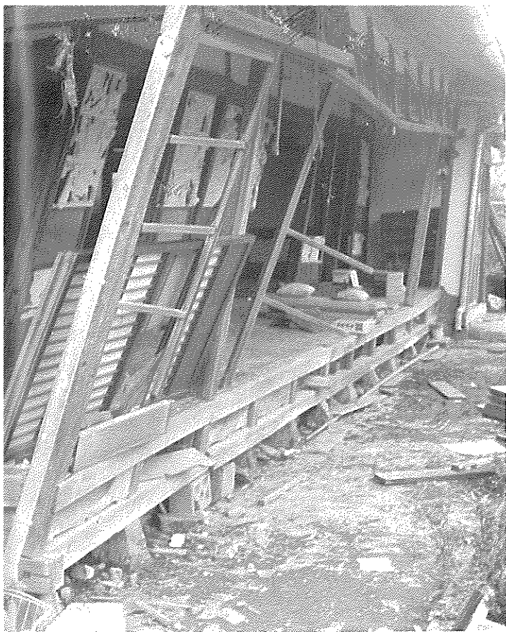
倒壊は免れたものの、柱が傾むき居住出来なくなった民家（河北町）
