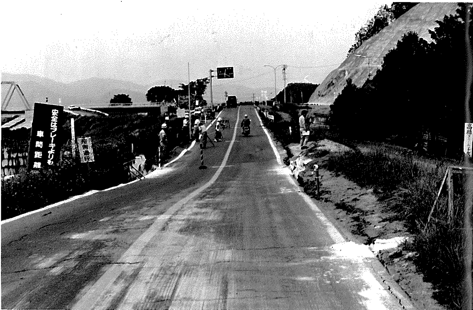
元は平らであった兼用堤の路面が陥没しているのがわかる。(北上川右岸・釜谷第二堤防)
