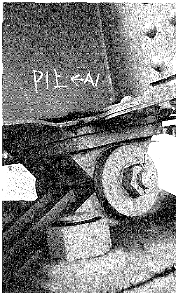
柳津大橋。第1橋脚上流側、沓附近のトラス下弦機の破断。一般県道・河南津山線（津山町柳津）
