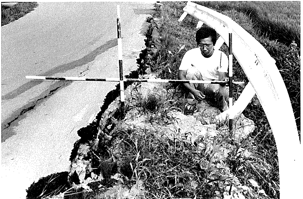
路面亀裂と路肩崩壊。一般県道 古川岩出山線（古川市川熊）
