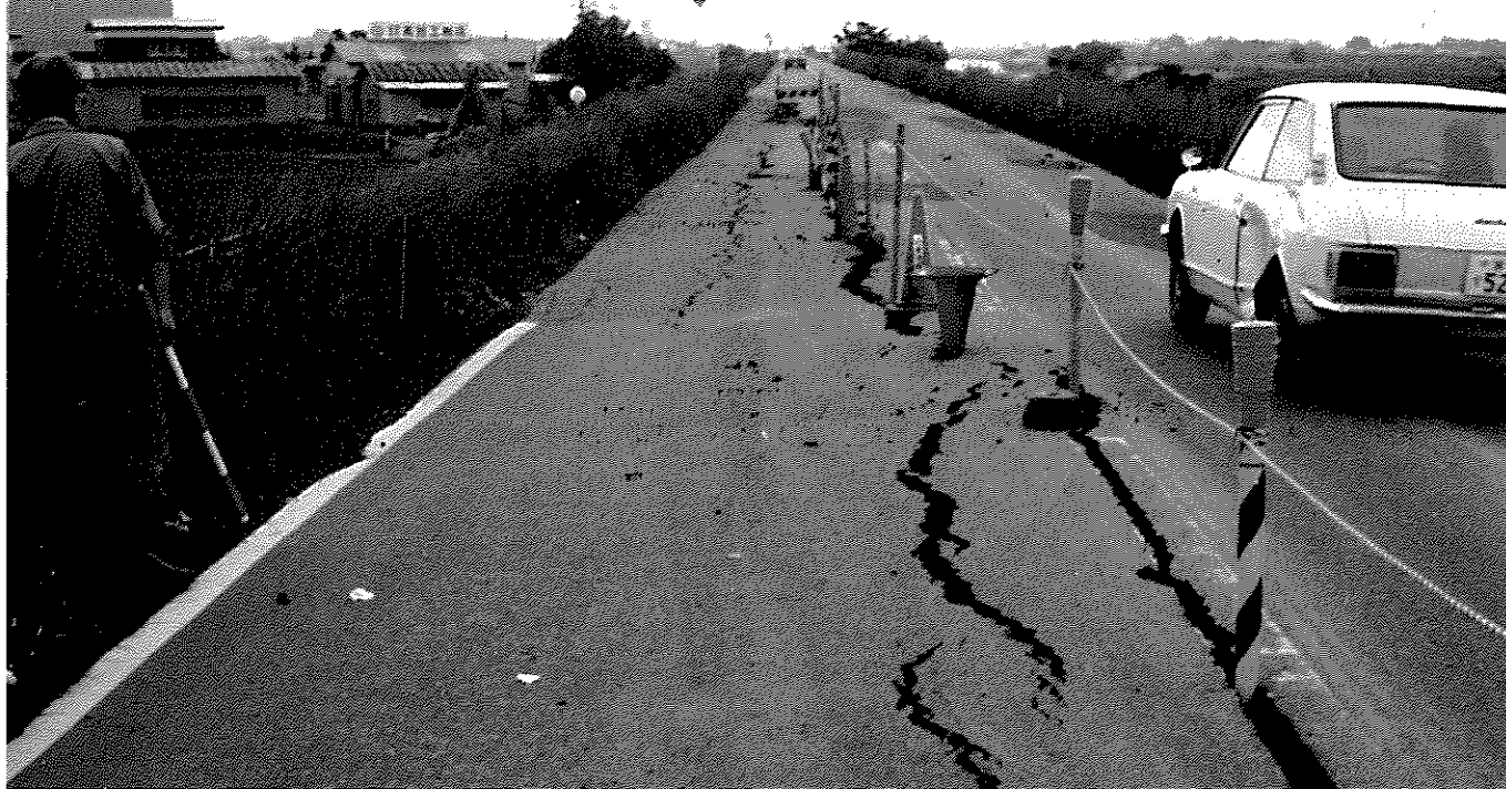
(七北田川左岸・仙台市向田) 縦断亀裂の入った県道との兼用堤防。
