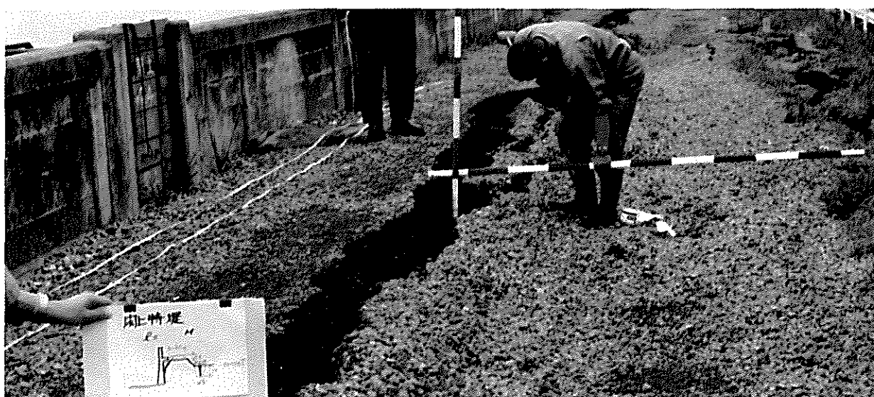
名取川河口部特殊堤、縦断方向に亀裂が入り、断差を生じている。（名取川右岸・名取市関上）
