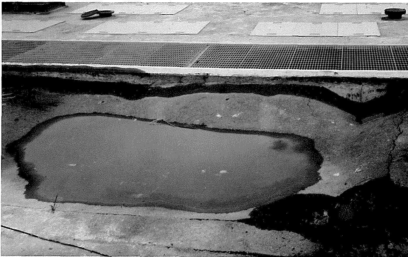
処理場内導水渠付近盛土、地盤沈下(仙台市南蒲生下水処理場)
