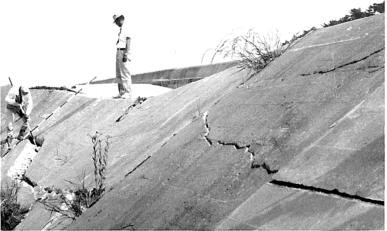
裏法面の亀裂と天端の沈下（東名海岸・鳴瀬町洲崎）
