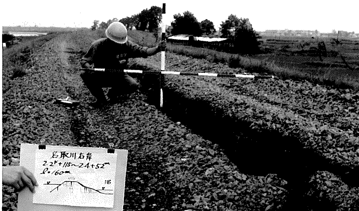
堤防天端の大きな亀裂（名取川右岸・名取市鍋沼）
