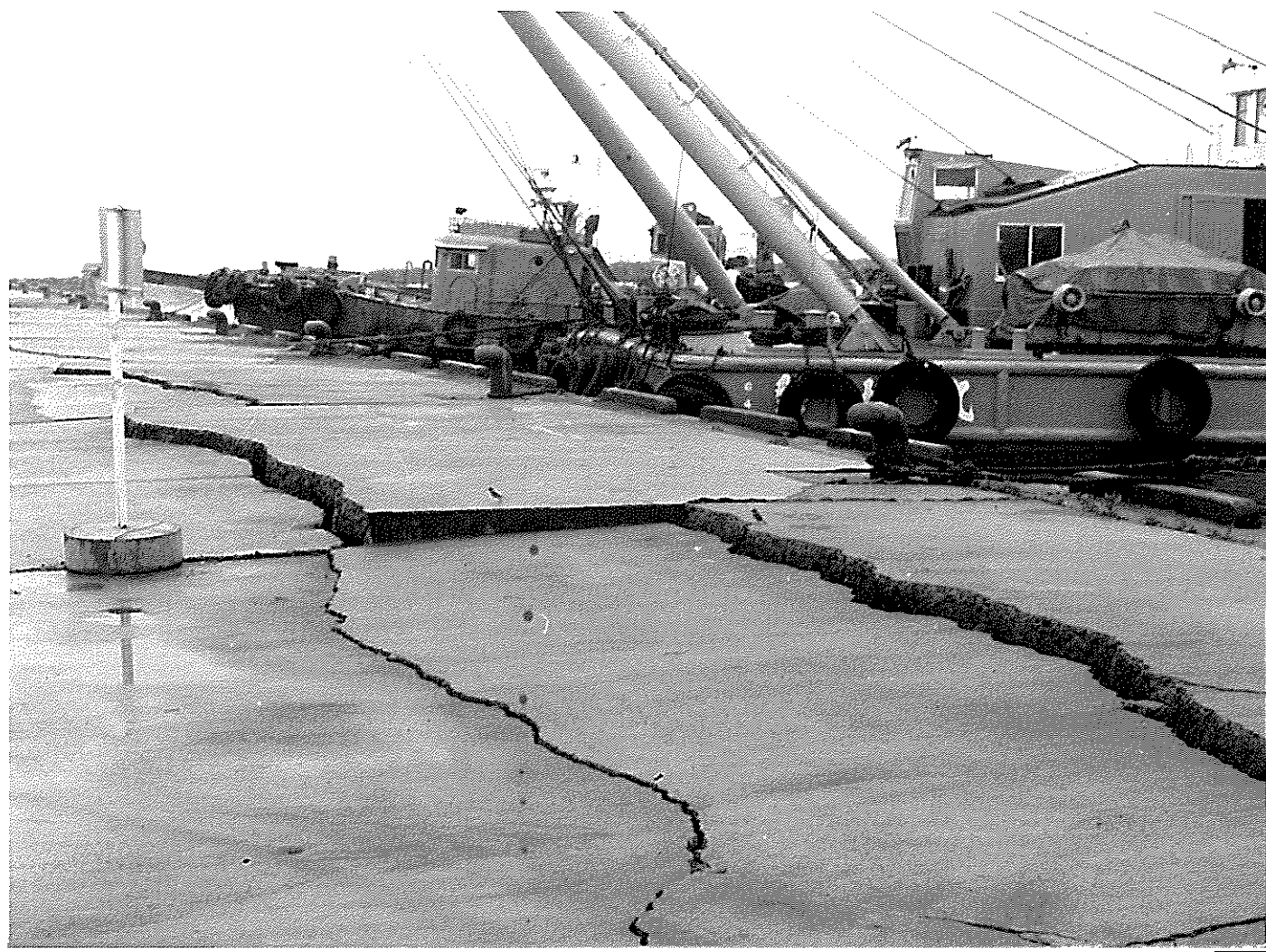
エプロンの沈下及び亀裂。岸壁（マイナス六、〇m）（塩釜漁港）
