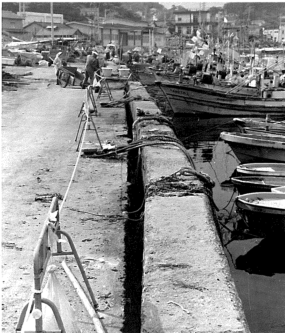
物揚場（マイナス一、五m）の堤体が前傾し、エプロンが沈下した。 （重要港湾塩釜港 吉田花淵地区）
