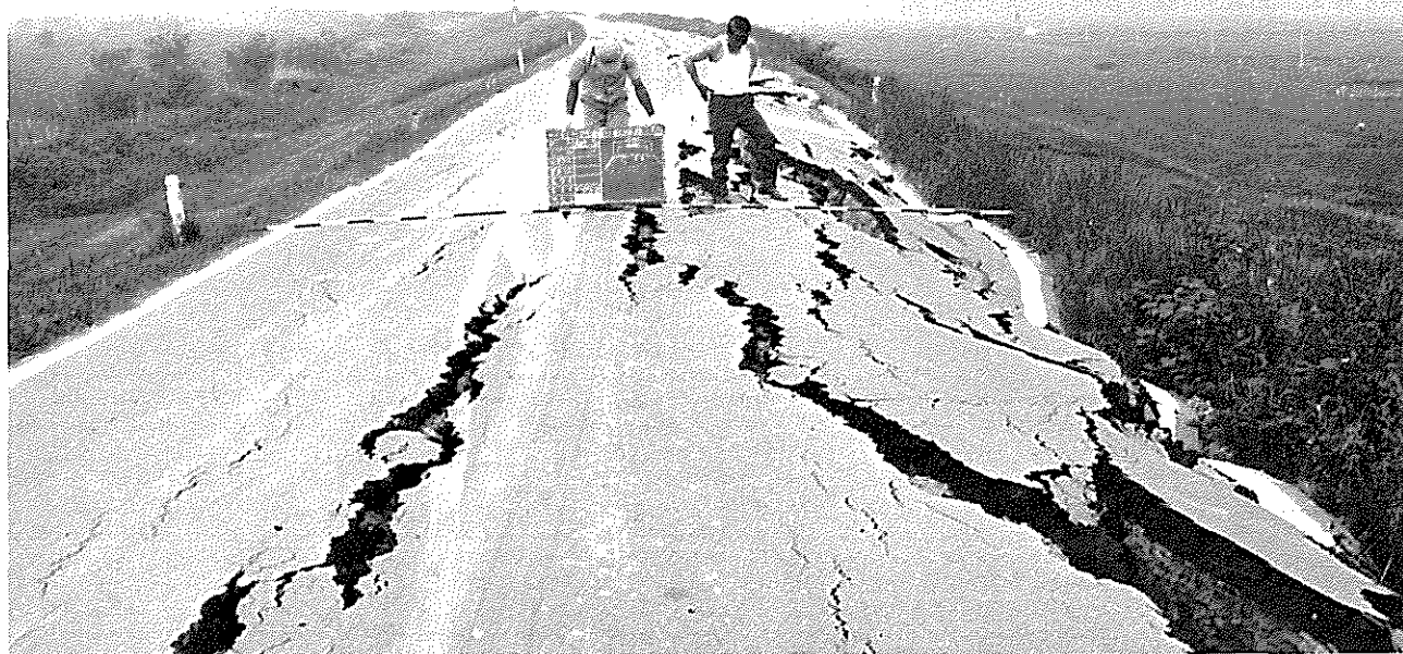
道路全面の亀裂と沈下、崩壊、北上川左岸の兼用堤。 一般県道・北上河北線（河北町牧野巣）
