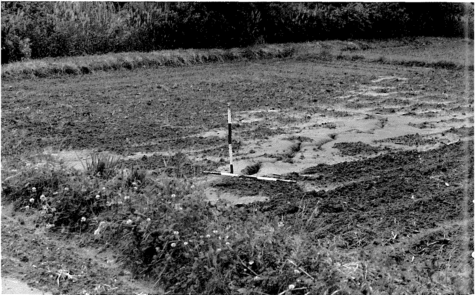
堤内地の噴砂現象（迫川右岸 志波姫町三丁目）
