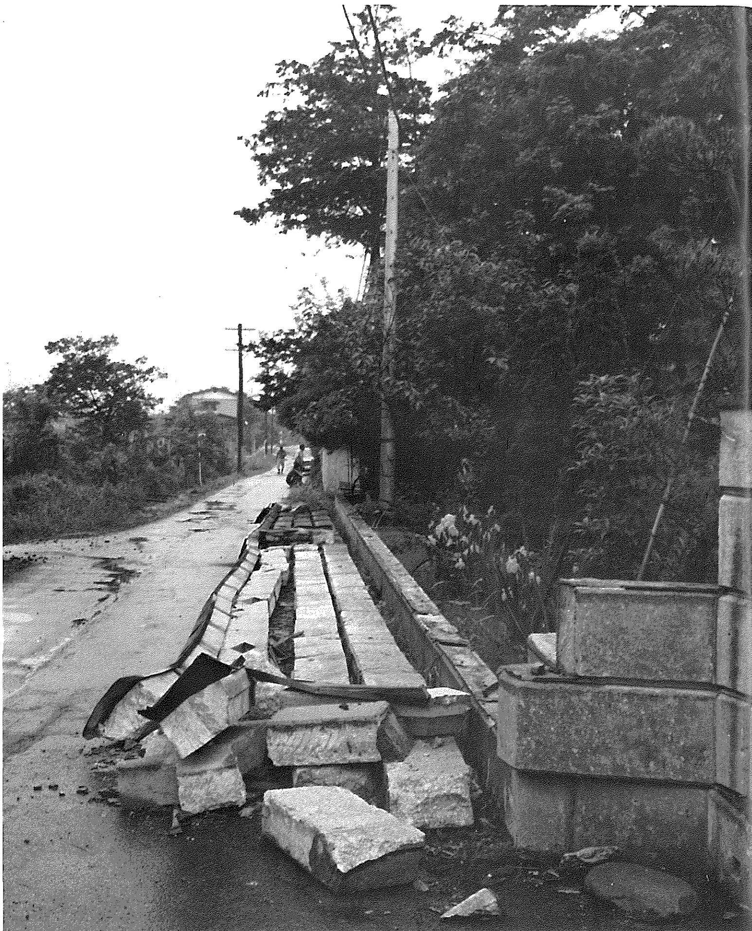
県内各地で門柱やブロック 塀が倒れ、いたましい犠牲者を出した。
