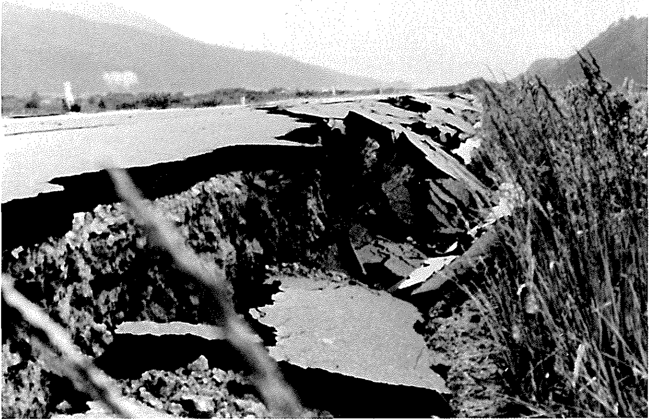
天端法肩の崩壊（北上川左岸・橋浦堤防）
