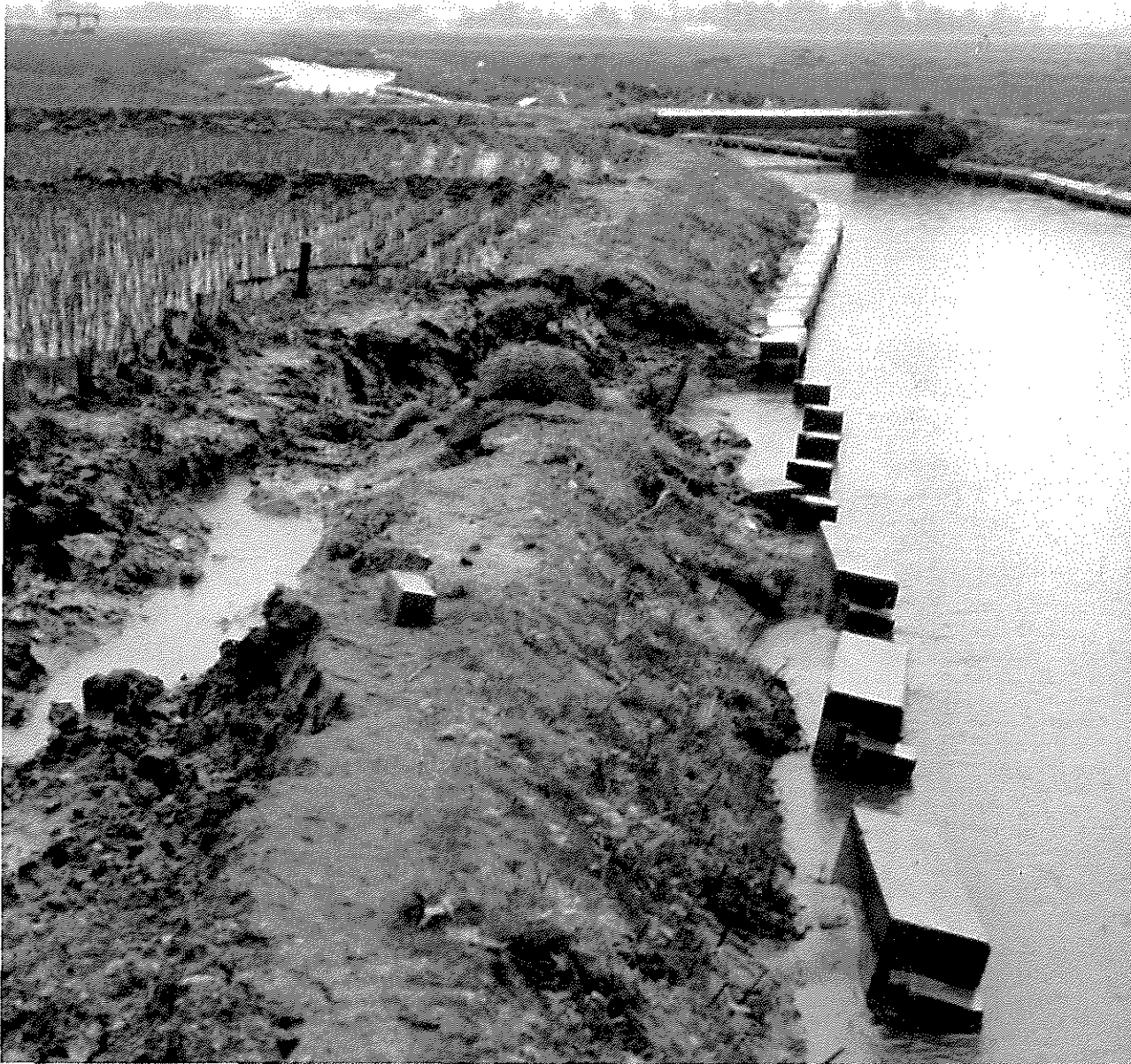
出来川のコンクリート板柵工護岸が延べ一五〇〇mにわたって傾倒した。(古川市桑針)
