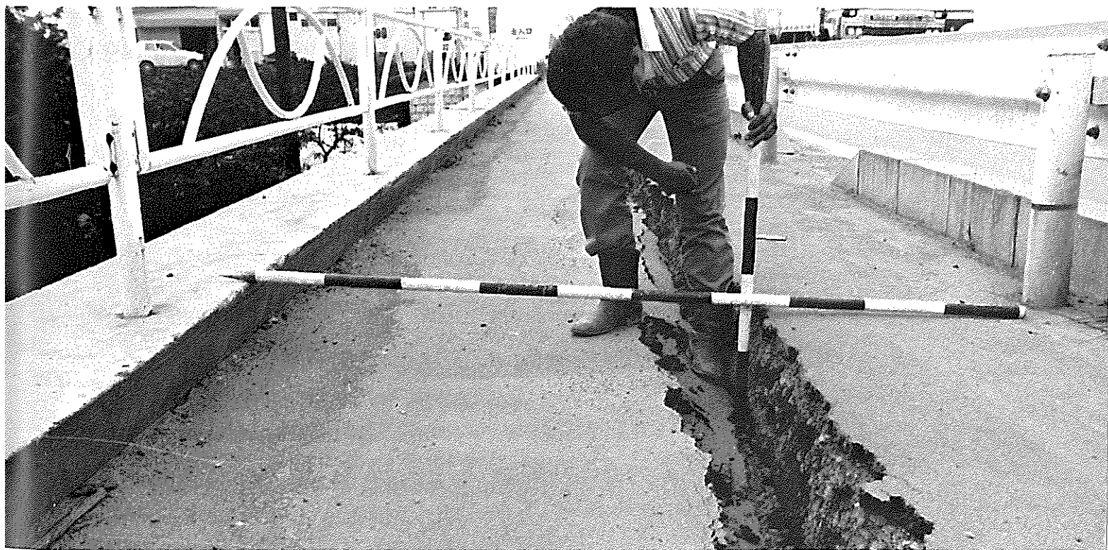
歩道の亀裂と沈下。主要地方道・塩釜吉岡線(大和町落合)
