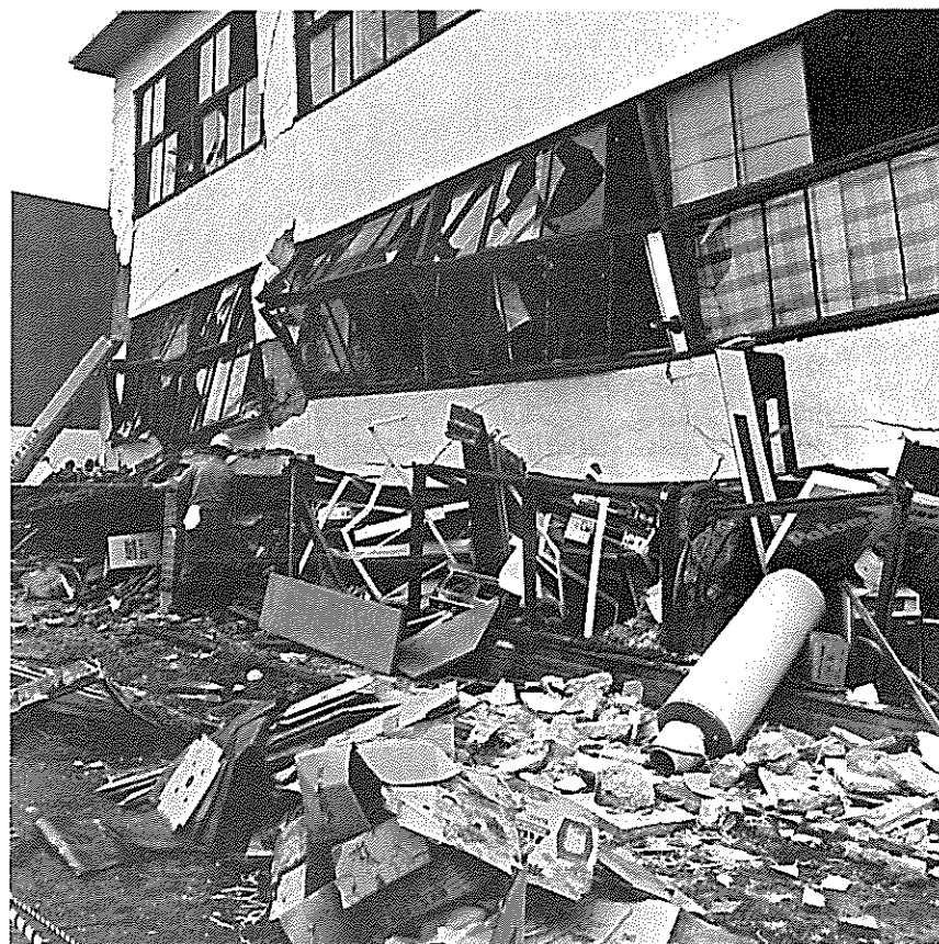
1階が壊れ、中の品物があふれ出たビル。
