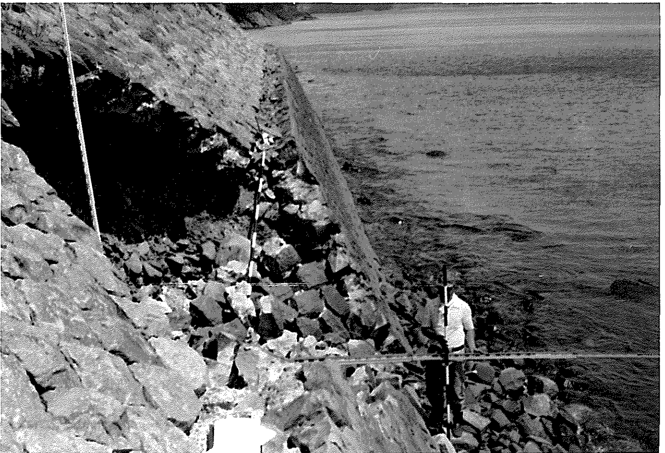
石積護岸の欠壊（黒崎海岸・志津川町黒崎）
