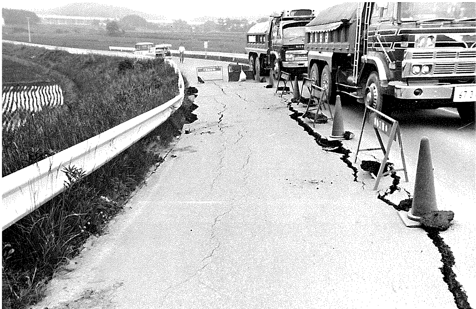
路体が沈下、すべりを起こし舗装に亀裂が入る。主要地方道・大和松島線（大和町大平）
