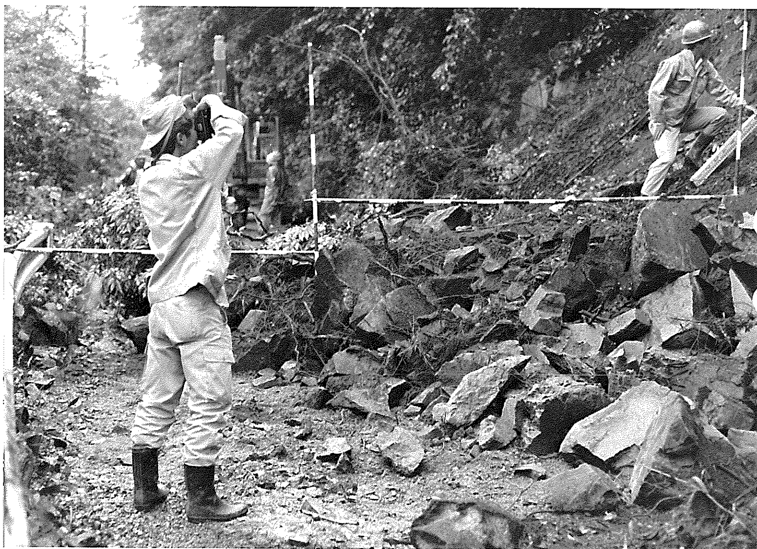
路面全巾の崩土。直ちに応急復旧にかかる。 一般県道・薄衣東和線（東和町二良根）
