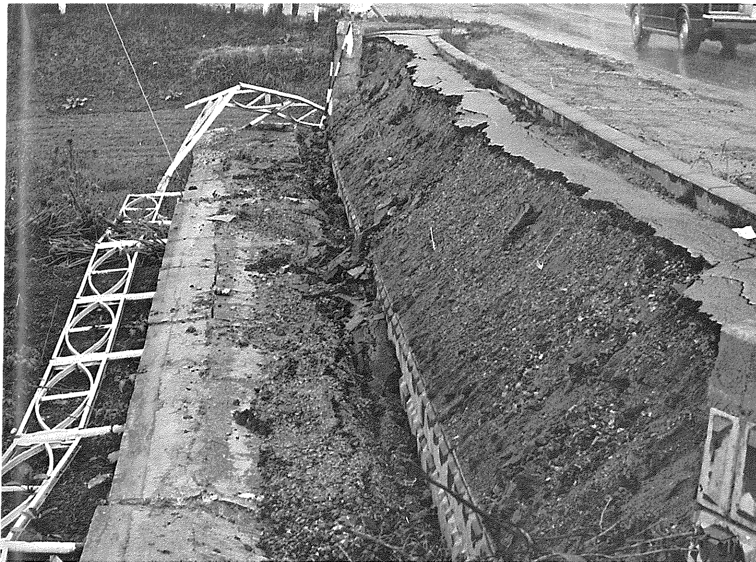
路側擁壁(ブロック積)の倒壊による歩道被災。主要地方道・古川登米線(迫町天形)
