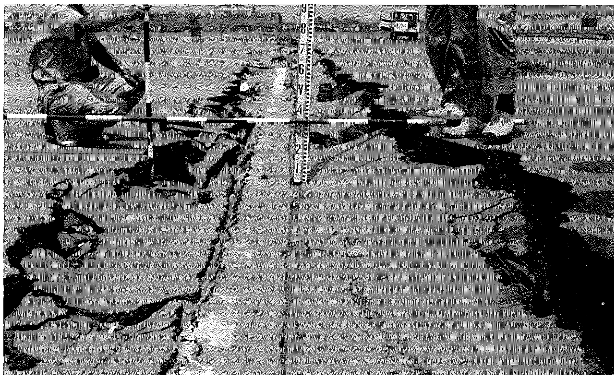
中島埠頭岸壁(マイナス一〇、〇m)背後。堤体前傾によりエプロン、荷捌地が沈下。(重要港湾・石巻港)
