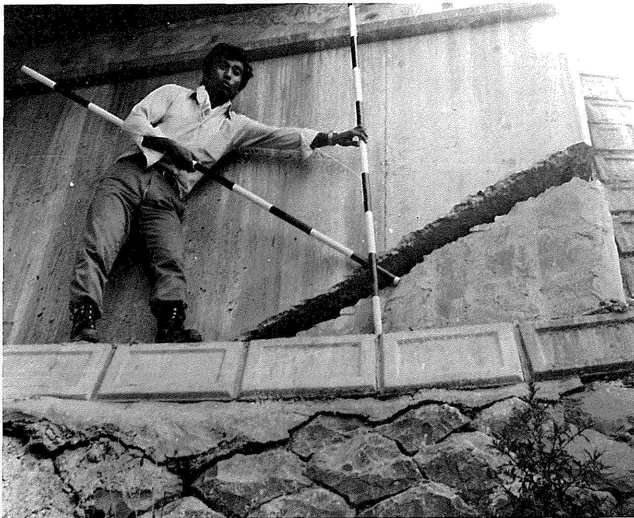
品井沼大橋。左岸橋台袖コンクリートの破損。国道三四六号（松島町幡谷）
