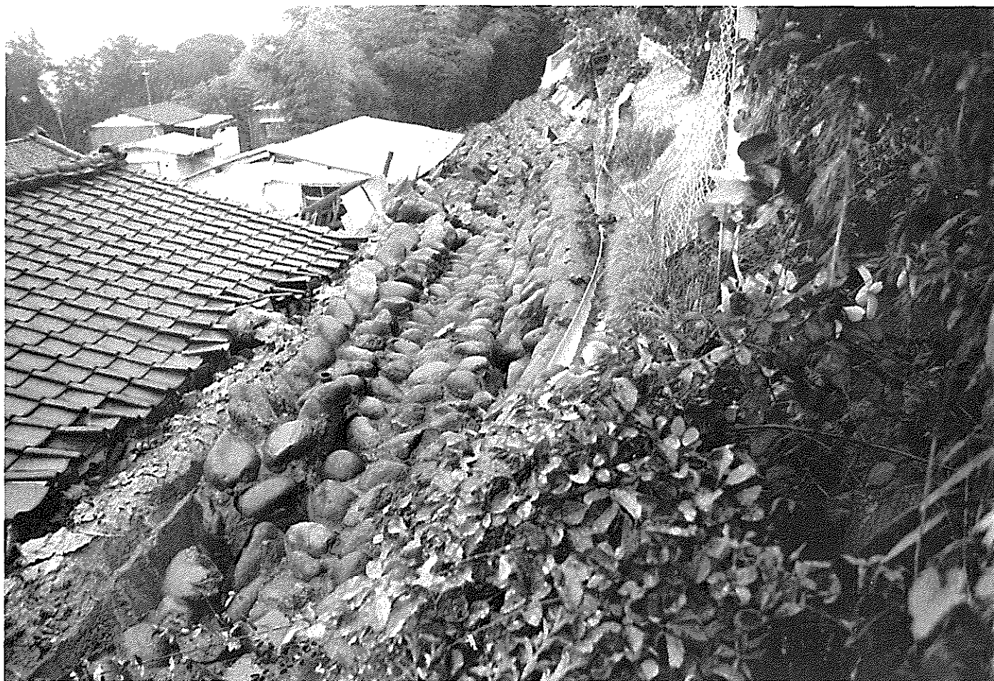
盛土部に築造された玉石積が地すべり性の滑動により崩壊し、 下方の住宅に押し出された。(仙台市緑ヶ丘一丁目)
