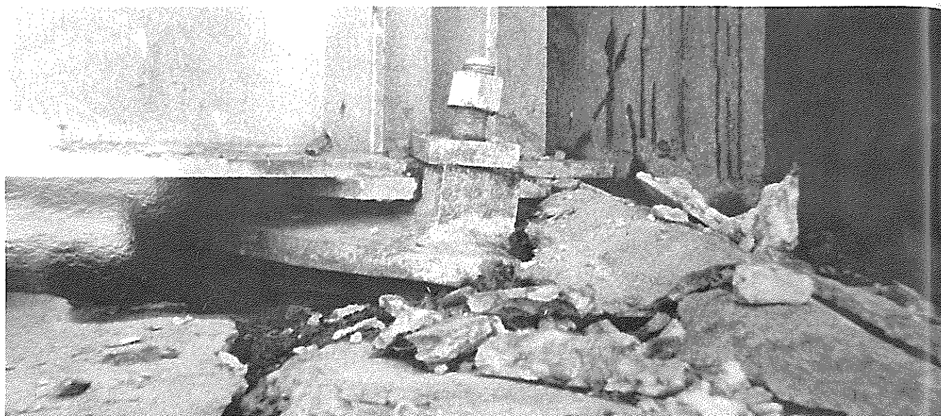
錦桜橋。右岸橋台の沓座コンクリート破壊及びアンカーボルトの抜け出し状況。
