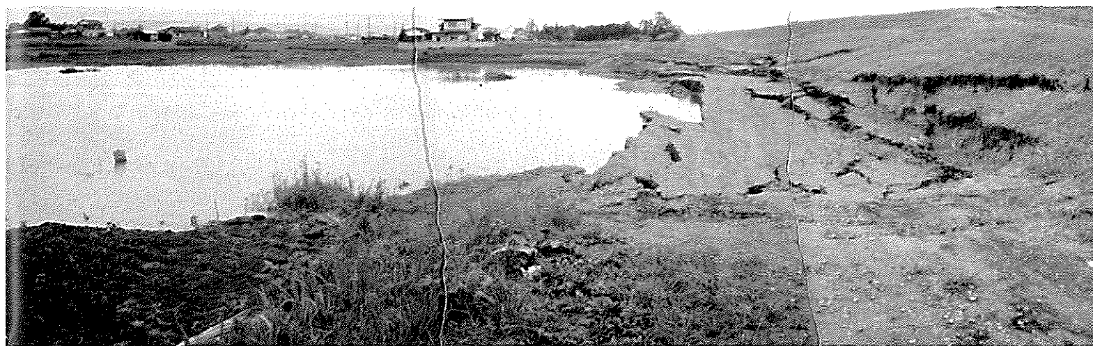
堤防裏法面のすべりによる亀裂。この箇所は過去に破堤した所（名取川右岸・名取市鍋沼） 〔以下直轄河川の写真は、東北地建の提供〕
