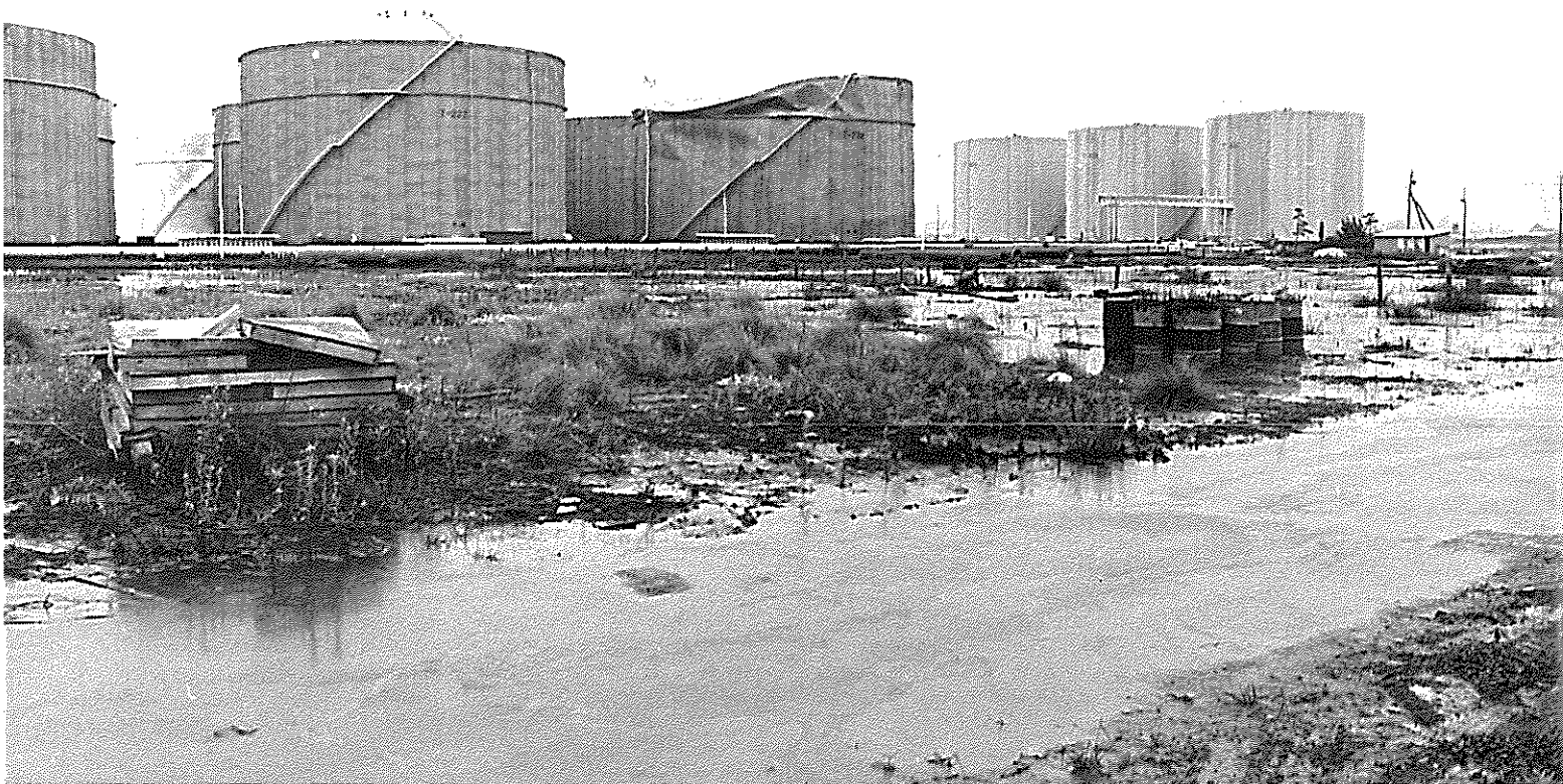
亀裂の入った東北石油のタンク。流出した重油が流出した。(仙台港)
