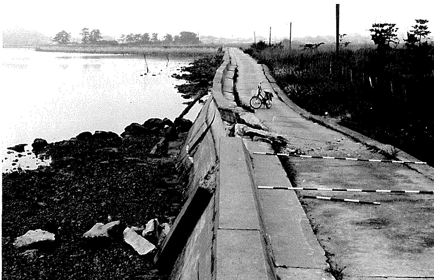
パラペットがせり出し、天端が沈下している。（東名海岸・鳴瀬町洲崎）
