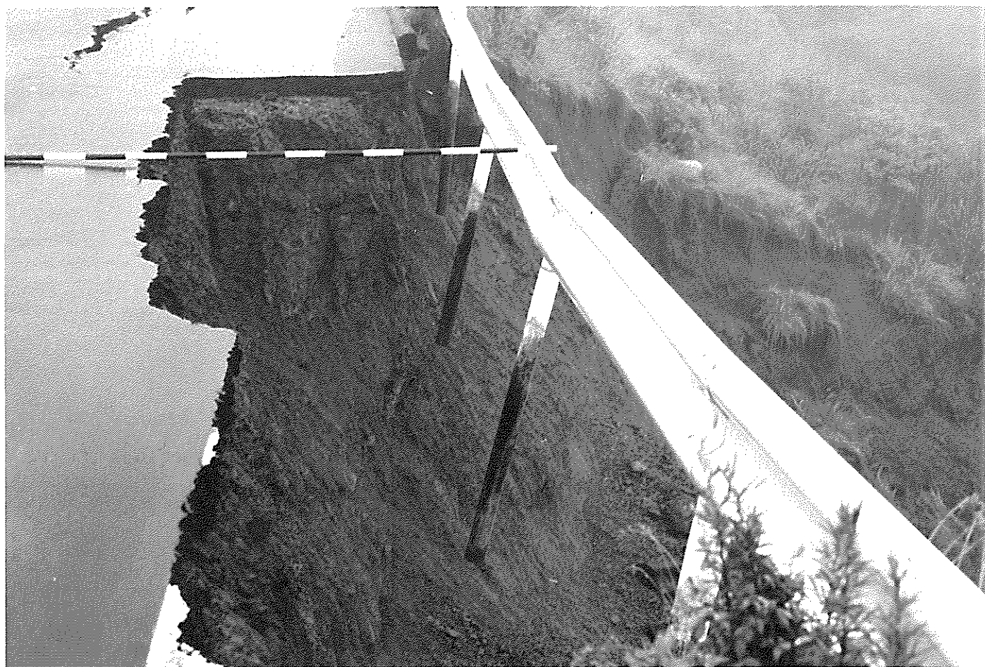
路肩及び法面のすべり崩壊。一般県道・牡鹿半島公園線（女川町小乗）
