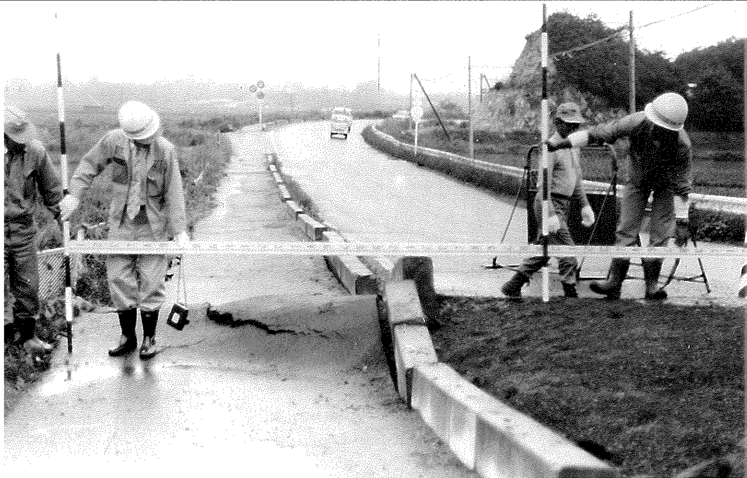
隆起、沈下により波打つ道路。主要地方道・奥松島松島公園線（松島町北の窪）
