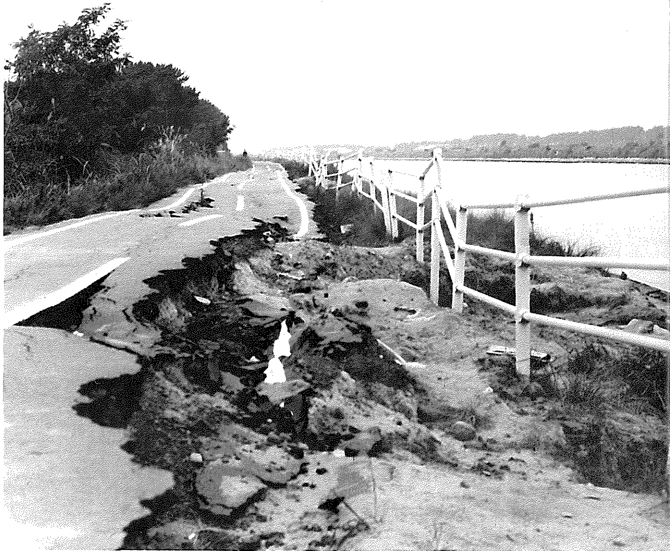
亀裂と沈下、崩壊が連続した道路。一般県道・仙台亘理自転車道（仙台市井上）
