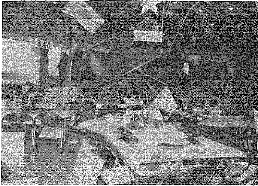
写真 2-6 三石町福祉センター大ホールの天井落下
