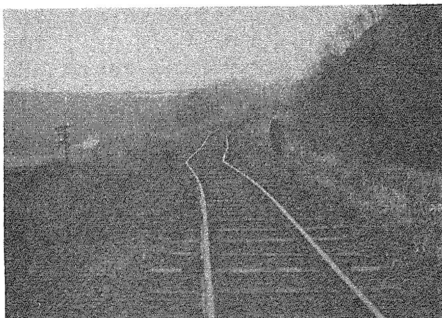
写真 2 - 5 国鉄日高本線(荻伏～絵笛間)の盛土沈下
