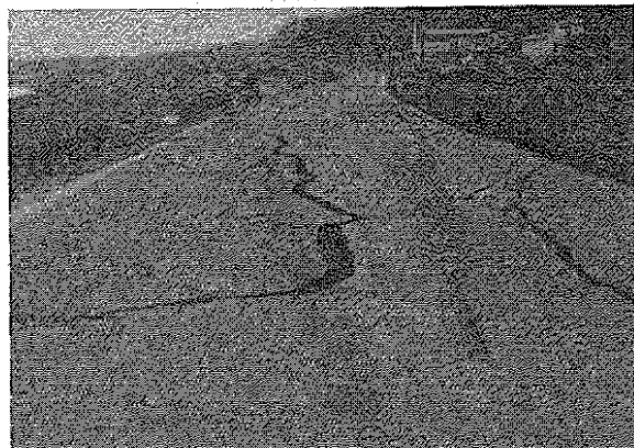
写真2-2 一般国道235号の路面クラック (三石町西端)
