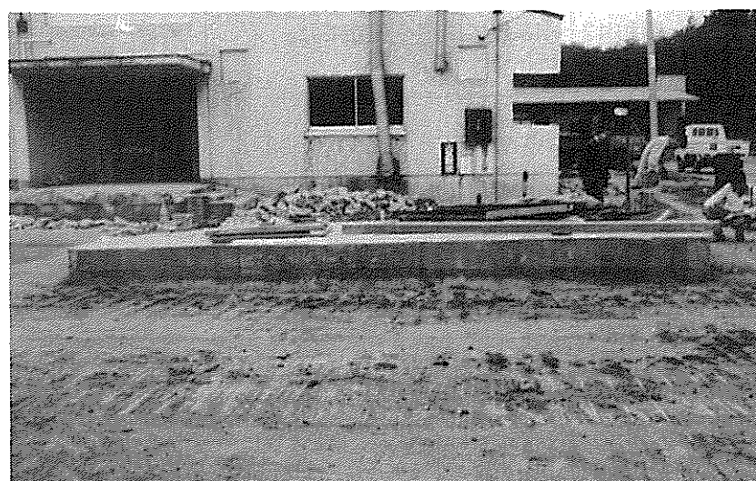
地下オイルタンクの浮上り
