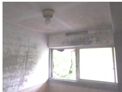
写真1 浴室の状況①
