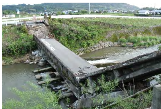
写真4 崩落した橋梁（福原地区）
