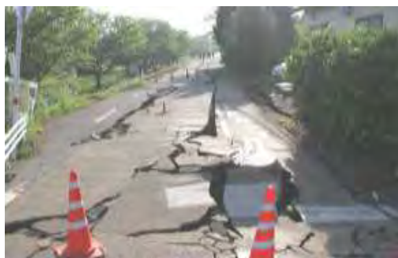
写真3 被災した道路（宮園地区）
