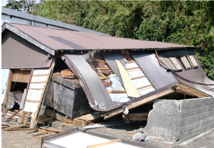
図 1 倒壊した非住家
