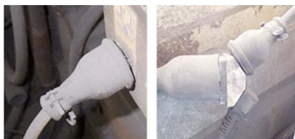
写真21 清掃不足での接続（左）
