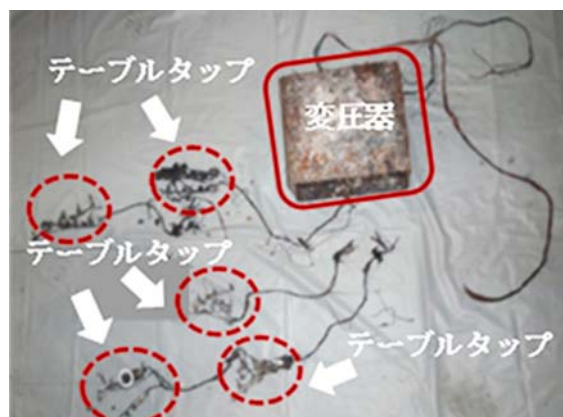
写真14 変圧器から2次側の配線状況
