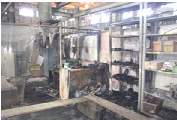
写真1 建物内の焼損状況
