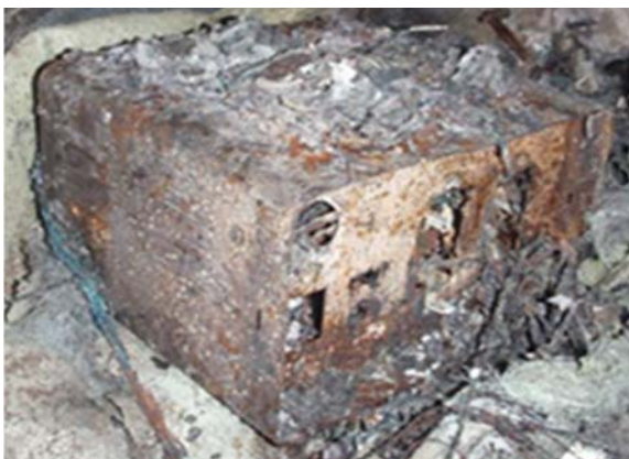
写真18 変圧器（焼損品）
