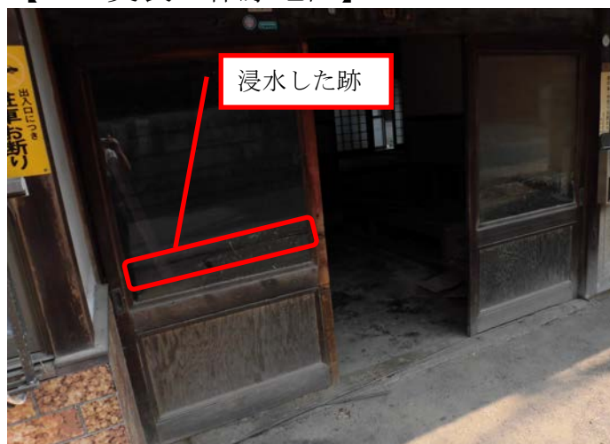
浸水した民家の玄関
