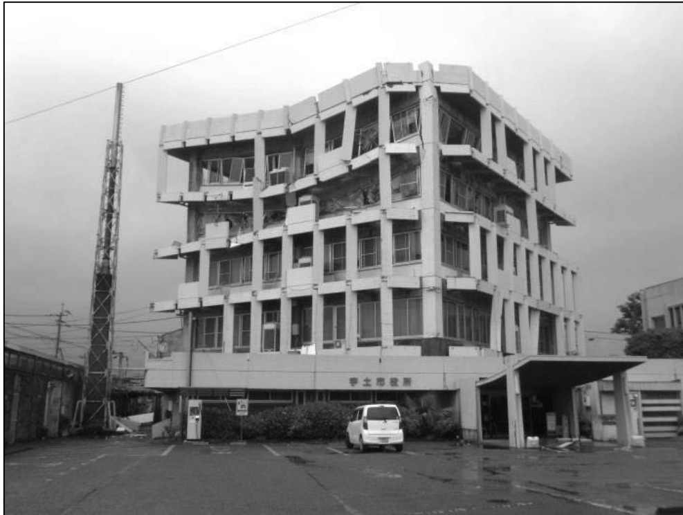
写真1 被災した宇土市役所本庁舎（平成28年5月9日撮影）
