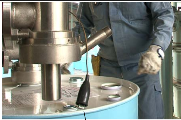
アースの不完全な接続状況
