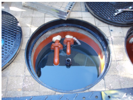
マンホール内に重油が滞留した状況
