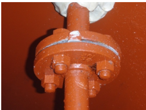
返油管フランジ部に仕切板が設置された状況
