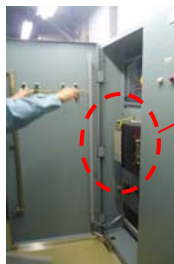
照明用電源の切替盤
