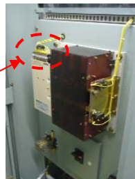
切替盤内の切替器
