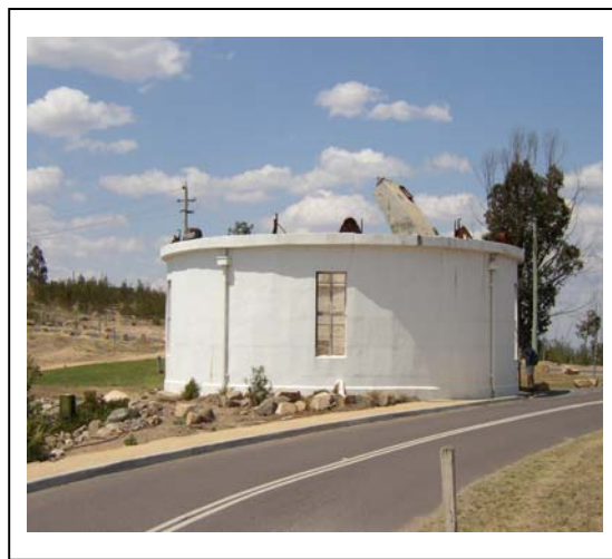
火災により焼損した天文台
