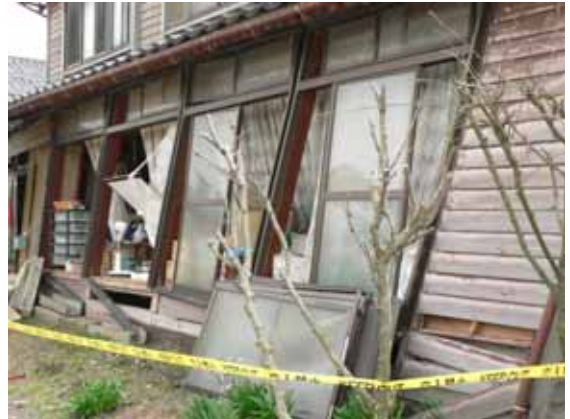
集落の被害状況 2
