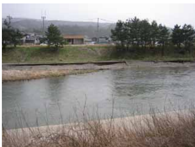
堤防被害状況
