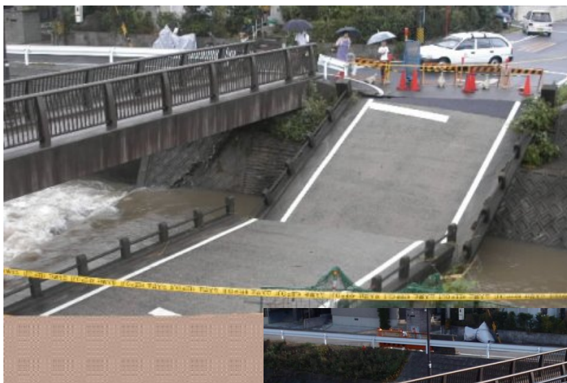
写真 10.6.1 竜泉寺川 にかかる三河橋の落橋
