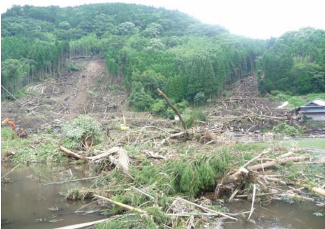
崖崩れの痕跡と復旧作業中のバックホウ
