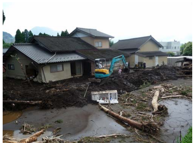
崩れた土砂が堆積した住家と復旧作業の様子 (手前の倒れた冷蔵庫には生鮮食品があった)
