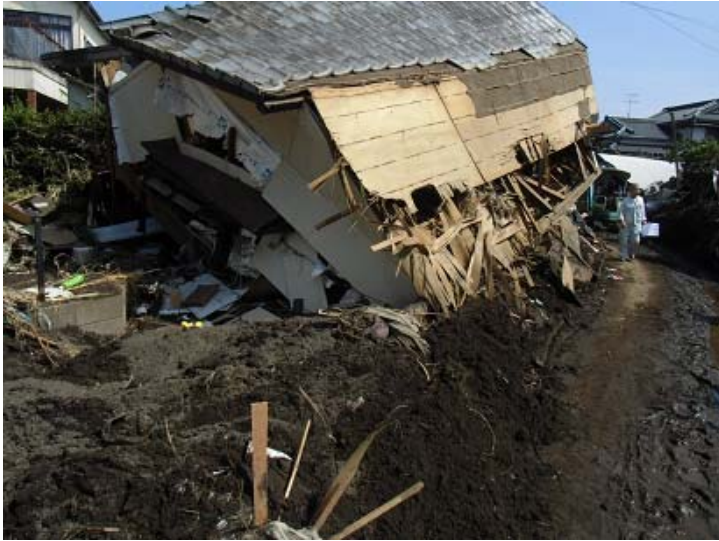
倒壊した住家
