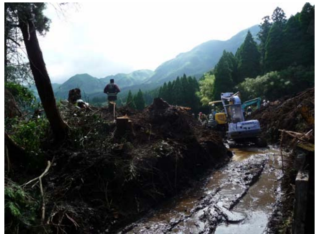
崖崩れ現場の活動(上から見た様子)
