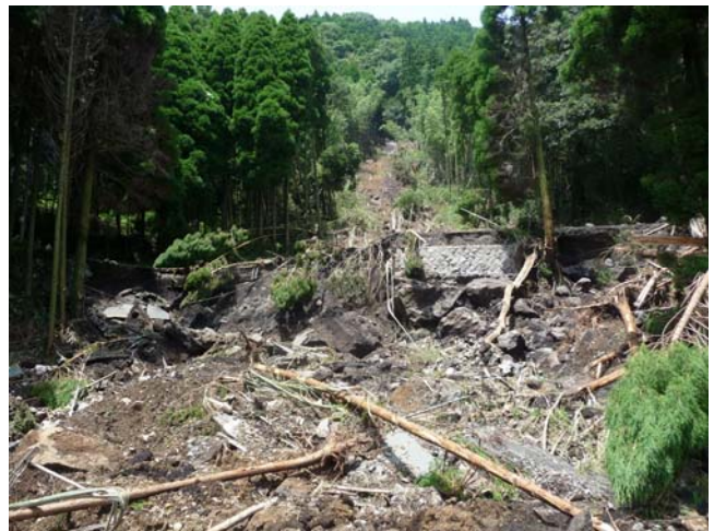
崖崩れにより崩落した県道 11 号線の道路
