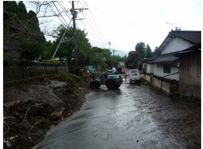
道路に溜まった土砂を片付けている様子
