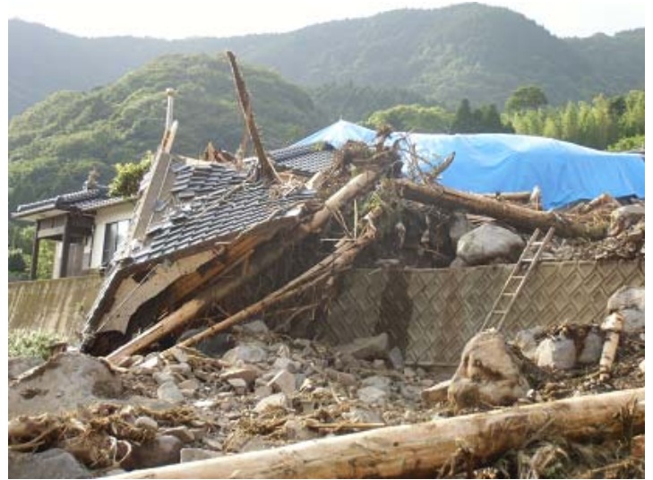
土砂崩れで破壊された住家
