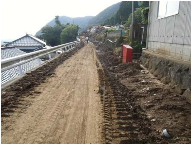
被害現場付近の道路(山肌の中腹付近)
