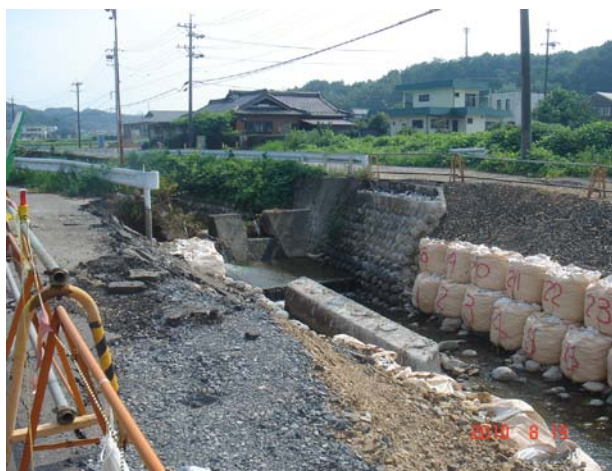
○矢戸橋の落橋箇所
