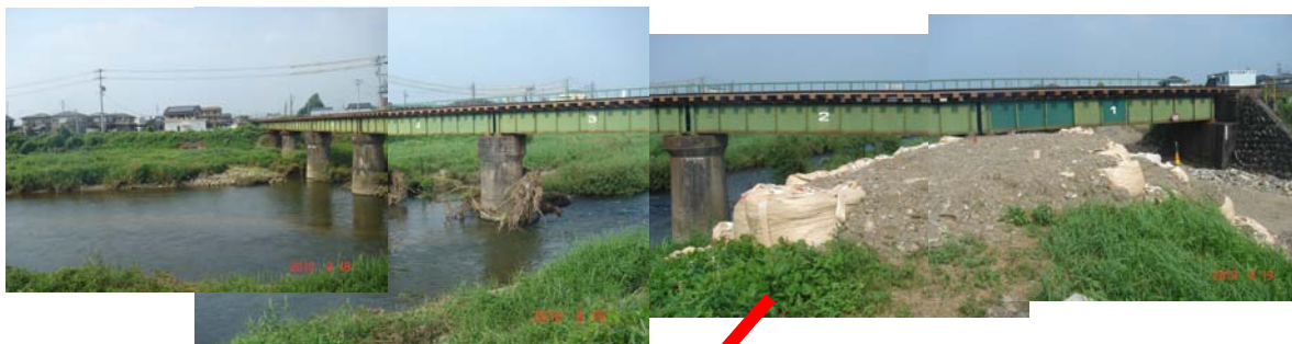
○堤防決壊箇所 可児川に架かる J R 太多線の高架橋
