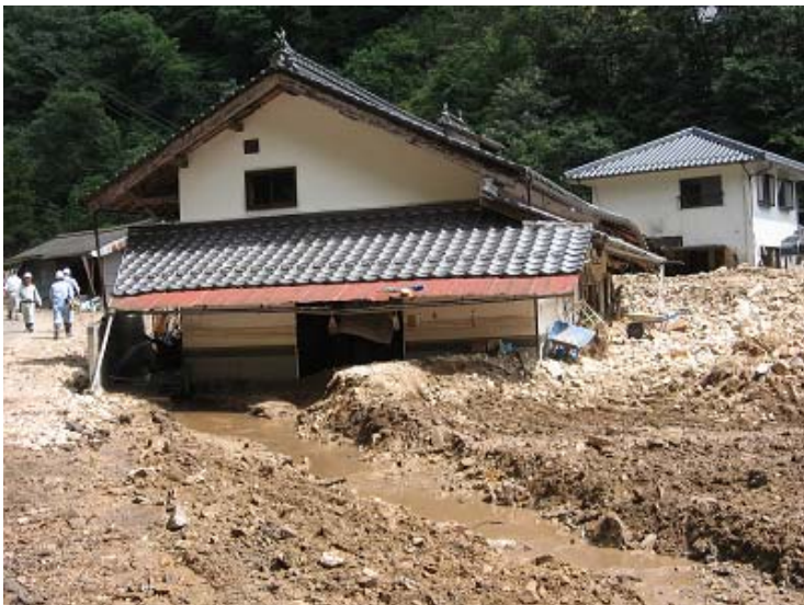
土砂が流入した住宅
