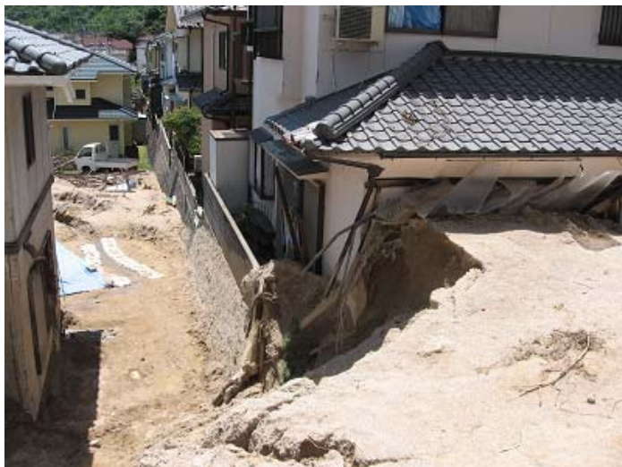
住宅に流入した土砂
