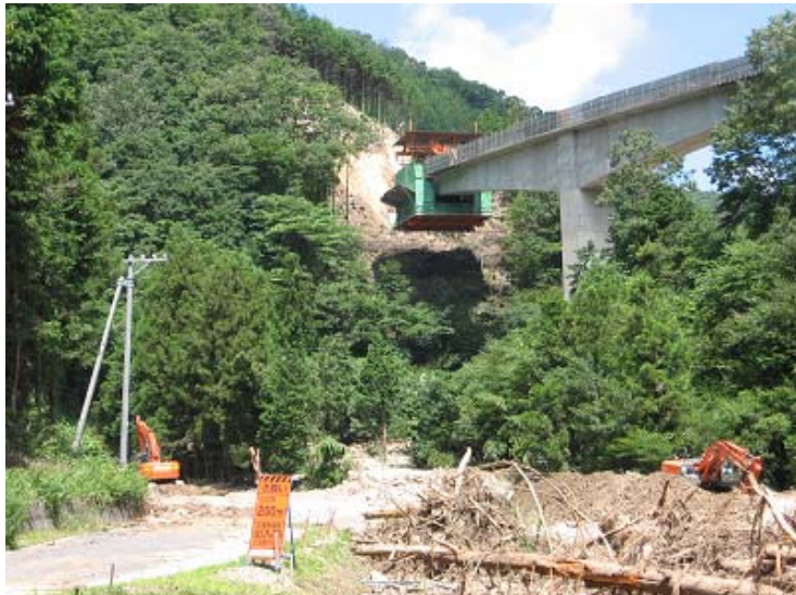
土砂災害現場(被害現場から山側を撮影)
