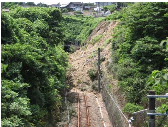
呉線内土砂崩れ(吉名駅～安芸津駅間)
