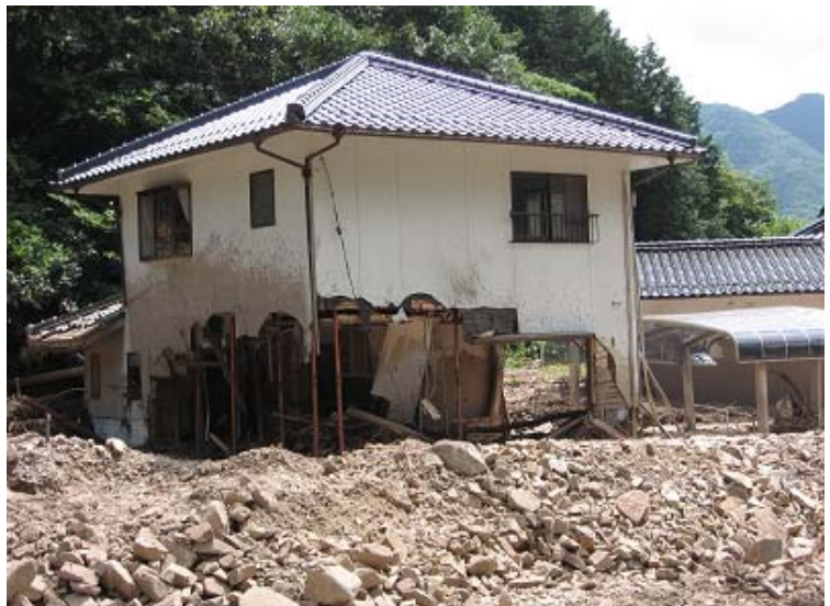
土石流により壊れた住宅
