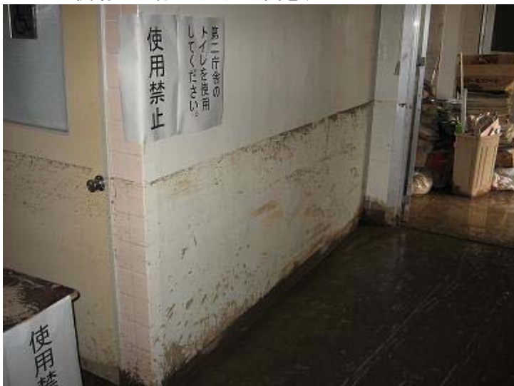
役場内の様子(1階トイレ付近、壁の汚れは浸水した跡)
