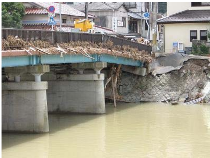
佐用大橋が一部崩落した様子
