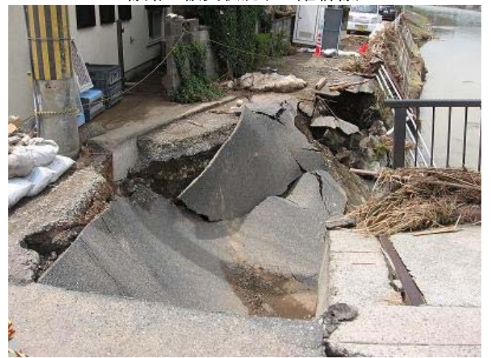
崩落現場の様子
