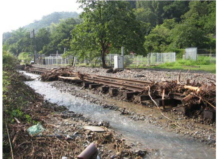
線路の被災状況(JR 姫新線)
