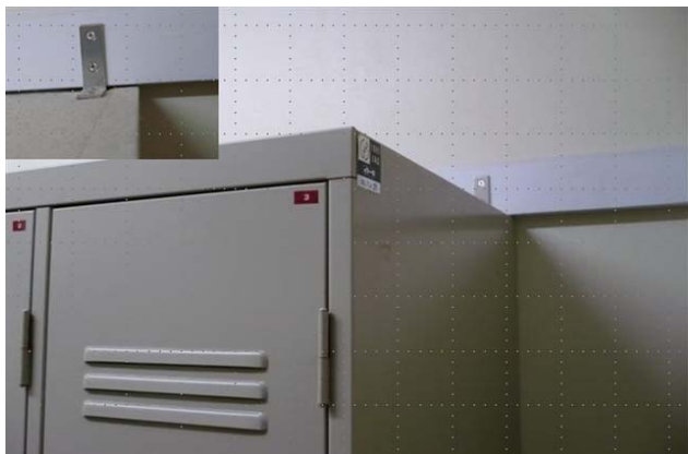
固定された職員用ロッカー (牧之原市相良庁舎)
