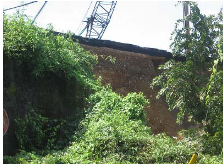
東名高速牧之原 SA 付近の崩落現場(拡大)
