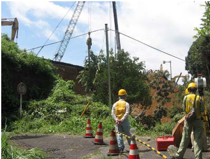
東名高速牧之原 SA 付近の崩落現場
