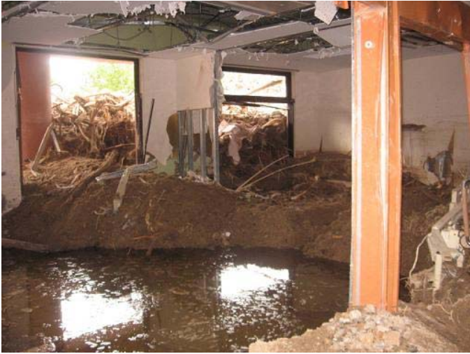
土砂が流入した部屋内部の様子
