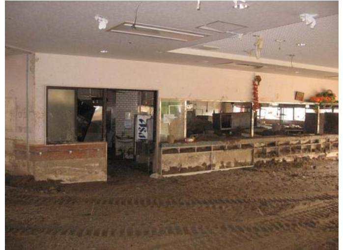
土砂が流入した食堂内部の様子(1階玄関ホール横)
