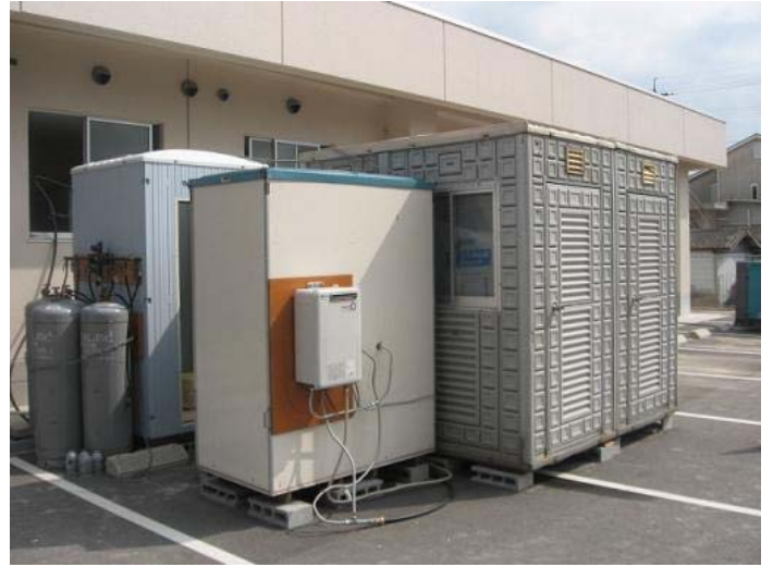
仮設シャワー室
