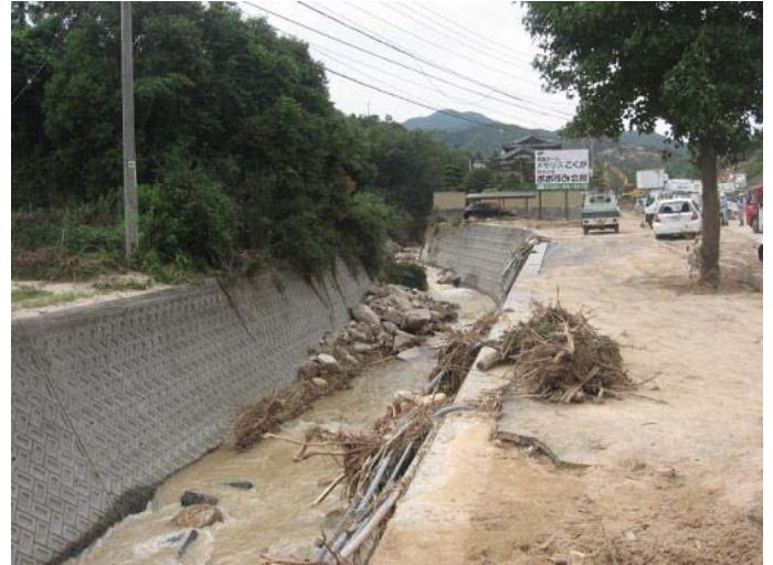
土砂によってガードレールが曲がった様子
