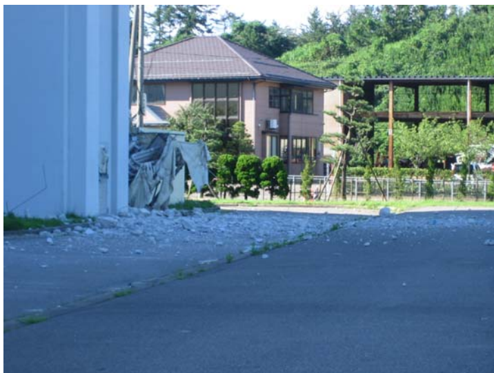
煙突下にはコンクリート塊が散乱していた。
