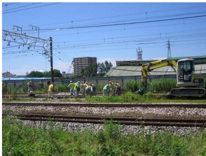
柏崎駅付近では、列車の脱線や線路が歪む被害があったが、対応工事が行われていた。
