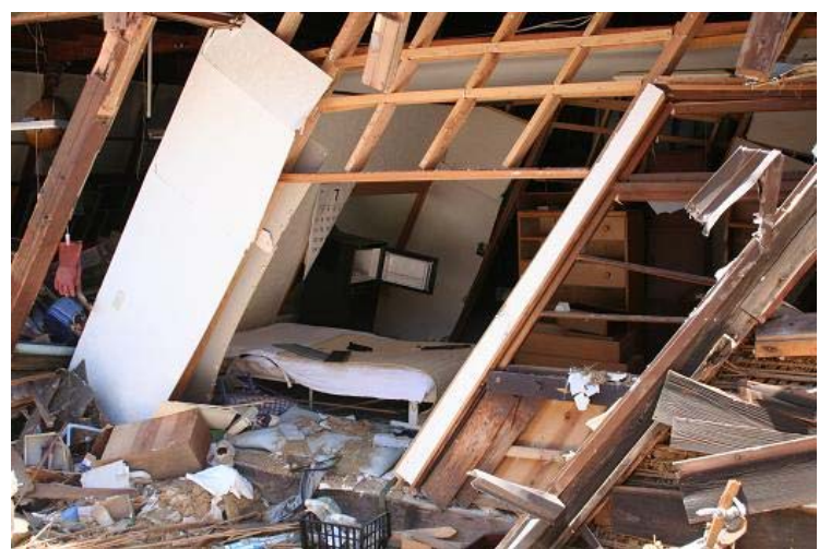
被災した家屋の様子（柏崎市西本町付近）
