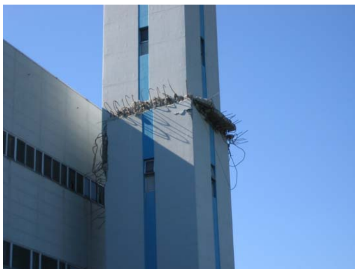
外観の被害として、煙突が途中で折れている。
