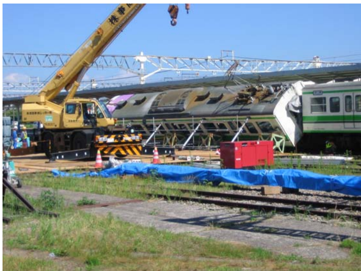
駅構内で脱線した車両の周りで作業が行われていた。
