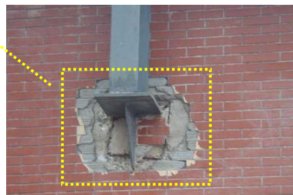
写真 1 5 一部損害箇所の様子
