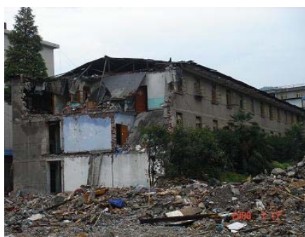
写真 2 2 3 階建ての宿舎とみられる建物の被害状況
