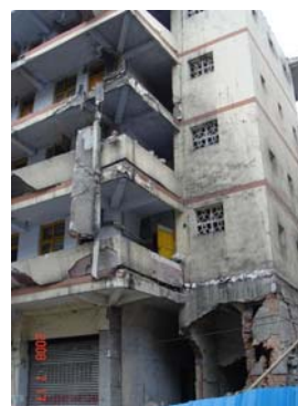
写真 2 3 の被害箇所拡大
