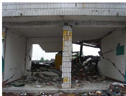
写真5 同左建物のレンガ壁の崩落、ひび割れ
