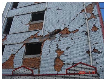
写真11 7階建て商業ビルの壁のひび割れ、仕上げ材の剥落
