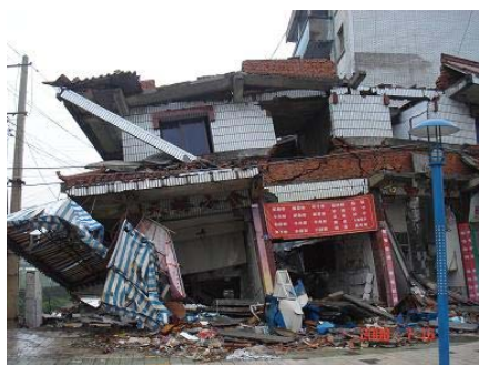
写真8 大きく傾斜した建物
