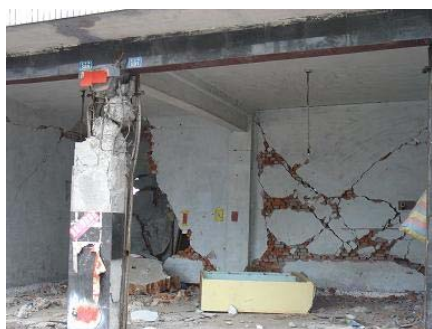
写真6 同上建物の柱頭部の被害
