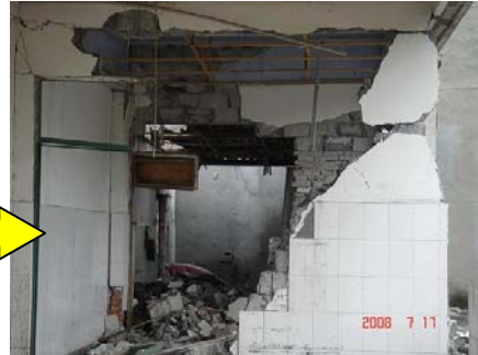
写真 3 5 建物内部の被害状況 (左側写真の拡大)
