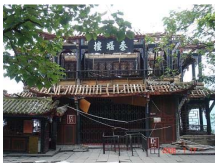
写真 28 都江堰の全貌を眺める 最適の場所「泰堰楼」の被害
