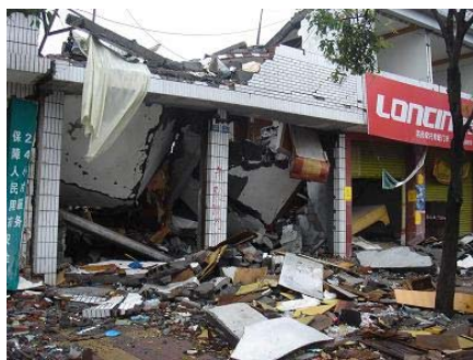
写真4 2階建ての建物の床スラブの落下(1階は道路に面した店舗であり、2階は住居とみられる)
