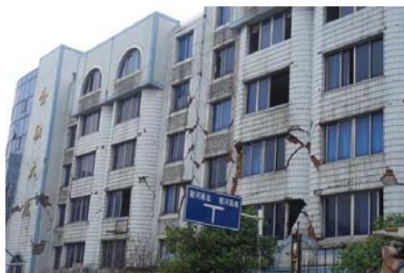
写真10 6階建ての金融ビルの壁のひび割れ
