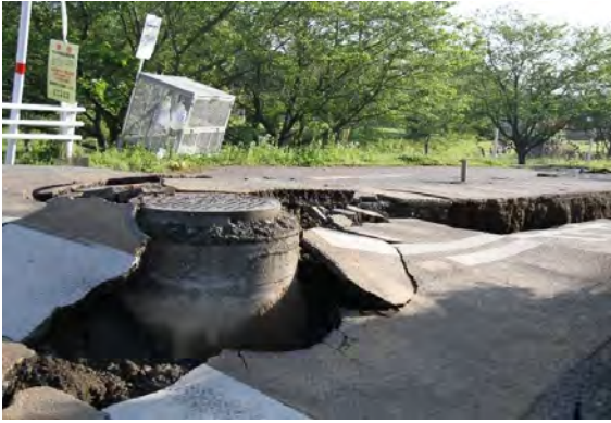
写真5 道路の液状化により 浮き上がったマンホール
