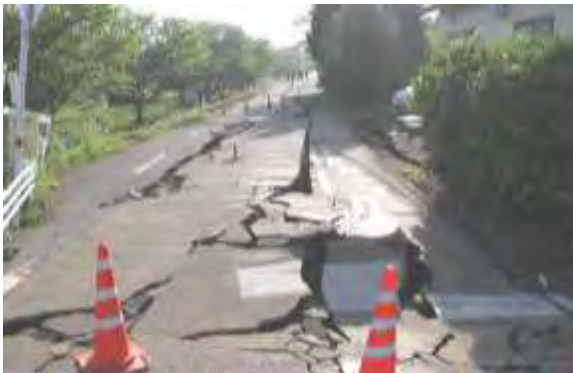
写真3 被災した道路（宮園地区）
