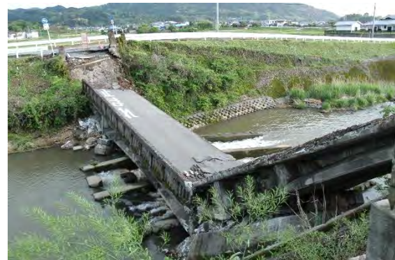
写真4 崩落した橋梁（福原地区）
