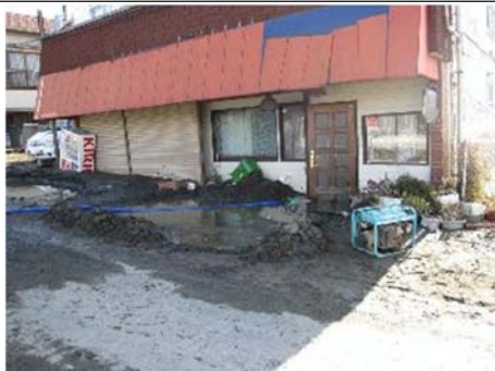
建物への被害 (千葉県我孫子市)
